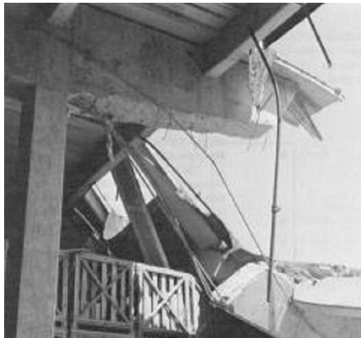
Şekil 1. 1955 yılında Wilkins hava kuvvetlerine ait bir ambar binasındaki kısmi göçme
