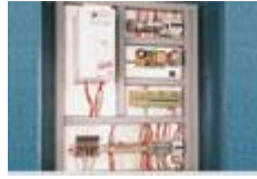
Şekil 4.7. Yıkama makinasındaki hız kontrol sistemi
