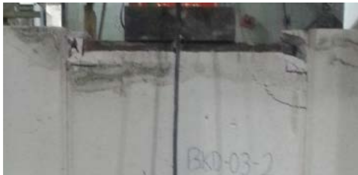
Şekil 4.37: Deney sonrası oluşan ezilme ve çatlaklar.
