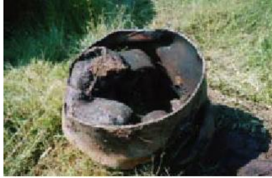
Şekil 2.17 Çelik su borusunun burkulması (AIJ, JSCE ve JGS, 2001)
