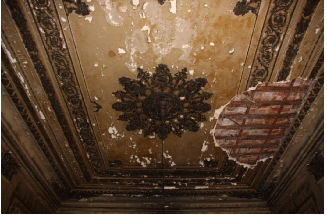
Şekil 4.15 : Tavanlarda bulunan alçı işlemlerde kirlilik, rutubet ve sıva dökülmeleri.
