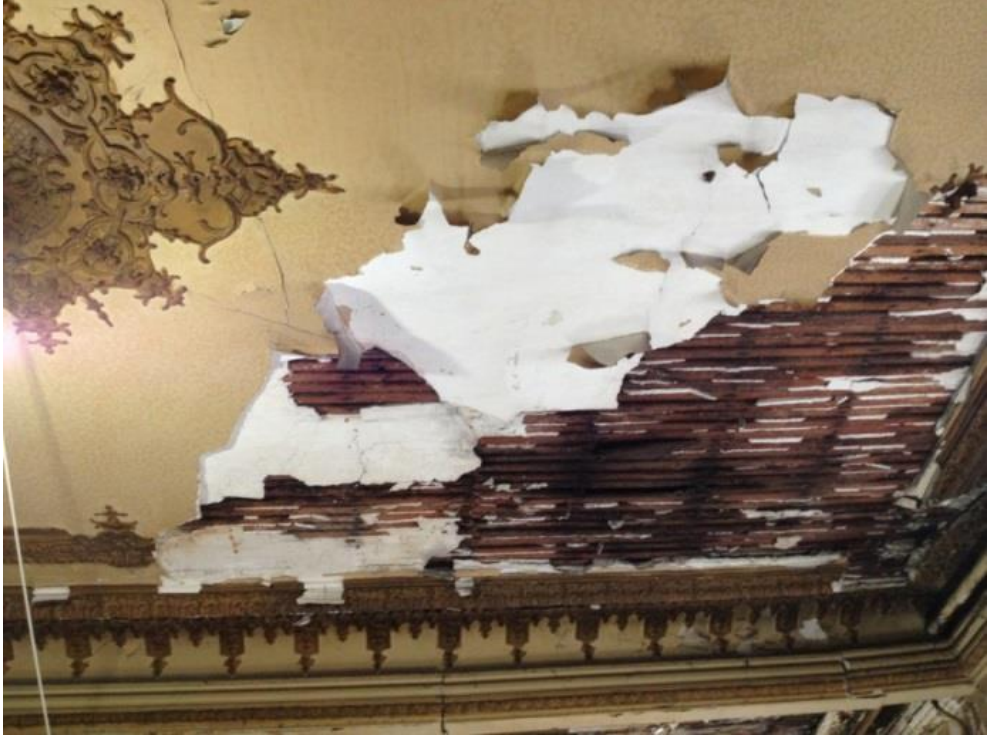
Şekil 4.18 : Tavanlarda sıva dökülmeleri ve ahşap çıtalarda oluşan tahribatlar.
