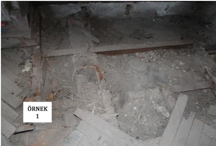
Şekil 4.25 : Döşeme örneğinin yakından görünüşü (sağda) ve yapıdan alındığı yer (solda).
