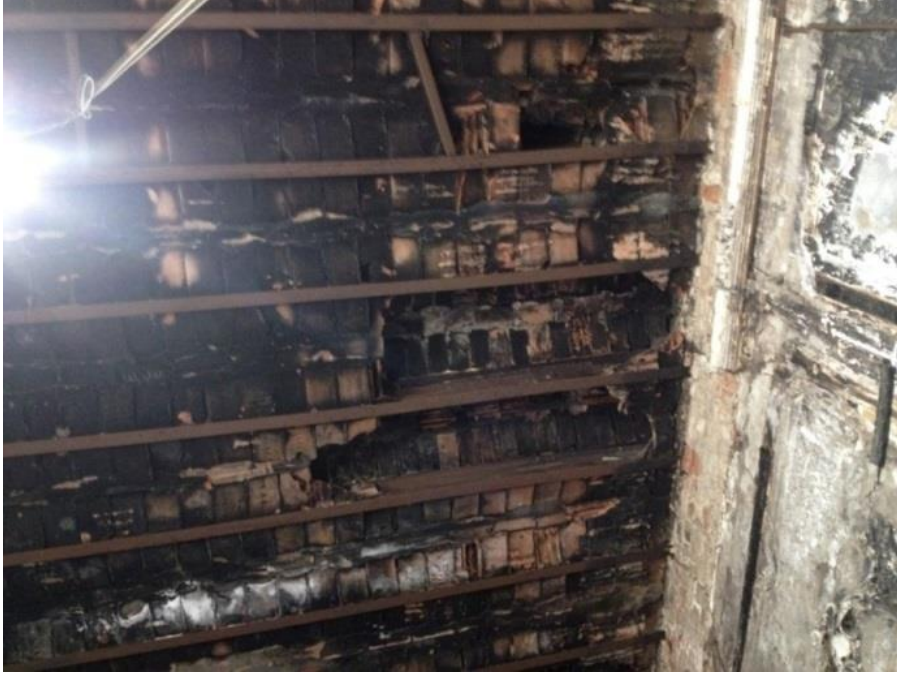
Şekil 4.17 : İç mekan volta döşemelerde kötü kullanım ve yangın sonucu oluşan tahribatlar.
