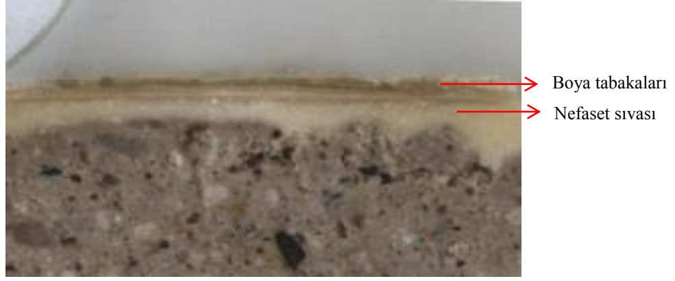
Şekil 4.24 : İç sıvada nefaset sıvası ve boya tabakalarının kesiti.
