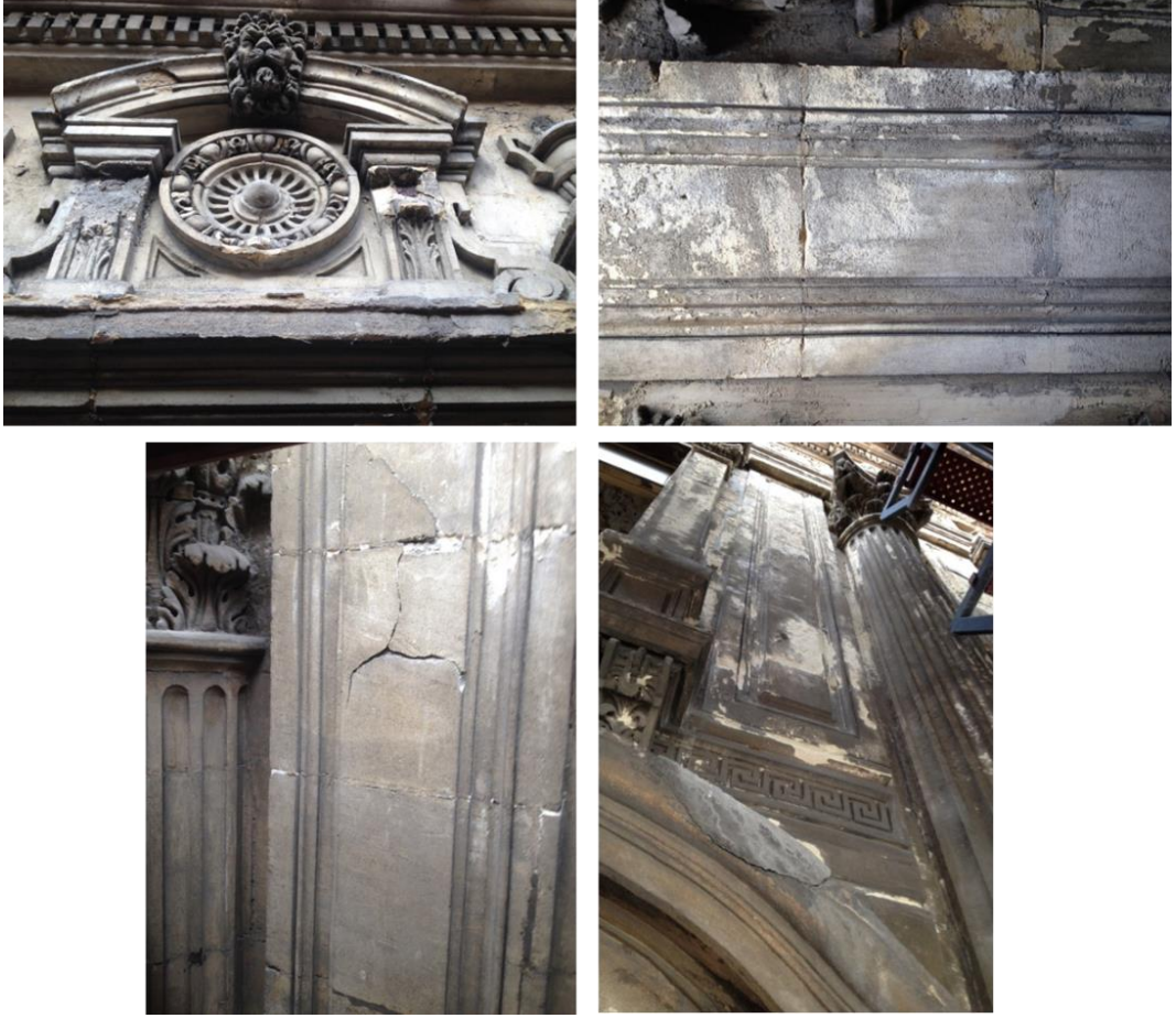
Şekil 4.4 : Yapının dış cephesinde tespit edilen çatlaklar ve uygulanan niteliksiz çimento onarımları.
