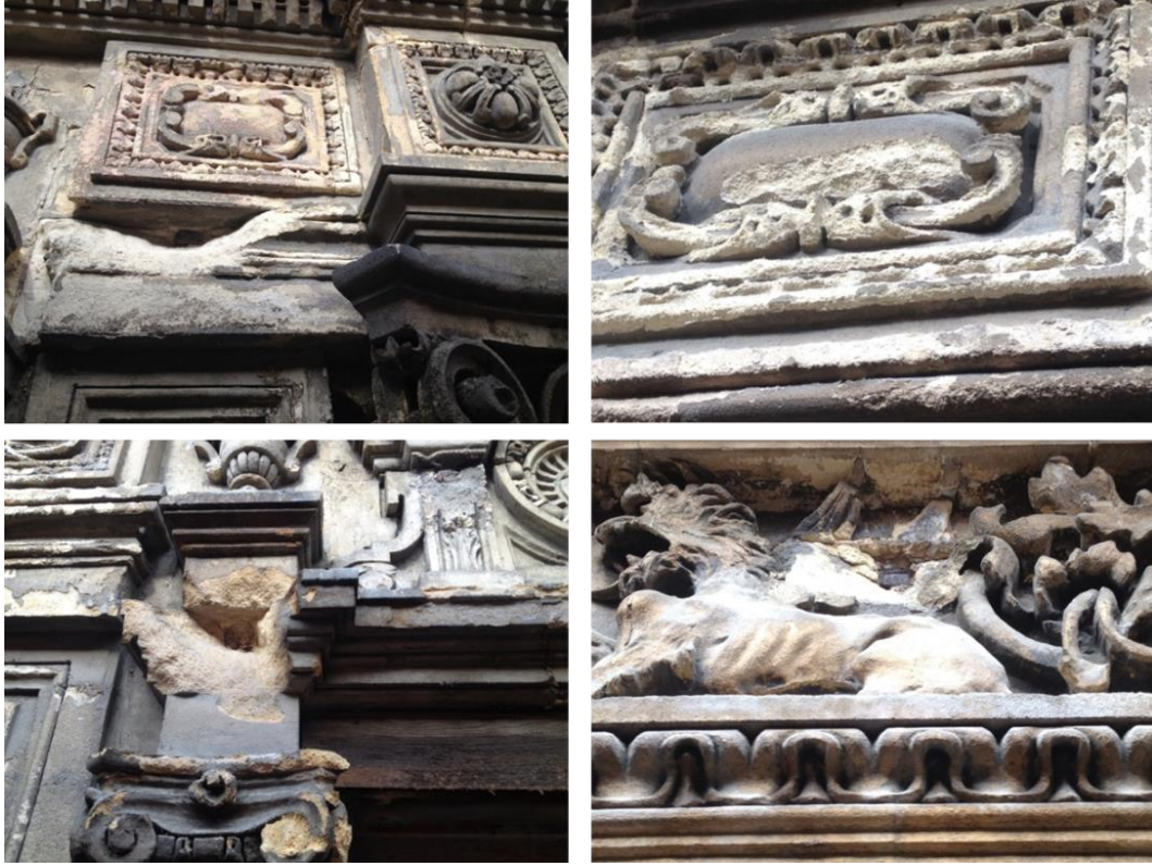
Şekil 4.8 : Dekorlu yüzeylerde erozyon sebebiyle oluşan malzeme kayıpları.
