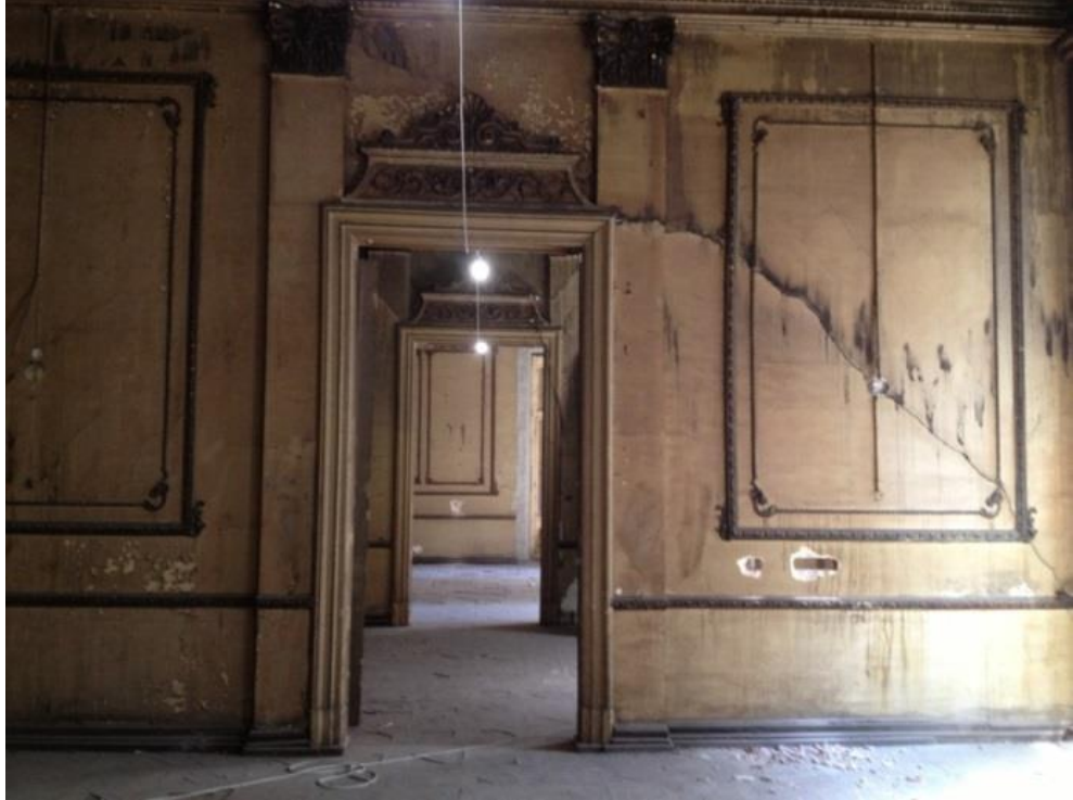
Şekil 4.19 : Kapı üzerinde bulunan bezemelerdeki tahribatlar.
