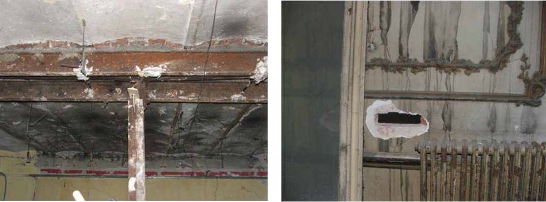
Şekil 4.21 : Metal elemanlarda ve kaloriferlerde korozyon ve çürüme.
