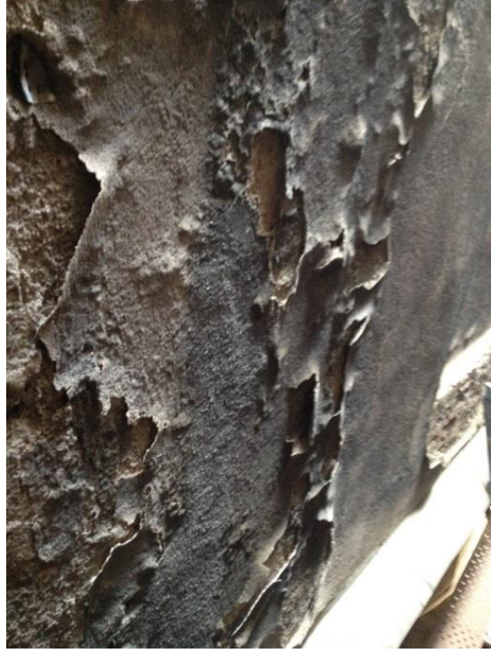
Şekil 4.7 : Yeşilçam cephesinde oluşan kabuklanma.
