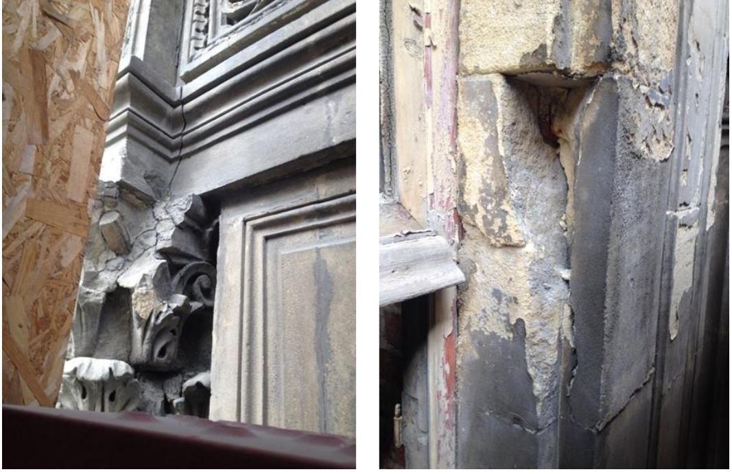
Şekil 4.10 : Sonradan eklenen ahşap eleman nedeniyle oluşan mekanik hasarlar (solda) ve metal donatıların korozyona uğraması sebebiyle oluşan tahribatlar.
