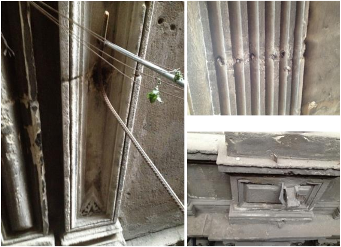
Şekil 4.13 : Niteliksiz ekler sebebiyle oluşan tahribatlar.
