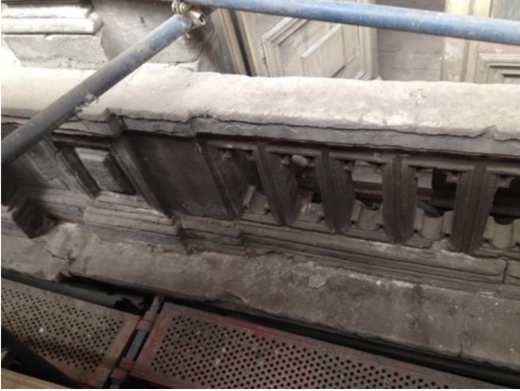
Şekil 4.5 : Balkon korkuluklarında bulunan tozuma ve yüzey aşınmaları.
