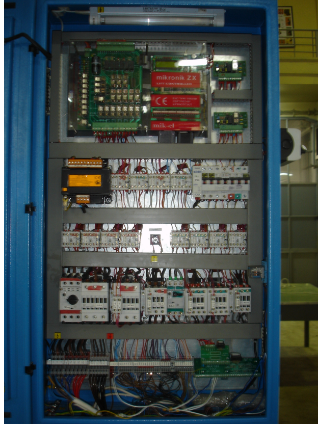
Şekil 3.18 : Elektrik Kumanda Panosu
