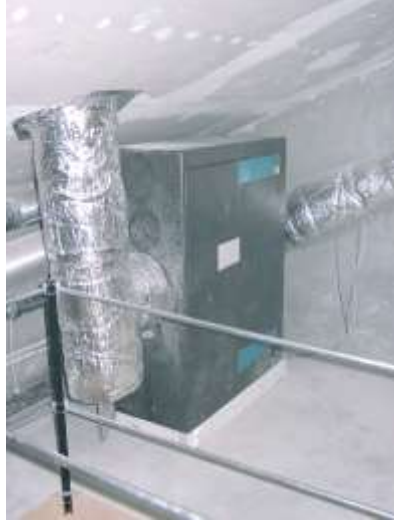
Şekil 4.11 : Bina servis katında bulunan ısı geri kazanımlı havalandırma ünitesi.
