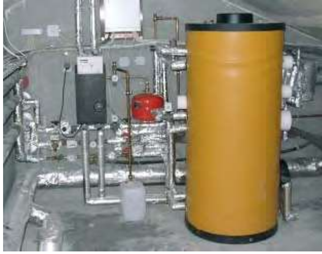
Şekil 4.14 : Bina servis katında bulunan sıcak su deposu.
