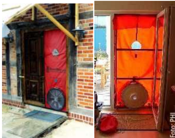
Şekil 3.11 : Dış kapıya monte edilen ventilatörün bina içi ve dışından görünümü [33].
