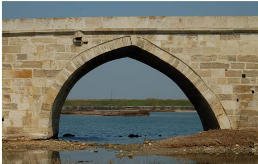
Şekil 4.13 : Onarım sonrası deforme olmuş kemer,Büyükçekmece Köprüsü, 2008
