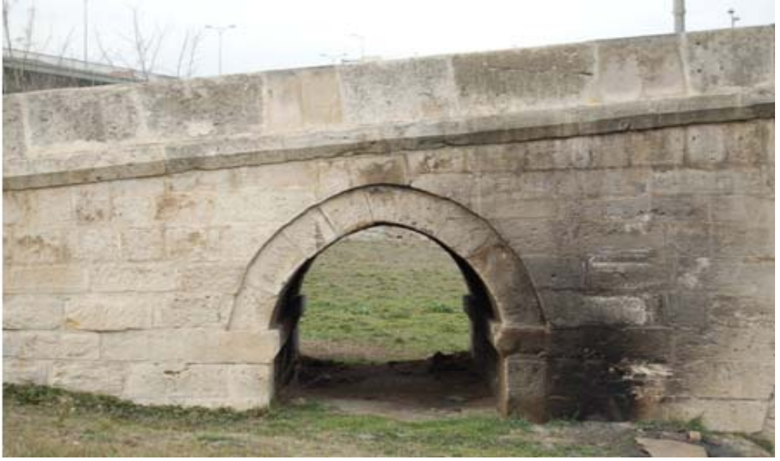
Şekil 6.4 : Doğu ve batı uçlarda yer alan tahliye gözleri, 2008
