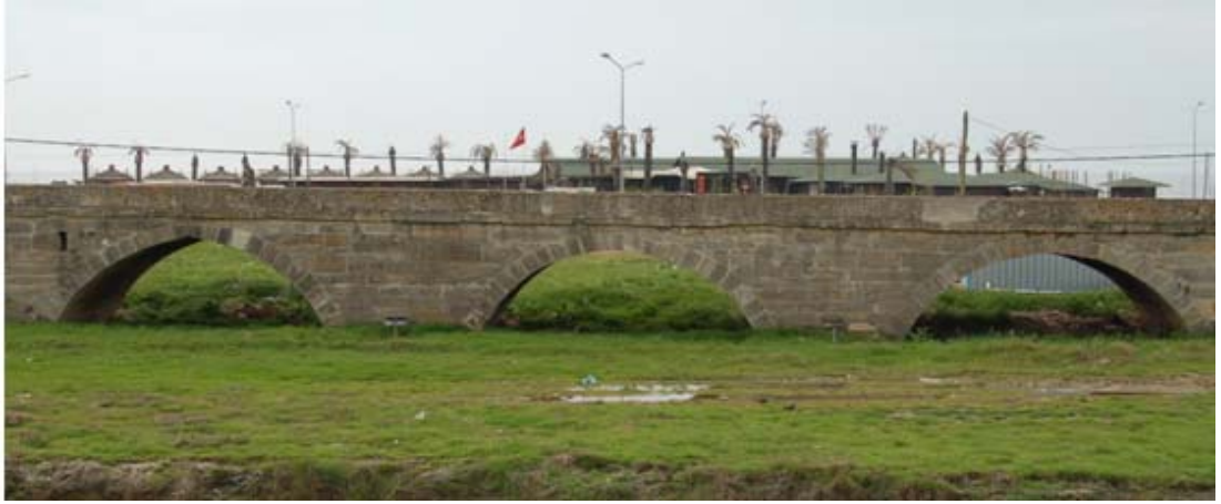
Şekil 5.35 : Deforme olmuş kemerler, 2008
