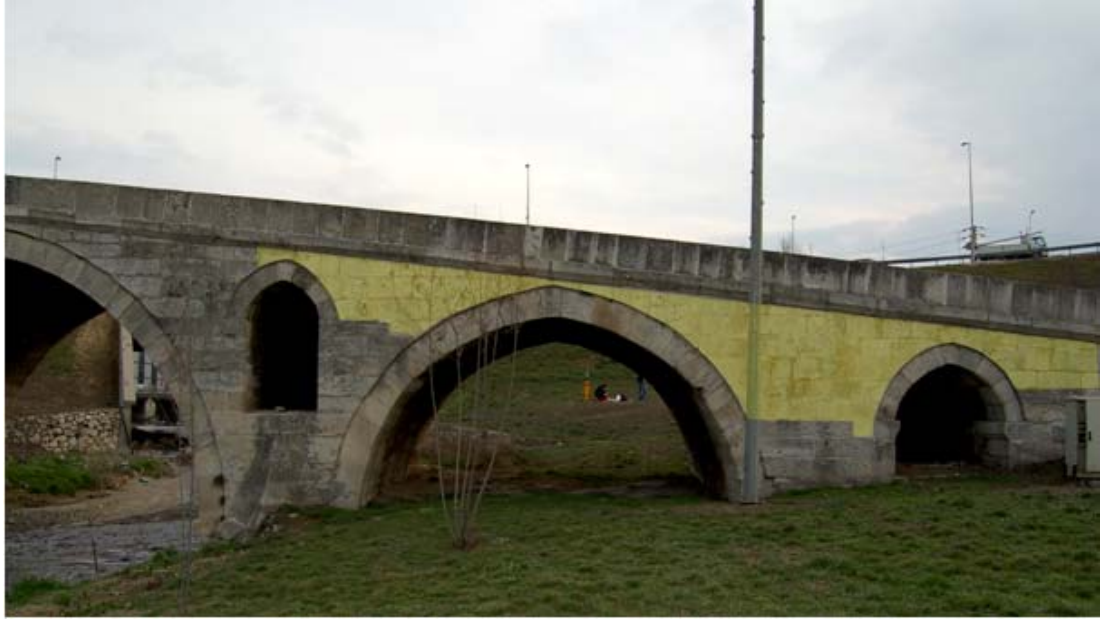
Şekil 6.26 : Kuzey cephesi Kemer 1 ve onarım izleri (taralı kısım yenilenmiş taşları göstermektedir)
