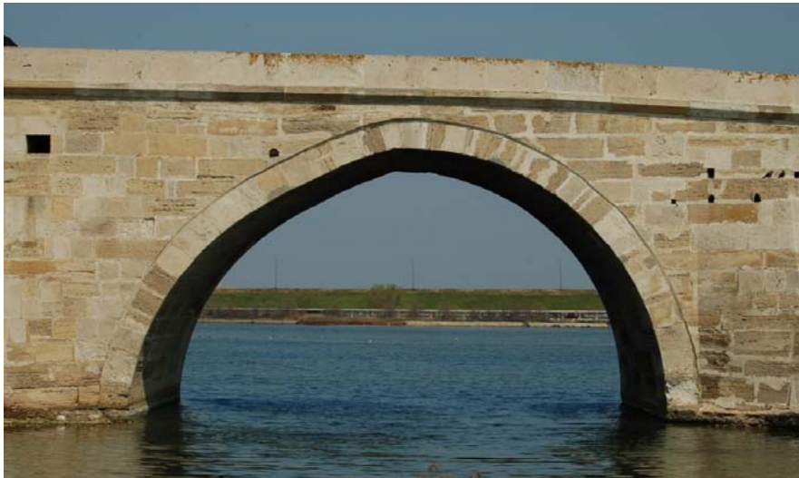
Şekil 5.30 : 4. Köprü deforme olmuş kemer, 2008
