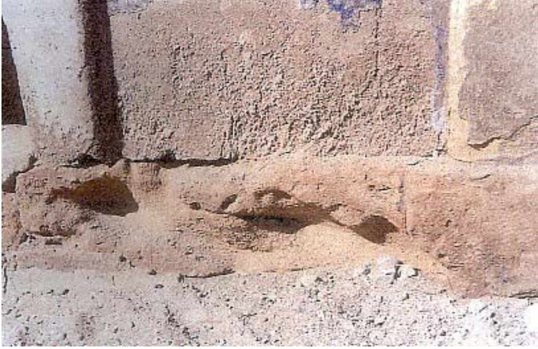
Şekil 4.11 : Donma çözülme etkisiyle oluşan hasar ( http://www.letoon.com.tr/86-Restorasyon-Teknikleri.html )
