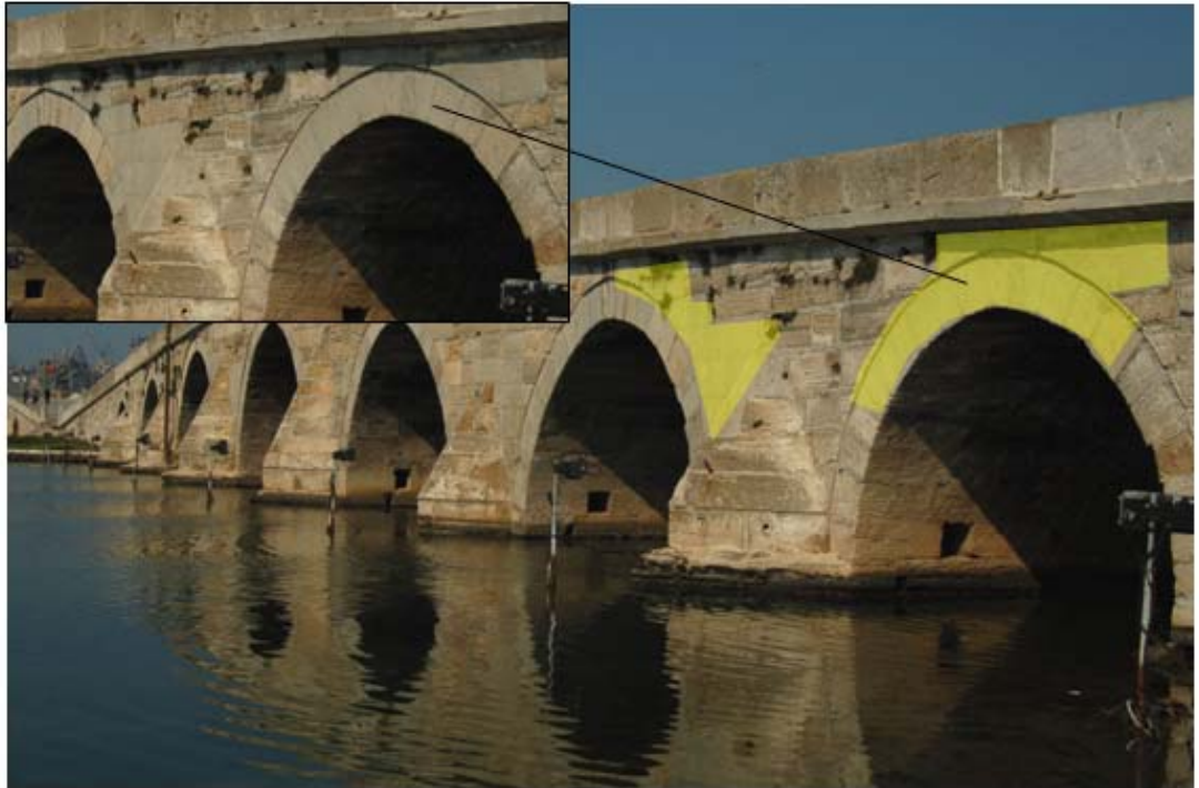
Şekil 5.24 : Büyükçekmece Köprüsü 2.Köprü mansap tarafında cephe taşları ile uyumsuz taş kullanımı, (2008)
