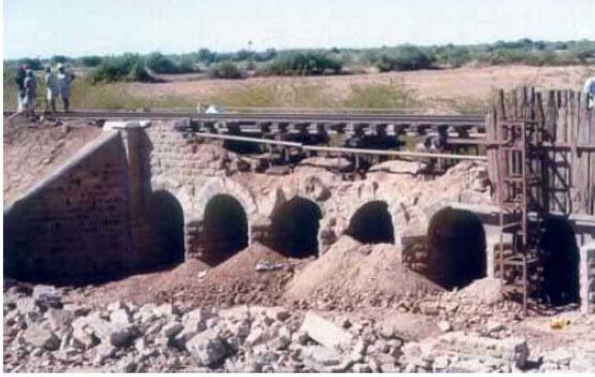
Şekil 4.5 : Hindistan 2001 Bhurj depreminden hasar görmüş bir demiryolu köprüsü [21]
