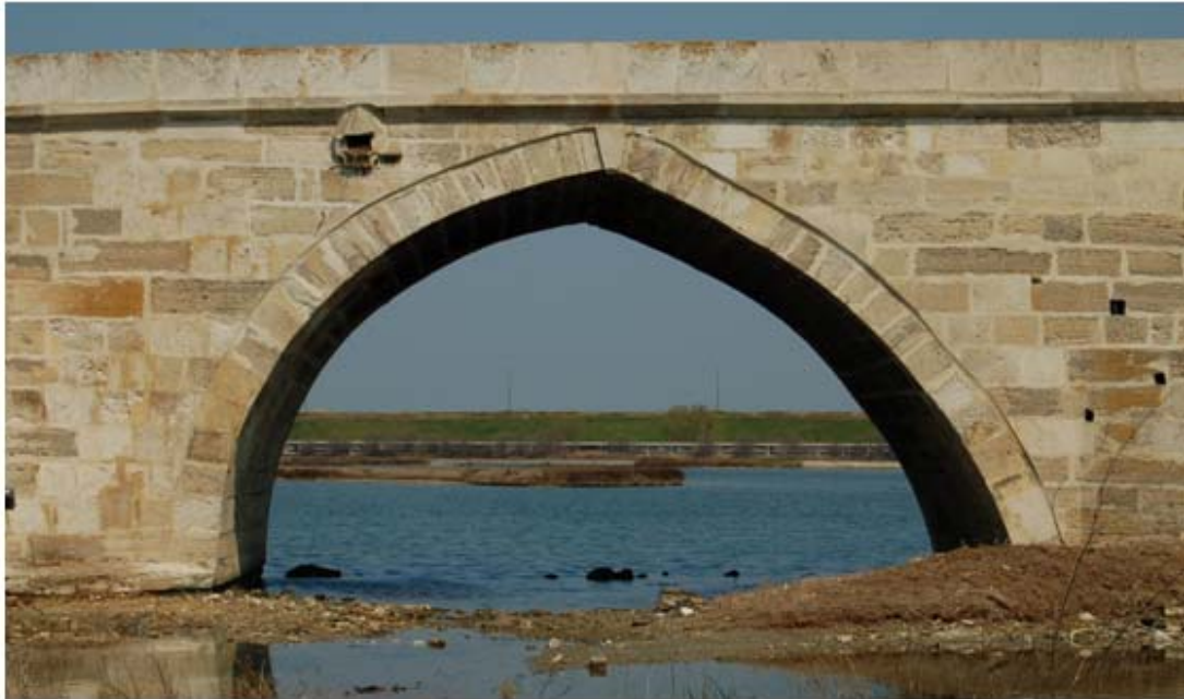
řekil 5.26 : Bykekmece Kprs 4. Kpr mansap tarafında deforme olmuř kemer, zgn olmayan rten detayı ve kilit tařı kabartması, (2008)
