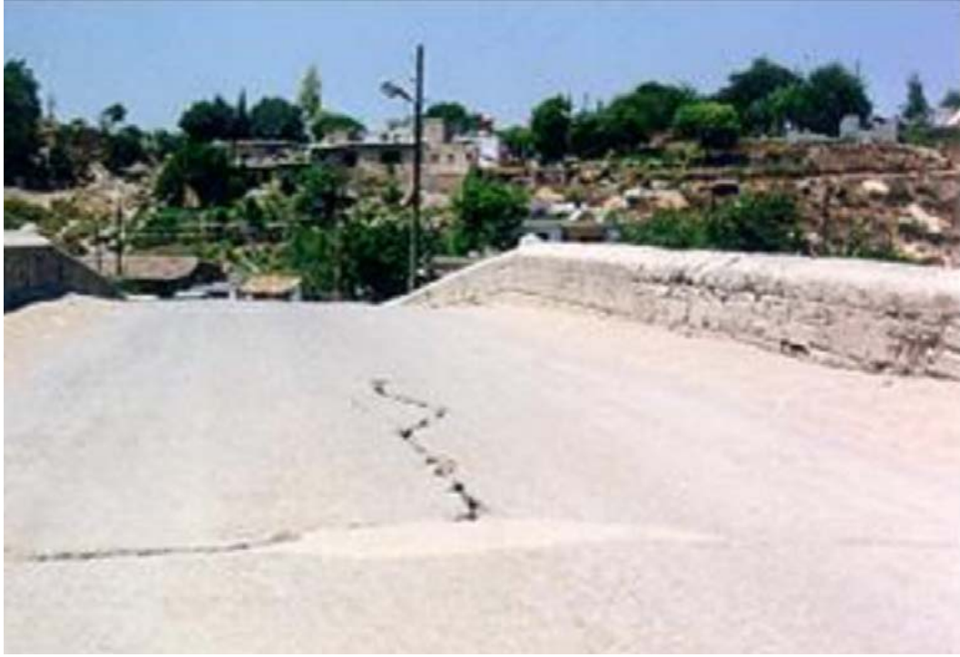
Şekil 4.7 : Adana Misis Köprüsü 1998 depremi sonrası hasarı (Nejat Bayülke 1998 Adana Depremi değerlendirme raporu ( http://angora.deprem.gov.tr/AdanaDamage.html )).
