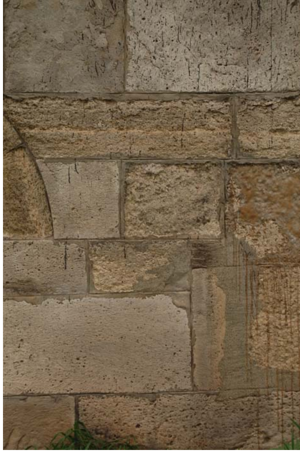
Şekil 5.21 : Sokullu Mehmet Paşa Köprüsü, uygun olmayan onarım detayı,2008
