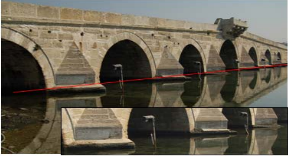
řekil 5.25 : Bykekmece Kprs 1. Kpr Gney cephesinde ayaklarda farklı oturmalar, 2008
