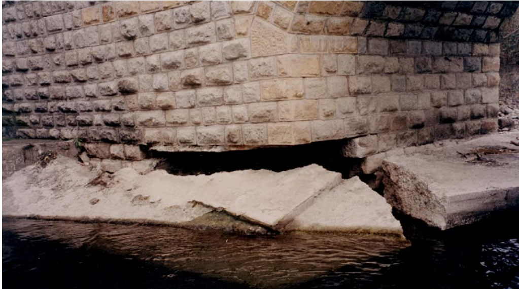
Şekil 4.1: Mataracı Köprüsü kemer ayağında sel hasarı,TCK fotoğraf arşivi, 2006 [19]
