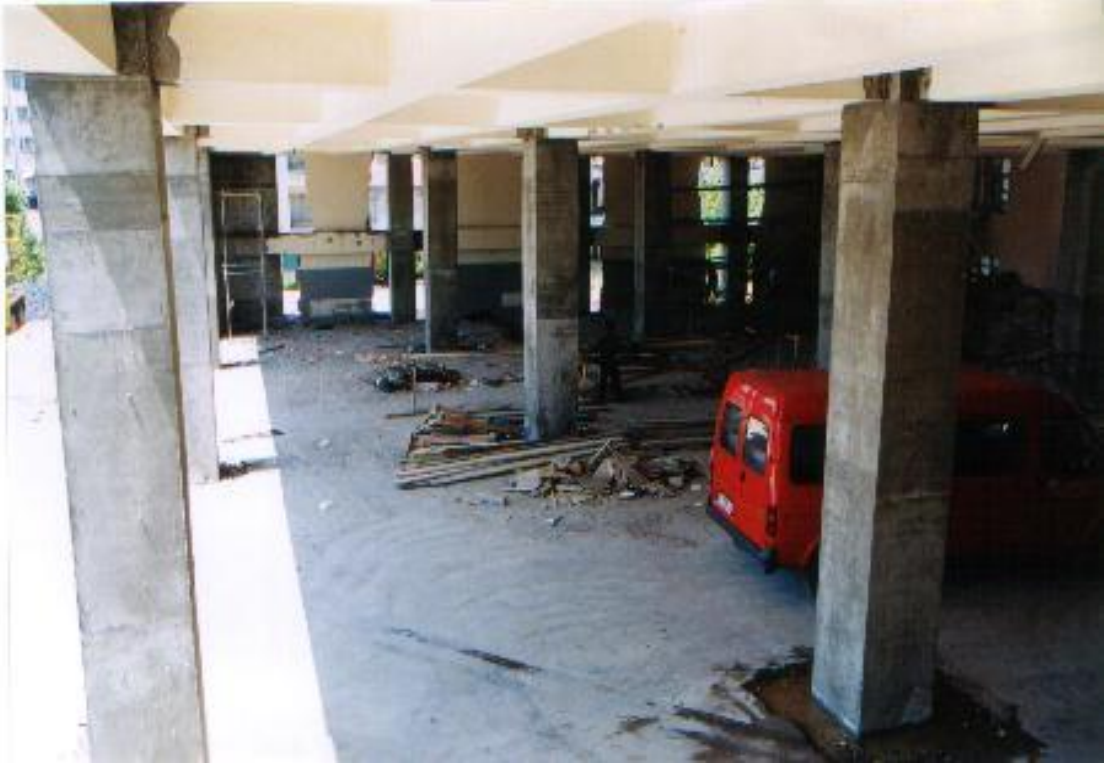
Şekil 8.18 Zemin Katta Mantolanan Kolonlar
