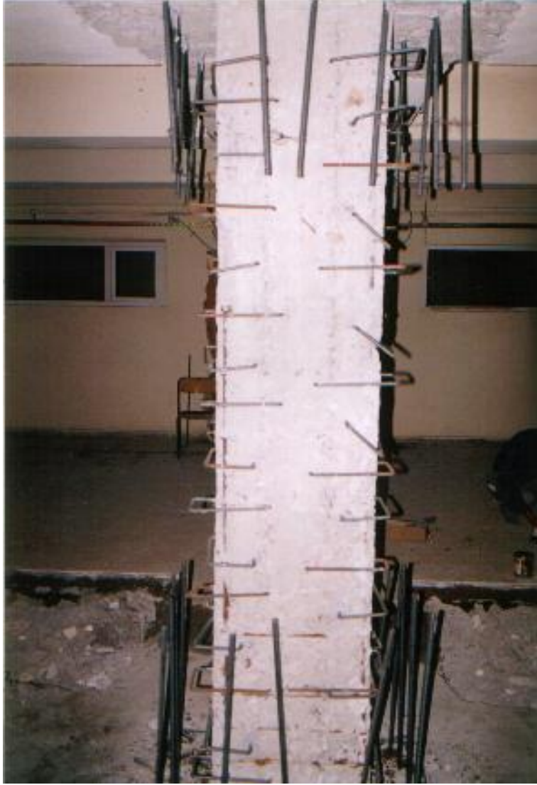
Şekil 8.11 Bodrum Katta Kiriş Altında Kalan Manto
