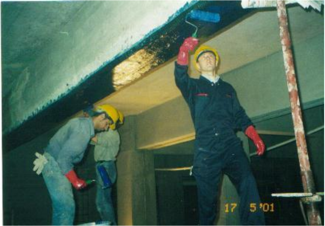
Şekil 7.9 Kiriş Altına Yapıştırıcı Malzemenin Sürülerek Üzerine Silis Kumu Serpilmesi ve Üzerine Sıva Yapılması
