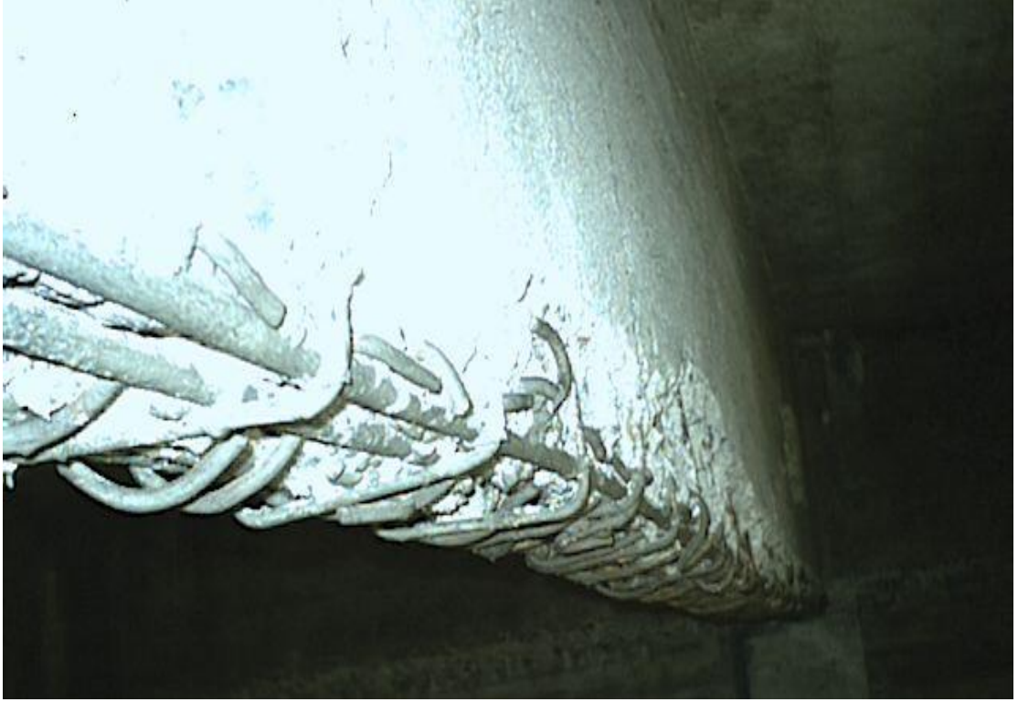
Şekil 2.1 Kiriş Altında Donatı Yoğunluğundan Kaynaklanan Betonun Yerleşmemesi
