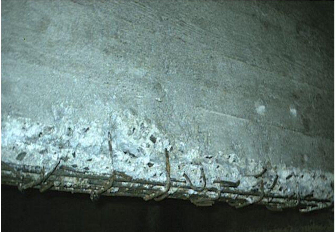
Şekil 2.2 Kiriş Altında Rutubetten Kaynaklanan Korozyon Hasarı
