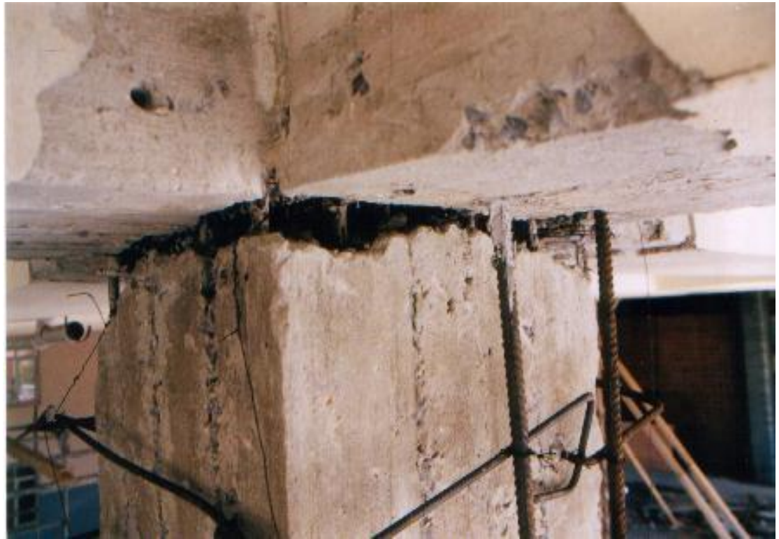
Şekil 2.10 Kolon Mesnet Bölgesinde Yerleşmeyen Beton
