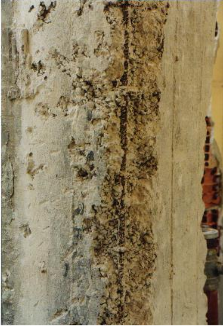
Şekil 2.11 Kolonda Kötü Beton Kalitesi
