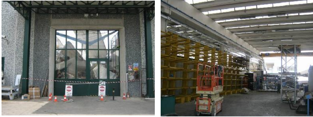
Şekil 1.5 : Mirandola’da Emilia-Romanga (2012) depreminde dış cephe panelleri hasarsız bir şekil ayakta kalmış, ancak içerisi göçen prefabrik endüstri yapısı.
