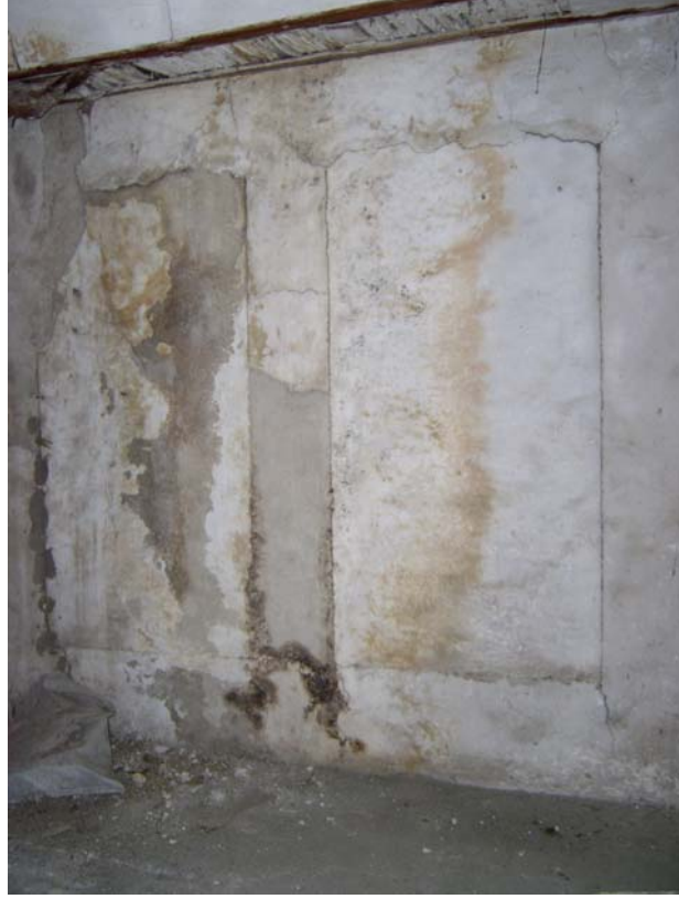
Şekil C.161. 103 Mekâmı kuzeydoğu duvarında görülen izler
