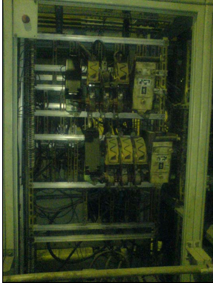
Şekil 1.2 : İsdemir Demir Çelik fabrikasındaki röle otomasyon sistemi
