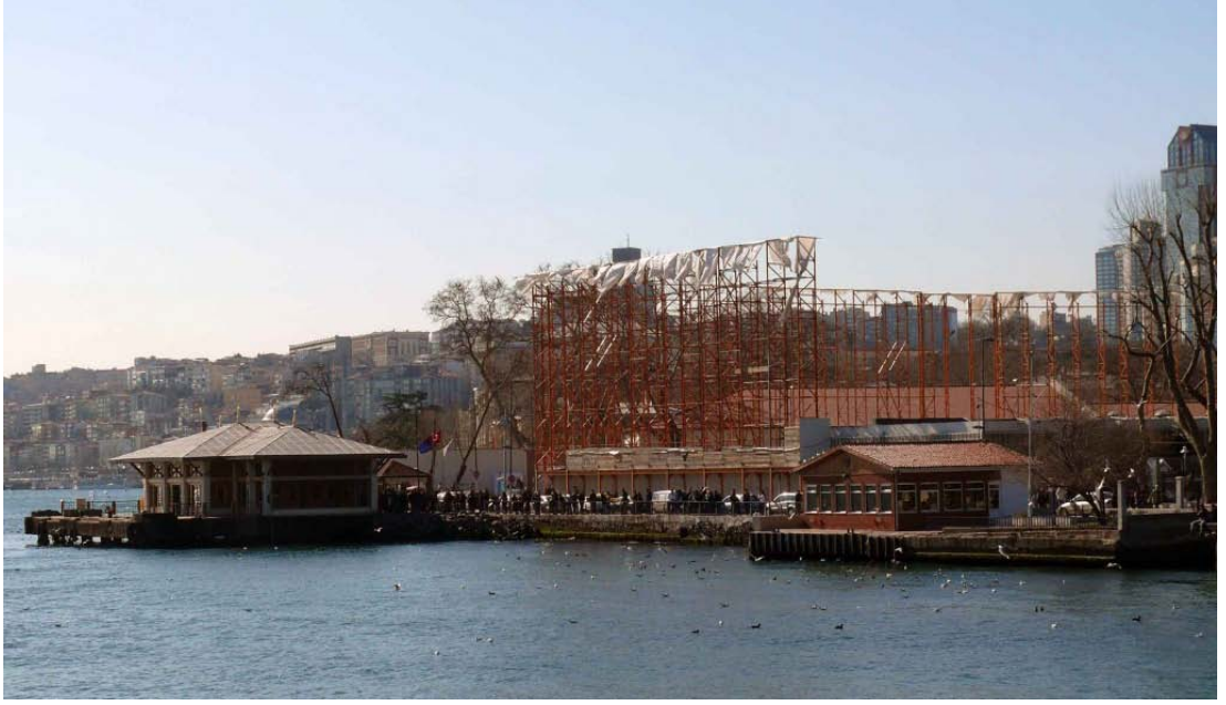
Şekil B.54: Tütün Deposu, kalmış olan iki cephenin de yıkılmış hali, Şubat 2008 (Url-8).
