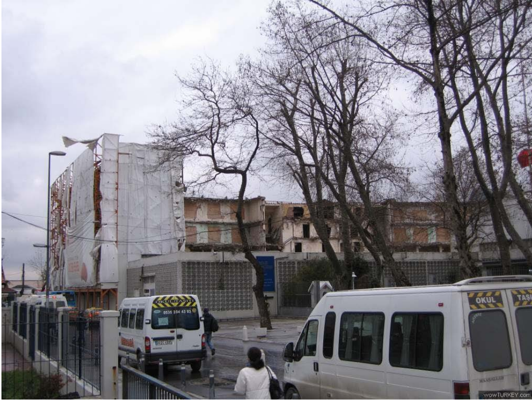
Şekil B.53: Tütün Deposu, sadece iki cephenin kalmış hali, Aralık 2007 (Url-8).
