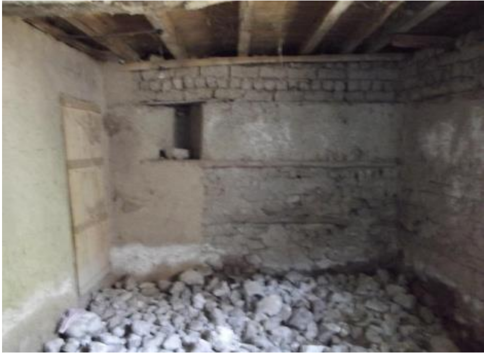
Şekil C.31 : Z02 mekanı doğu duvarında kapatılmış pencere ve sıva dökülmeleri.
