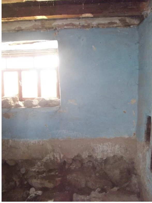
Şekil C.30 : Z02 mekanı sıva dökülmesi ile ortaya çıkan yapım sistemi detayı.
