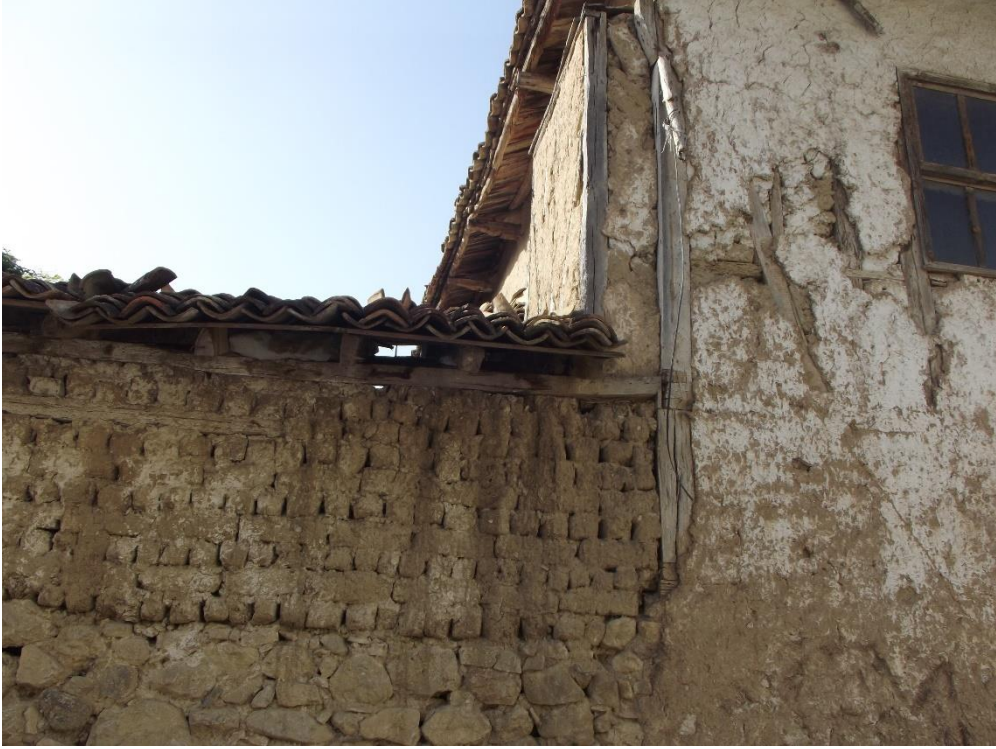
Şekil C.112: Güney cephesi sıva dökülmeleri.
