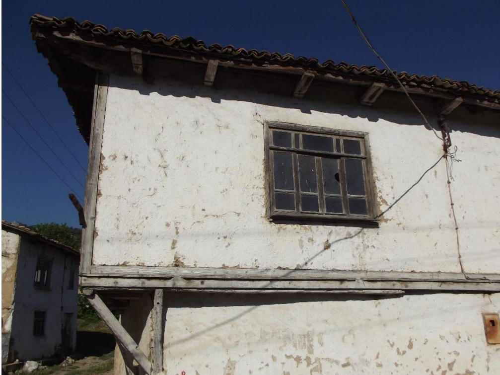
Şekil C.117: Doğu cephesi sıva çatlakları ve boya dökülmesi görünümü.
