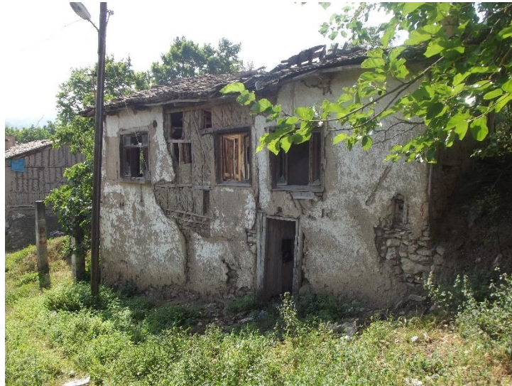
Şekil B.14 : Envanter no: 9 olan yapı yıkıntısı.
