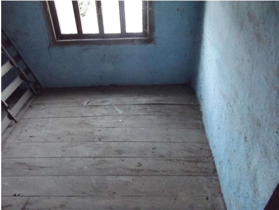
Şekil C.99: 105 mekanı ahşap döşeme kaplamasında sehim görünümü.
