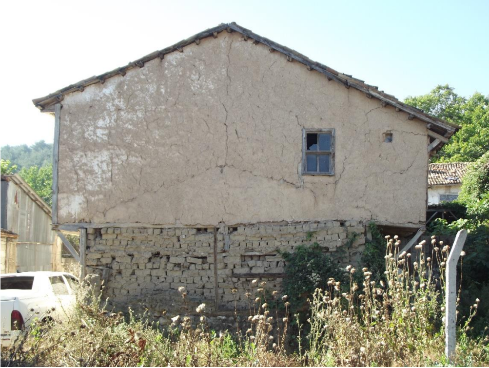
Şekil C.116: Kuzey cephesi sıva çatlakları ve boya dökülmesi görünümü.
