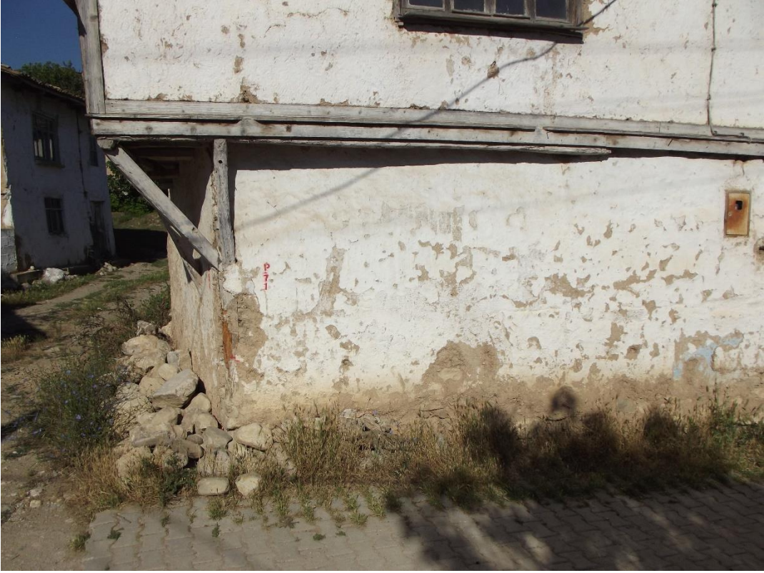
Şekil C.118: Doğu cephesi sıva dökülmesi görünümü.
