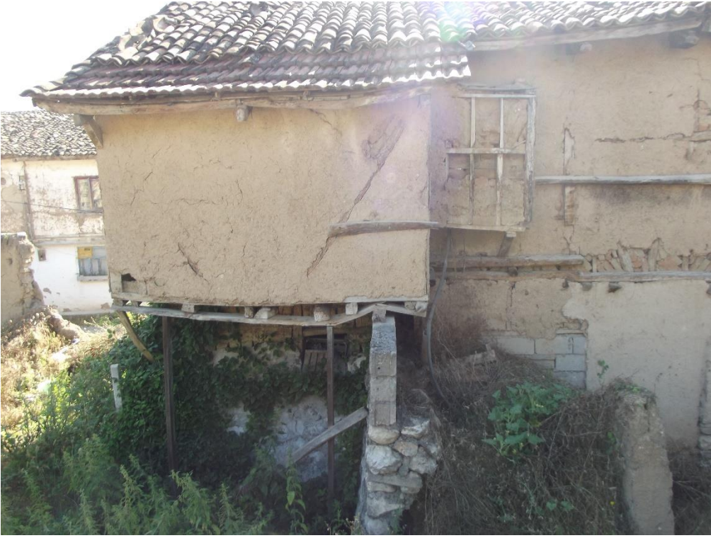
Şekil C.114: Batı cephesi sıva dökülmesi görünümü.
