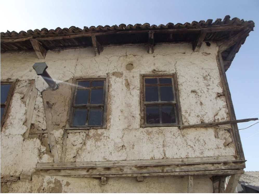
Şekil C.110: Güney cephesi sıva dökülmesi ve ahşapta bozulmalar.
