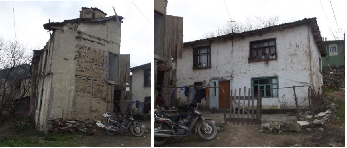
Şekil B.27 : Envanter no: 21 olan yapı ve yanındaki yıkıntı.
