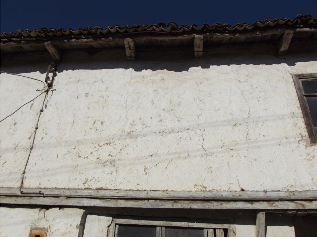
Şekil C.120: Doğu cephesi kapatılmış pencerelerin bulunduğu bölümde çatlaklar.
