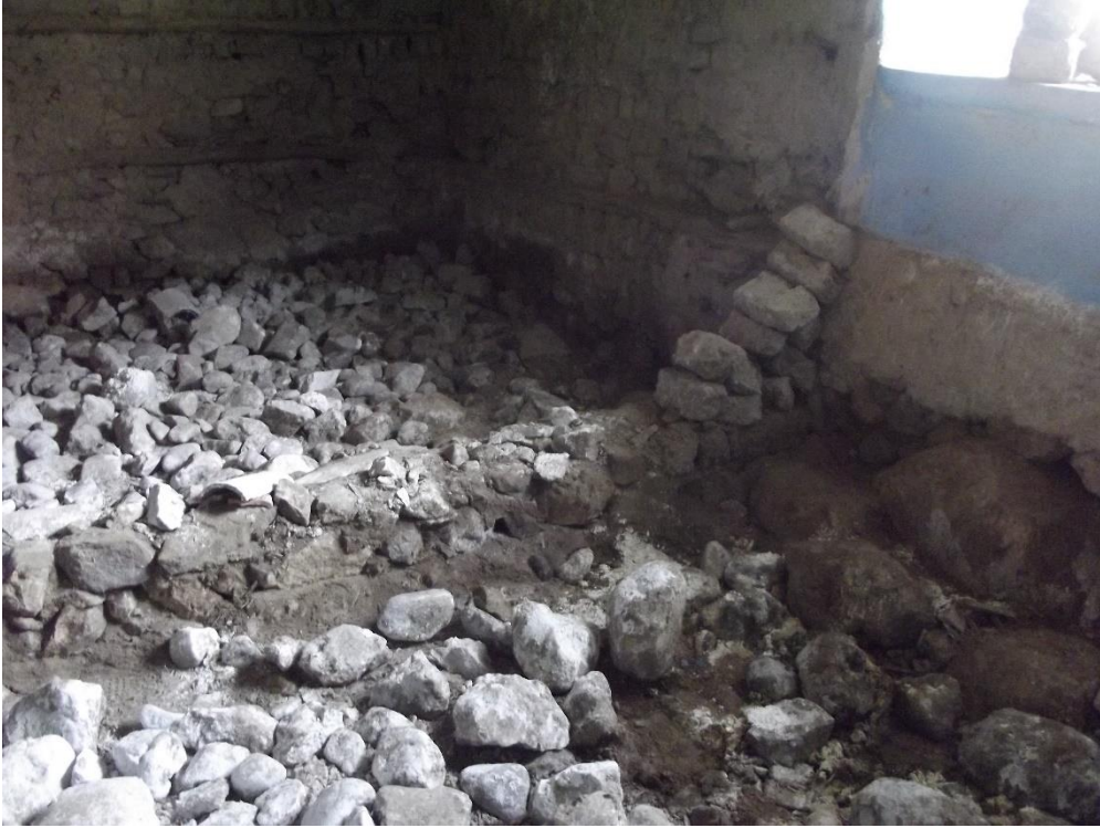
Şekil C.33 : Z02 mekanı yıkılmış duvar izi ve kaldırılmış döşeme altında ortaya çıkan blokaj.
