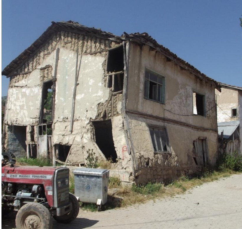
Şekil B.19 : Envanter no: 13 yanındaki yapı yıkıntısı.
