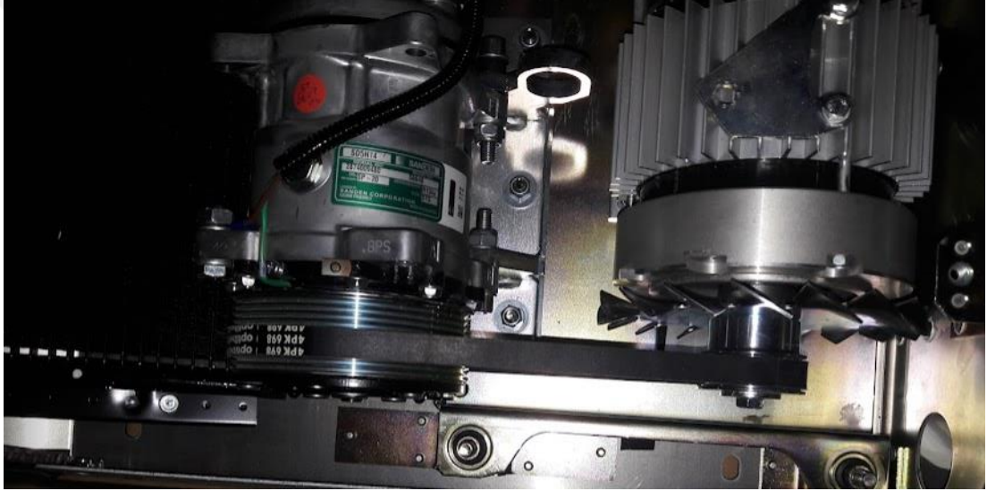
Şekil 4.12 : Elektrik motoru-kompresör düzeneği
