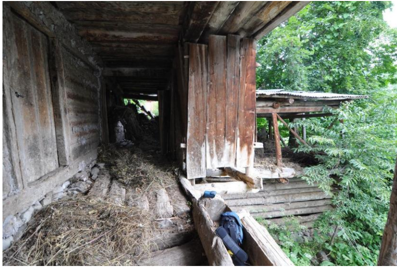
Şekil B.22 : Ahır duvarı yüzeyindeki gübre-saman karışımı
