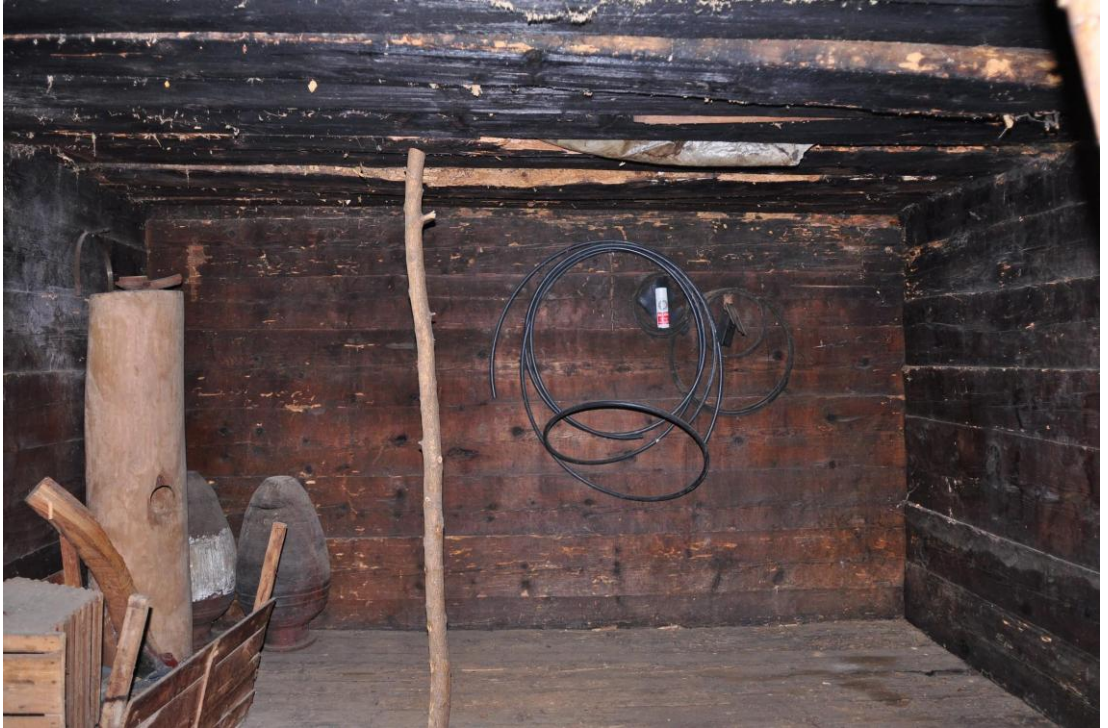
Şekil C.153 : 1-04 Ambar – yangın etkisiyle kömürleşmiş duvar yüzeyi
