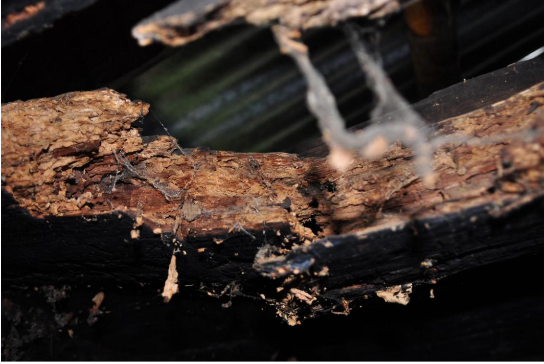
Şekil C.154 : 1-04 Ambar – tavanda yangına bağlı kömürleşme
