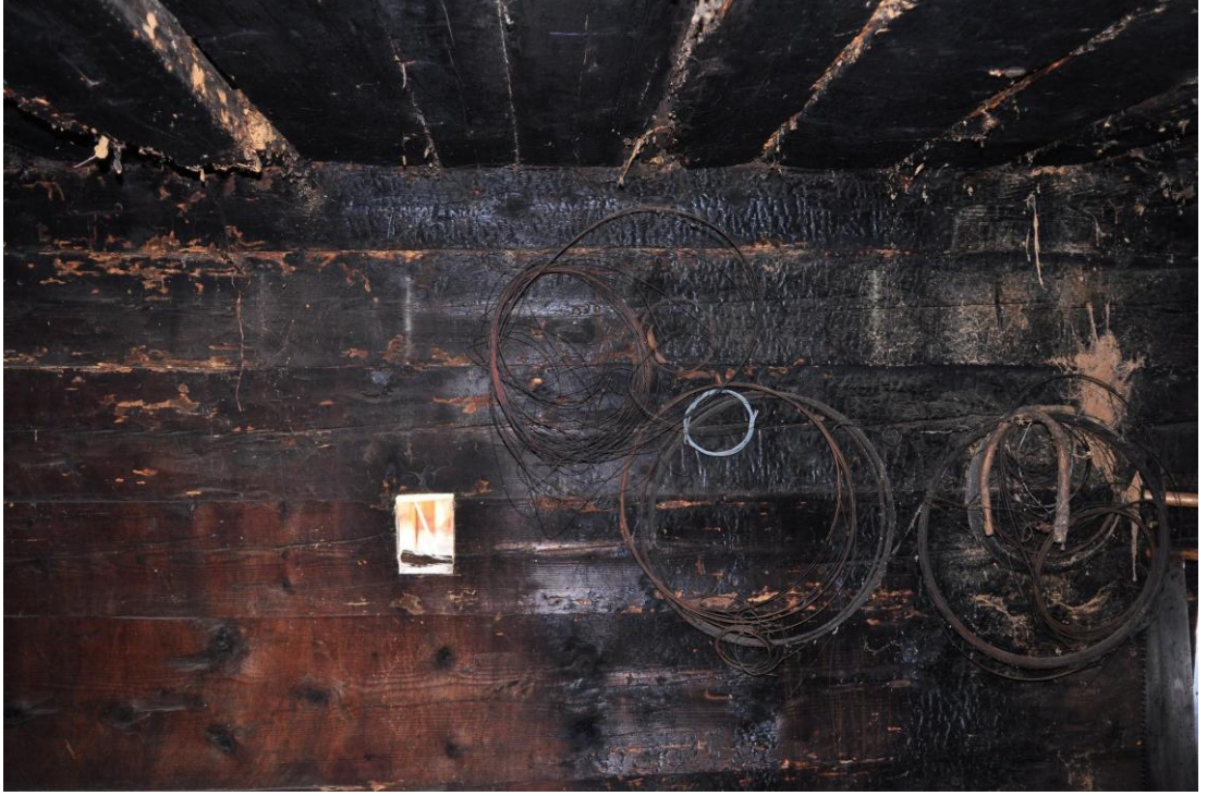
Şekil C.152 : 1-04 Ambar – yangın etkisiyle kömürleşmiş duvar yüzeyi
