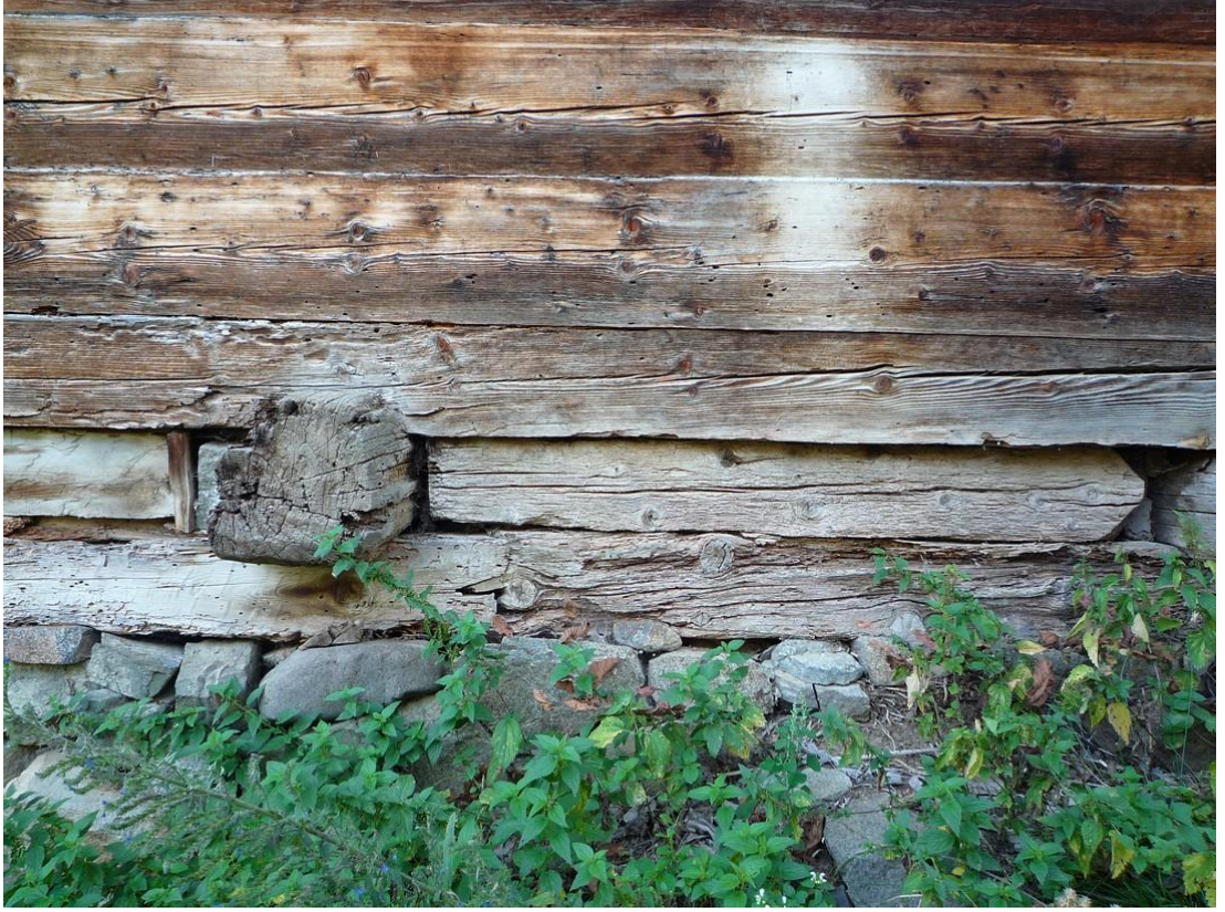
Şekil C.37 : Kuzeydoğu cephesi – koşat , guant ve parak ; böcek uçma delikleri ve mantar çürüklüğü
