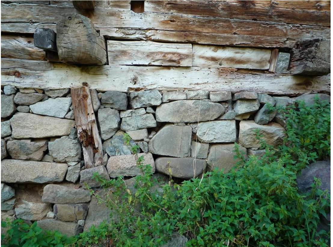
Şekil C.38 : Kuzeydoğu cephesi – koşat , guant ve parak ; böcek uçma delikleri ve mantar çürüklüğü
