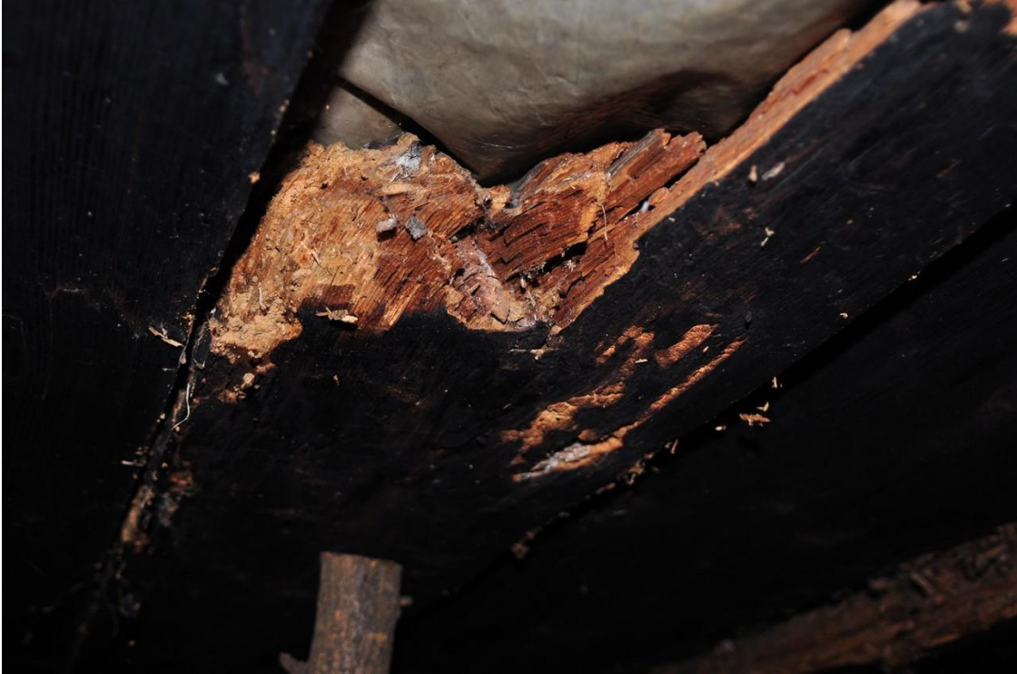
Şekil C.155 : 1-04 Ambar, tavanda yangına bağlı kömürleşme
