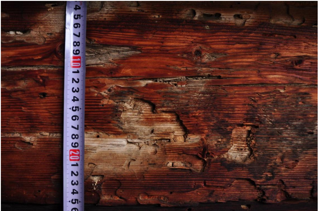
Şekil C.136 : 1-01 Üst dandraba – duvar tahtasında böceklenmeye bağlı hasar
