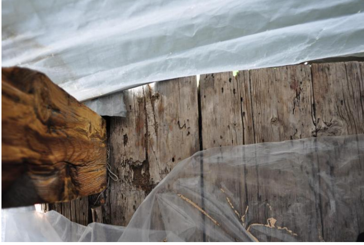
Şekil C.137 : 1-01 Üst dandraba – döşeme tahtalarında çatlak, uçma delikleri
