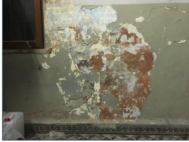
Şekil 6.1 : 3K-06 Koridor mekanının kuzeybatı duvarında ortaya çıkan boya katmanları.
