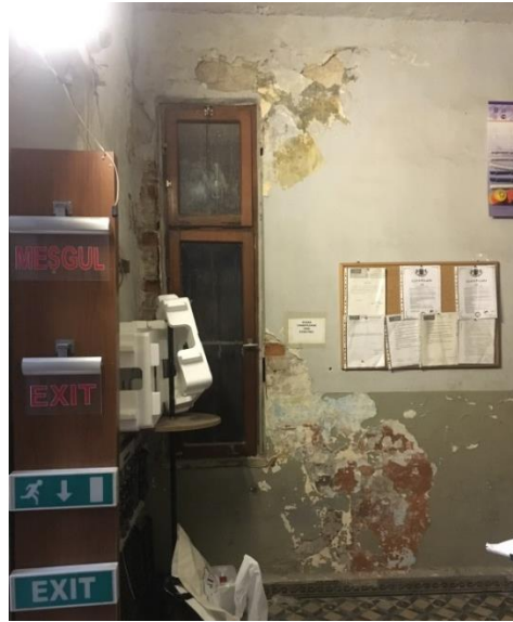
Şekil 4.33 : 3K-06 koridor mekanı kuzeybatı duvarında sıva dökülmesi sonucu açığa çıkan dolu tuğla kullanımı.
