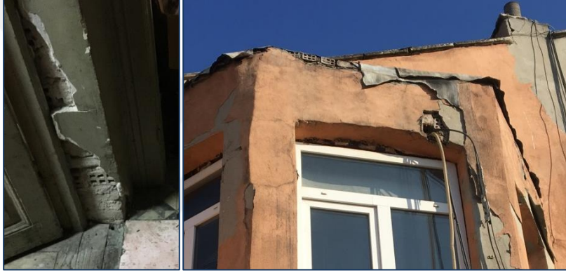
Şekil 4.32 : 3K-05 mekanı güneydoğu duvarı sıva dökülmesi, güneybatı cephesi çıkma üçüncü kat sıva dökülmesi ve dolu tuğla ile birlikte delikli tuğla kullanımı.
