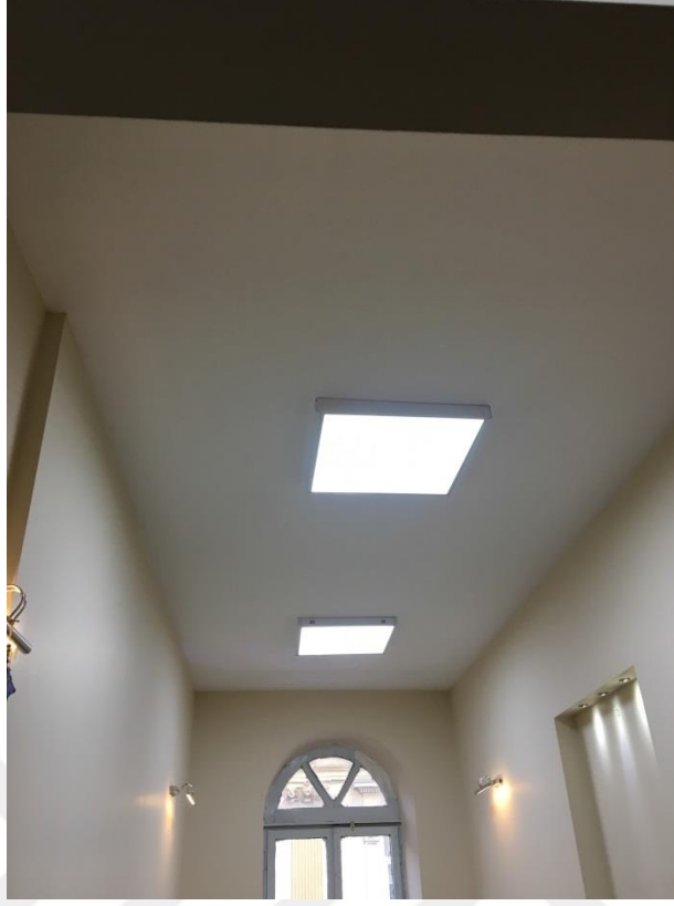
Şekil F.106: 3K-03 oda mekanının sonradan yapılan alçıpan asma tavanı.
