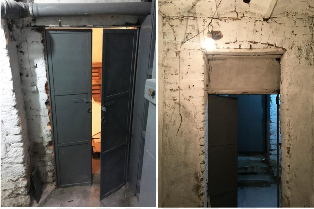
Şekil F.31 : BK-06 depo mekanına açılan, çift kanat biyeli dökme demir kapı.
