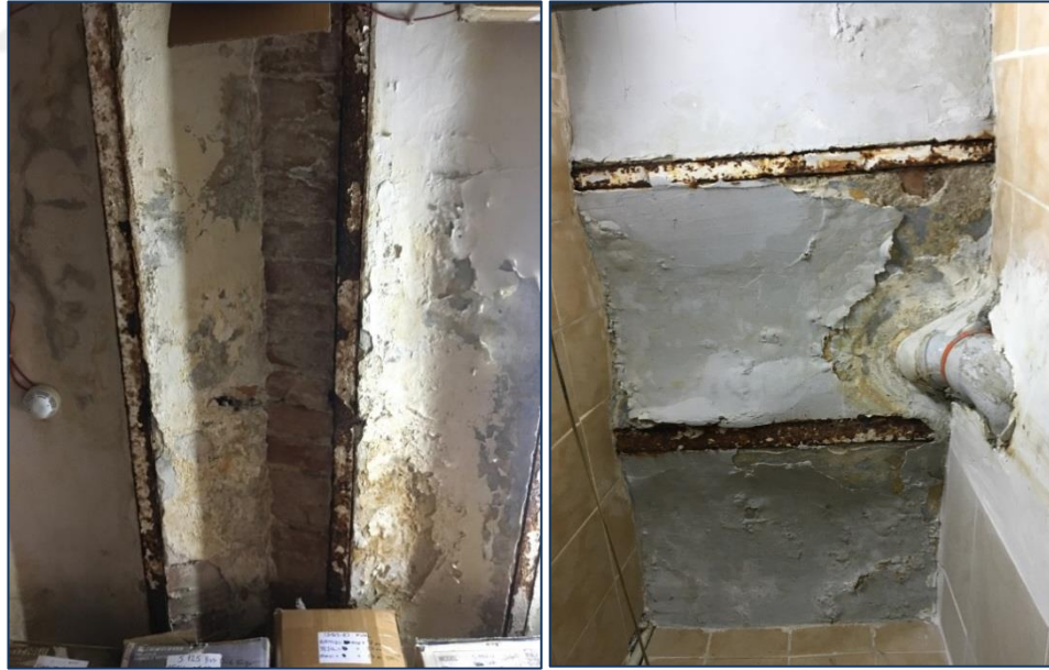
Şekil 6.2 : Korozyona uğrayan putreller ve bu bozulmanın meydana getirdiği döşemedeki sıva dökülmeleri.
