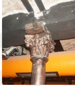
Şekil 5.1 : Zemin kat mağazanın kareye yakın formunun ortasından geçen kagir duvarın kaldırılması sonucu açığa çıkan kirişi destekleyen yuvarlak kesitli dökme demir iki adet kolondan bir tanesine ait fotoğraf.
