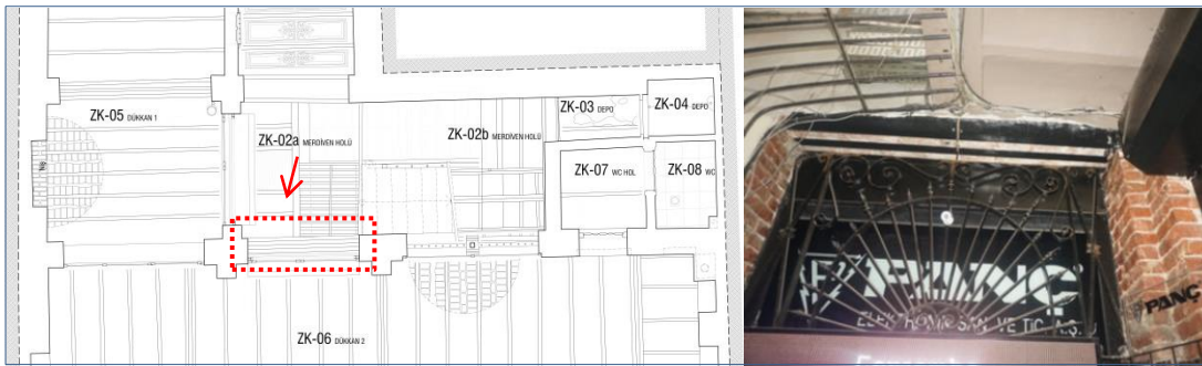
Şekil 4.24 : Giriş kat mağaza kaldırılan kagir duvar sonucu açığa çıkan donatılı kiriş.
