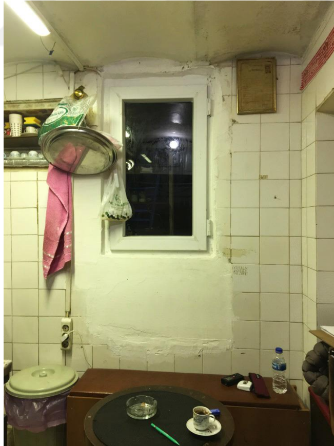
Şekil F.18 : ZAK-01 çay ocağından A2 Aydınlığına bakan sonradan değiştirilmiş pvc pencere.
