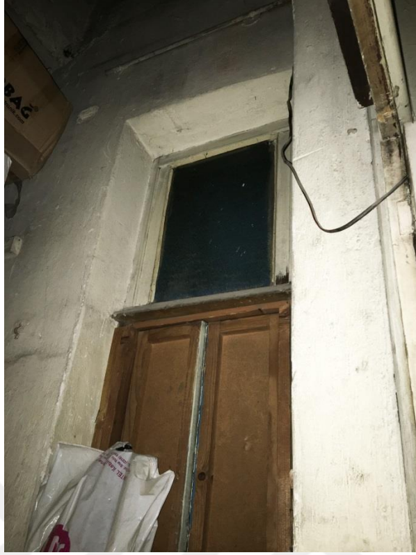
Şekil F.102: Günümüzde kuzeydoğu yönünden kapatılmış olan, A3 aydınlığından (3K-04 depo), 3K-03a mekanına açılan pencere.
