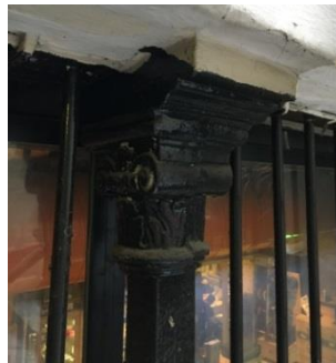
Şekil 5.2 : M1 merdivenine bakan mağaza kagir duvarının kaldırılması sonucu açığa çıkan kirişi destekleyen kare kesitli demir kolon ve iki cephesi farklı dökme demir sütun başlığı.
