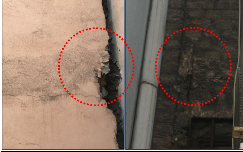
Şekil 4.35 : Güneybatı cephesi sıva dökülmesi sayesinde açığa çıkan demir kılıç, güneydoğu cephesinde bulunan demir kılıç.
