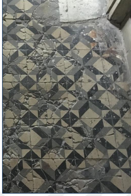
Şekil 6.3 : İkinci kat koridoru karosiman kaplamalarında meydana gelen çatlaklar.
