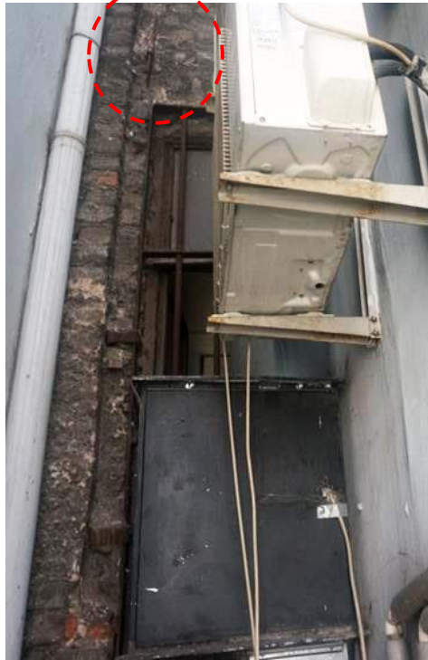
Şekil F.141 : Güneydoğu cephesi birinci kat döşeme hizasındaki metal kılıç.
