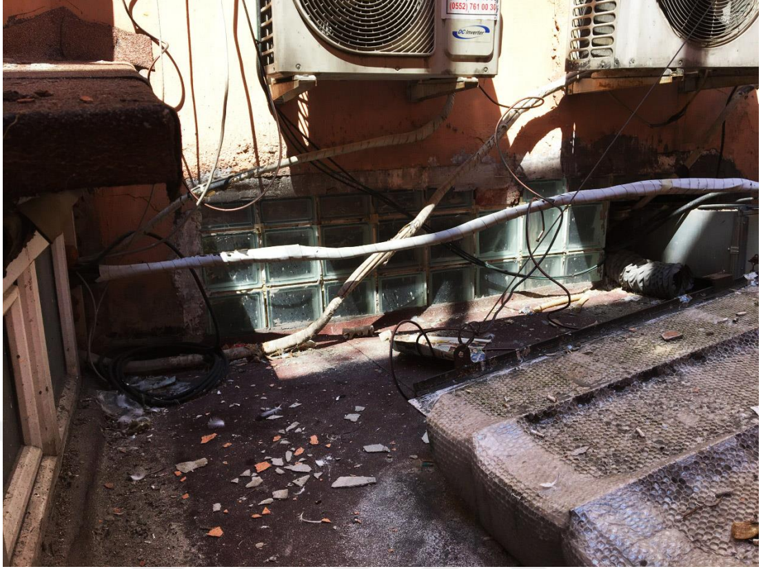
Şekil F.9 : Zemin kat güneybatı ana beden duvarı +3.30 kotuna sonradan konulan cam tuğlalar.
