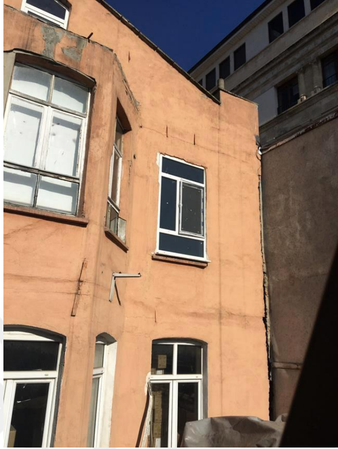
Şekil F.138 : Güneybatı cephesi üçüncü kat zemin ve tavan döşeme kot hizası, sıva üzeri gözlenen metal kılıçlar ile arka cephenin 13 parseldeki bitiştigi noktada 7-12 cm arasında duvarda meydana gelen ayrılmalar.
