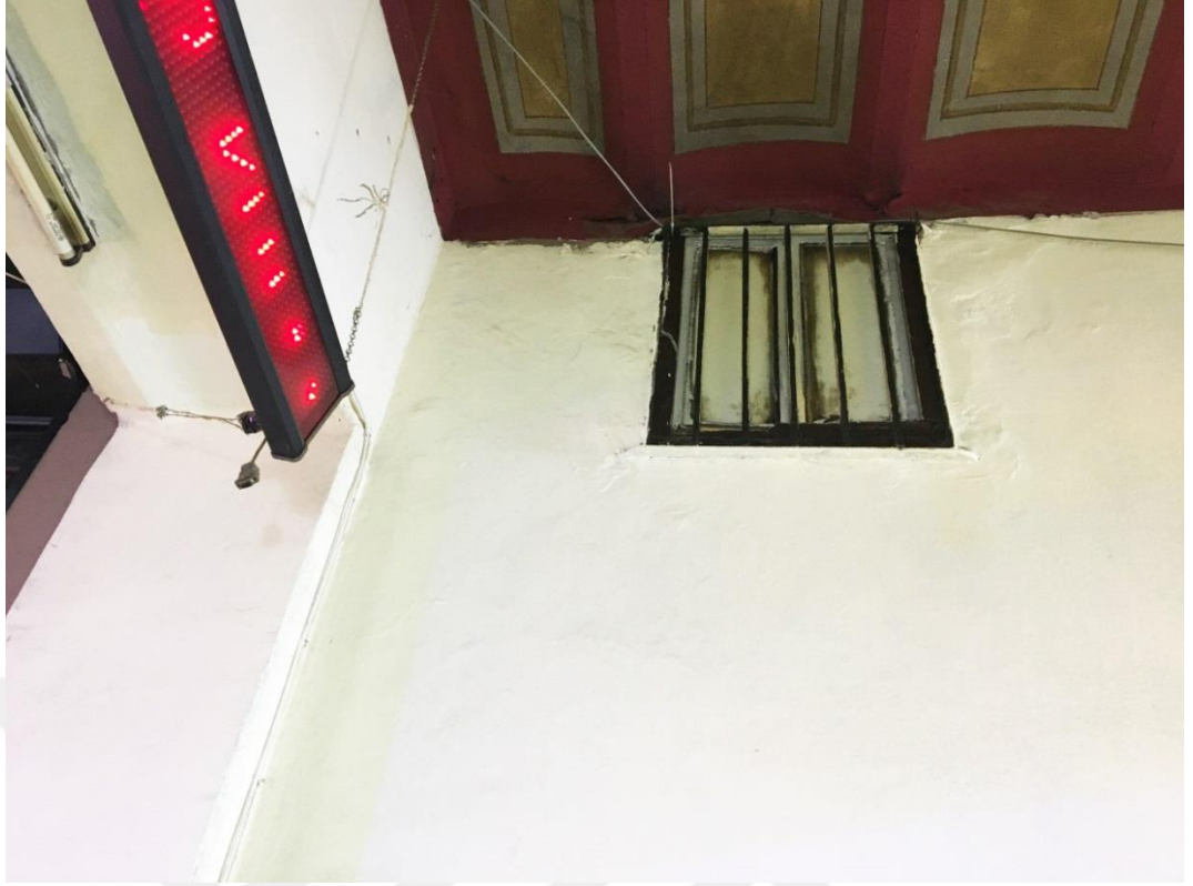
Şekil F.13 : ZK-02 giriş koridoru mekanının kuzeybatı duvarına sonradan eklenen pencere.
