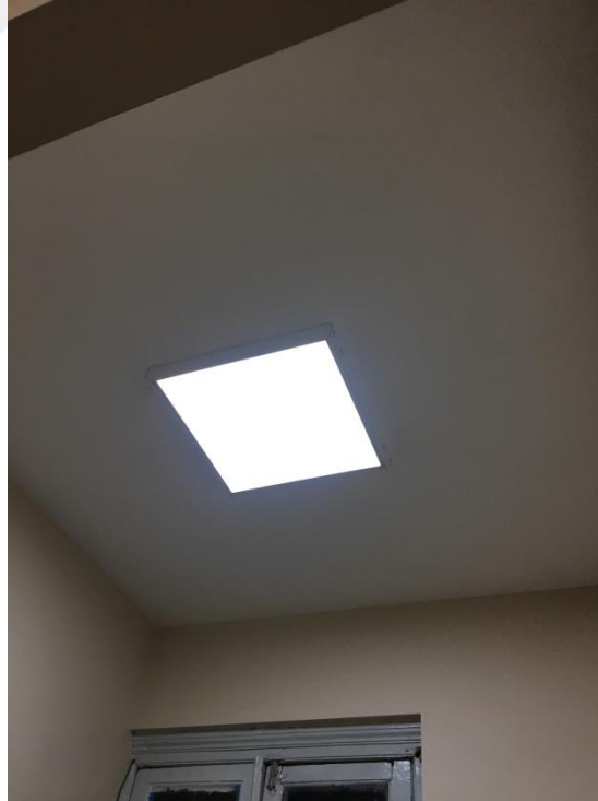
Şekil F.107: 3K-03a oda mekanının sonradan yapılan alçıpan asma tavanı.
