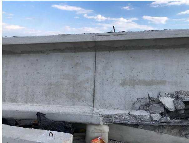
Şekil 3.9 : Eğimli çatı kirişinde L/4 açıklıkta oluşan diyagonal çatlaklar.
