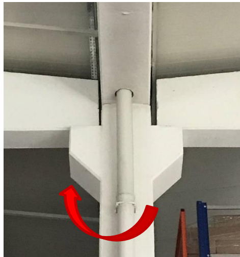
Şekil 3.27 : Prefabrike betonarme binanın kolonlarında oluşan dönme ile çatı kirişlerinin montaj tolerans farkı.
