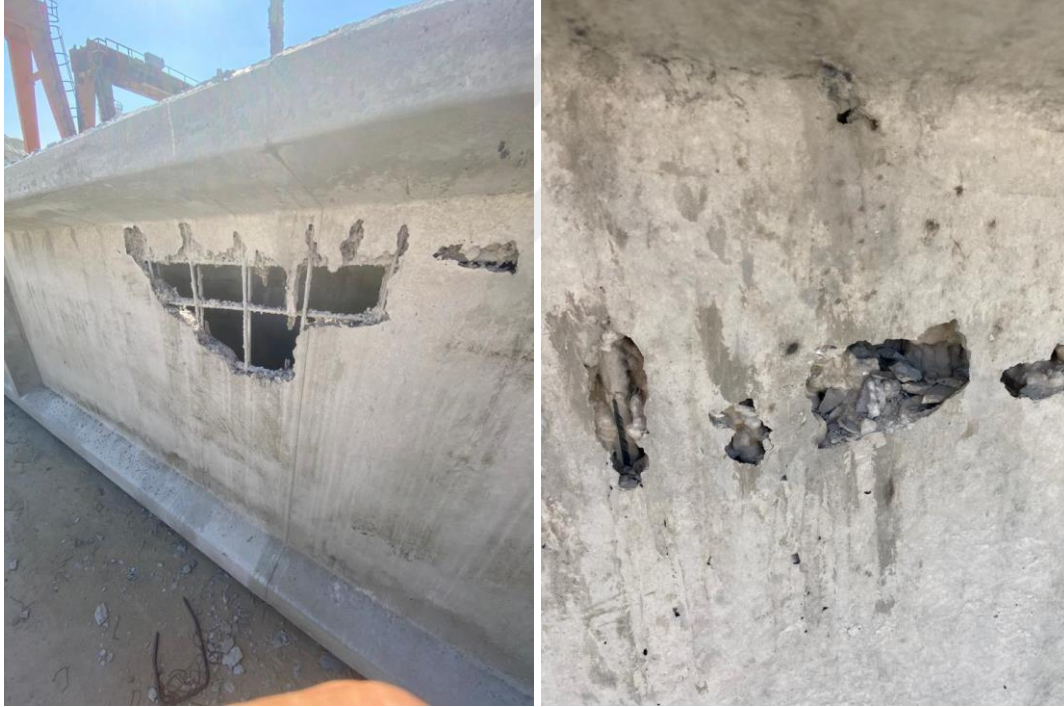
Şekil 3.12 : Betonun kalıp içinde homojen dağılmaması sonucu kirişte oluşan hasarlar.
