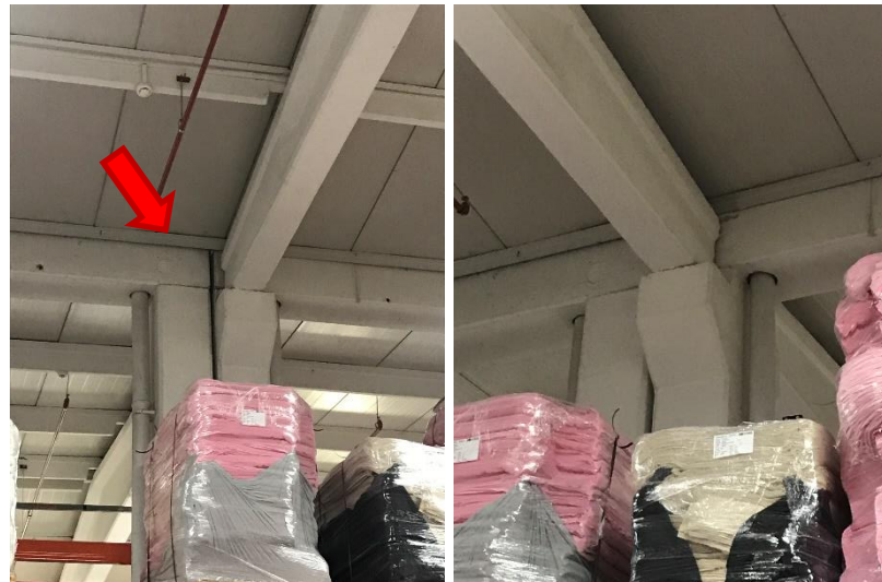
Şekil 3.24 : Binada bulunan deprem derzi ve çatı seviyesinde derz gerçekleştirilmemesi.
