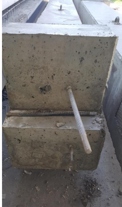
Şekil 3.14 : Prefabrike betonarme kolon elemanında uygun yerleştirilmeyen çatı kirişi pimi.
