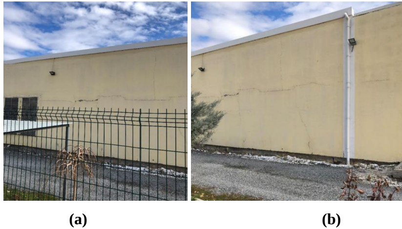
Şekil 3.38 : (a,b) Malatya 1. O.S.B., Tuğla duvarlarda oluşan çatlaklar.
