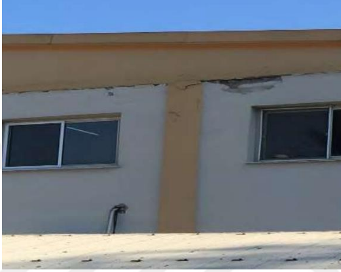
Şekil 3.39 : Hatıllar ile bölünmüş cephe duvarlarında sınır hasar (Yüksel ve diğ. 2020).
