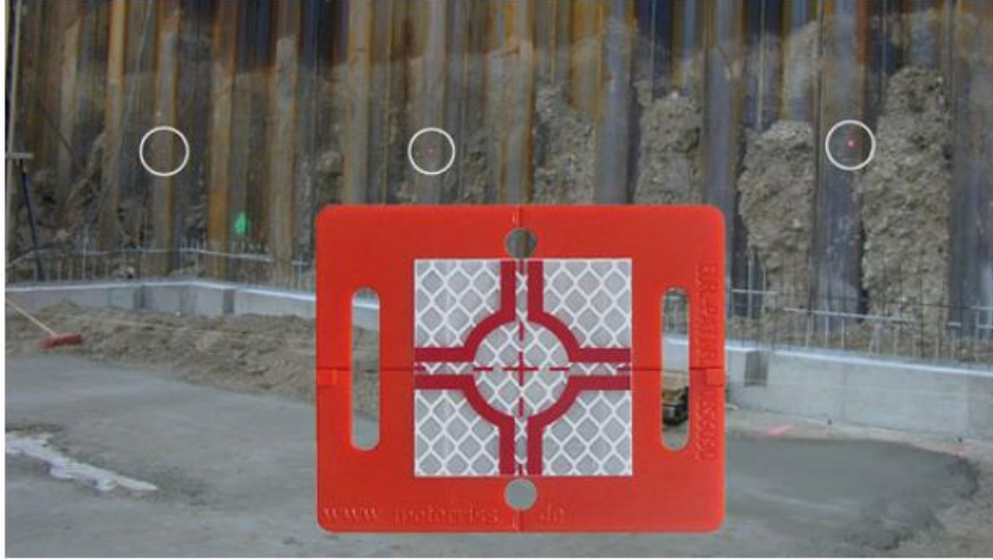
Şekil 4.11 : İksa perdesi üzerine yerleştirilmiş sabit reflektör bantları [25].
