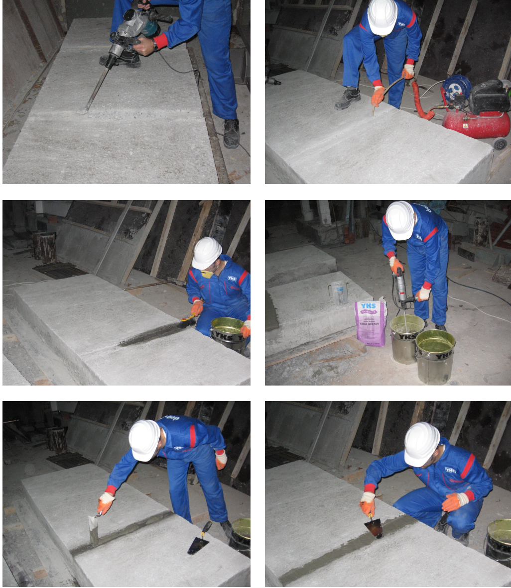
Şekil 2.14 Kalıp İzlerinden Kaynaklanan Bozuklukların Onarılması
