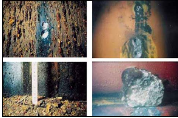
řekil 3.18: IDT’de Görülen ęeřitli Korozyon Örnekleri [1]
