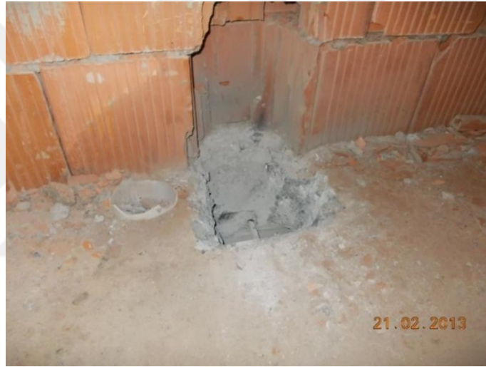
Şekil D.1 : Hatalı Uygulama/Taşıyıcı Sisteme Müdahale Görselleri-1.
