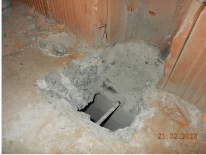
Şekil D.3 : Hatalı Uygulama/Taşıyıcı Sisteme Müdahale Görselleri-3.
