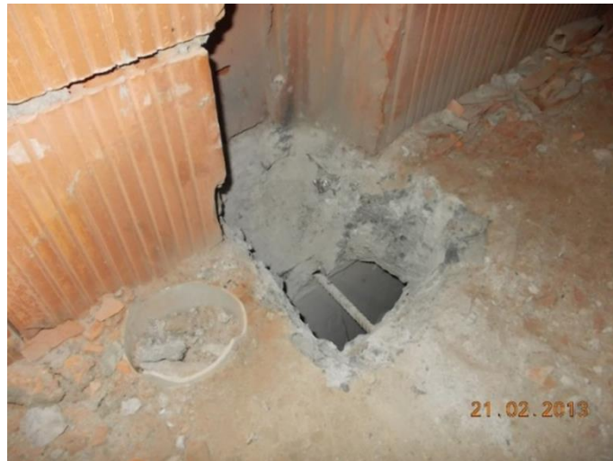
Şekil D.2 : Hatalı Uygulama/Taşıyıcı Sisteme Müdahale Görselleri-2.
