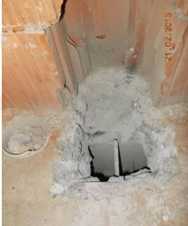
Şekil D.4 : Hatalı Uygulama/Taşıyıcı Sisteme Müdahale Görselleri-4.
