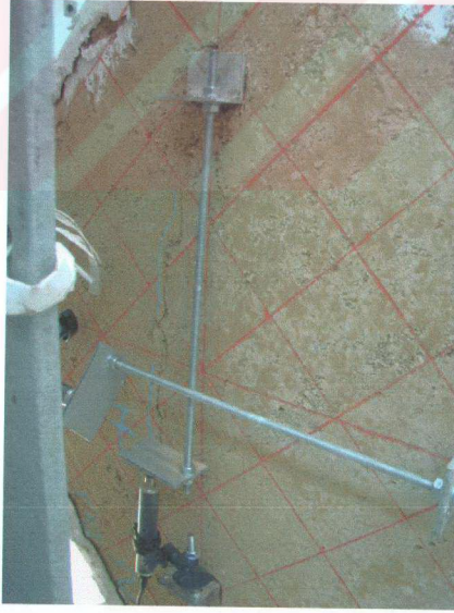
Şekil A.36. Numune 3'ün ön yüzünde 8 tonda oluşan çatlaklar
