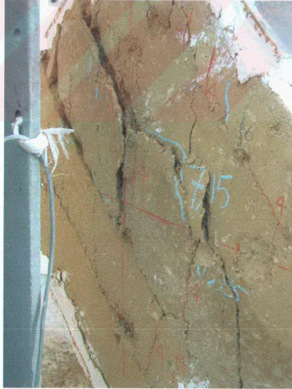
Şekil A.18. Numune 1'in ön yüzünde 10 tonda oluşan çatlaklar
