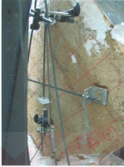
Şekil A.25. Numune 2'nin arka yüzünde 5.5 tonda oluşan çatlaklar
