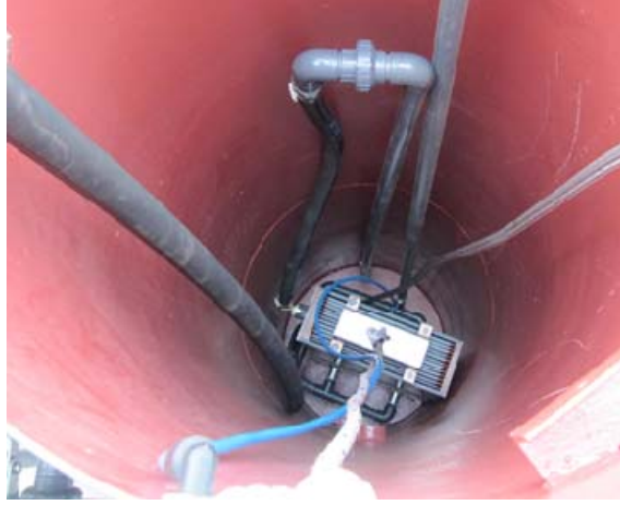
Şekil 3.11 : MBR-1 hava kabarcığı ile temizleme sistemi tank görünümü.
