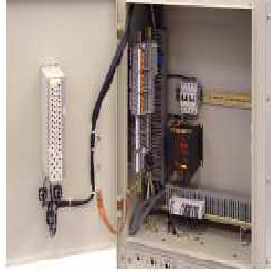
Şekil 2.8: Alçak gerilim dolabı bölümü.
