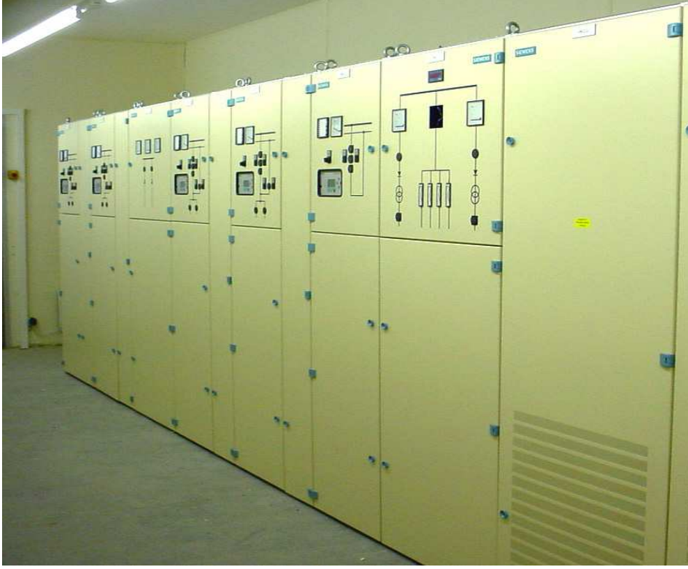
Şekil 2.17: Siemens'e DC şalt panosu örneği.
