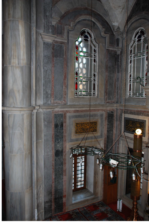
Şekil C.16: Mihrap alanı yan duvar yüzeyleri (Demir, 2009)
