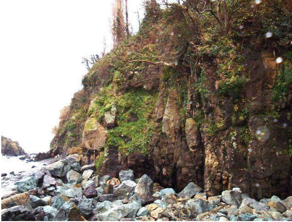
Şekil 4.16: İncelenen alanda km 163+260’ da bulunan dikey eğimli soğuma çatlakları.
