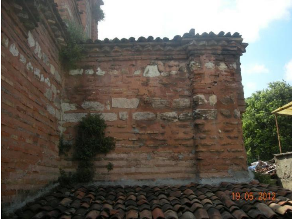
Şekil 4.82: Eğimli çatı üstündeki taş ve tuğla örgülü duvar parçası.
