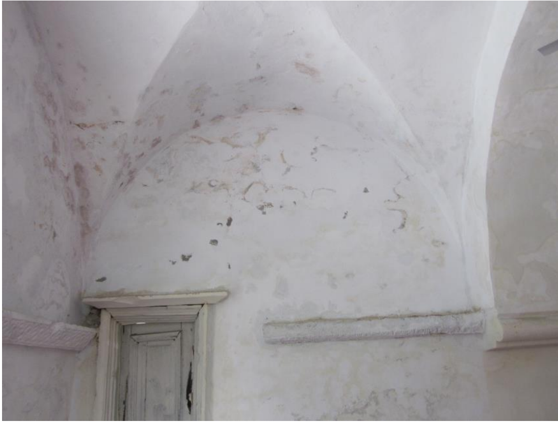
Şekil 6.5: Üst örtü problemi nedeniyle oluşmuş sıva ve boya dökülmeleri.
