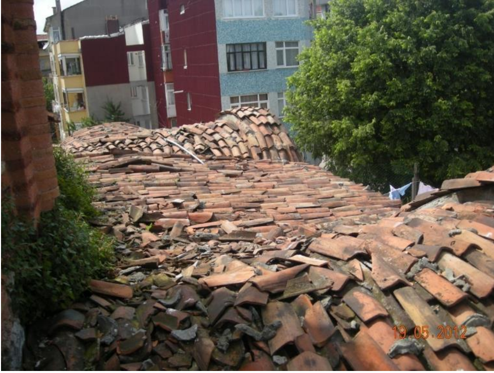
Şekil 4.89: Beton üstü alaturka kiremit kaplı parapetlerle alaturka kiremit kaplı çatı örtüsü (kiremitlerin çoğu kırılmış durumdadır).
