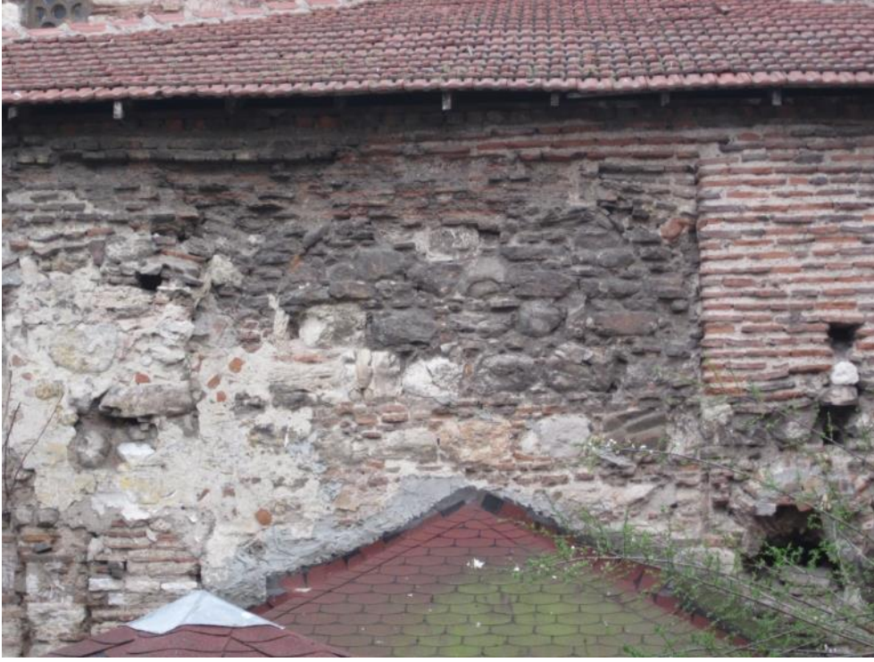
Şekil 4.48: Ahşap saçağın üst kısmındaki, düzensiz örgülü duvar.
