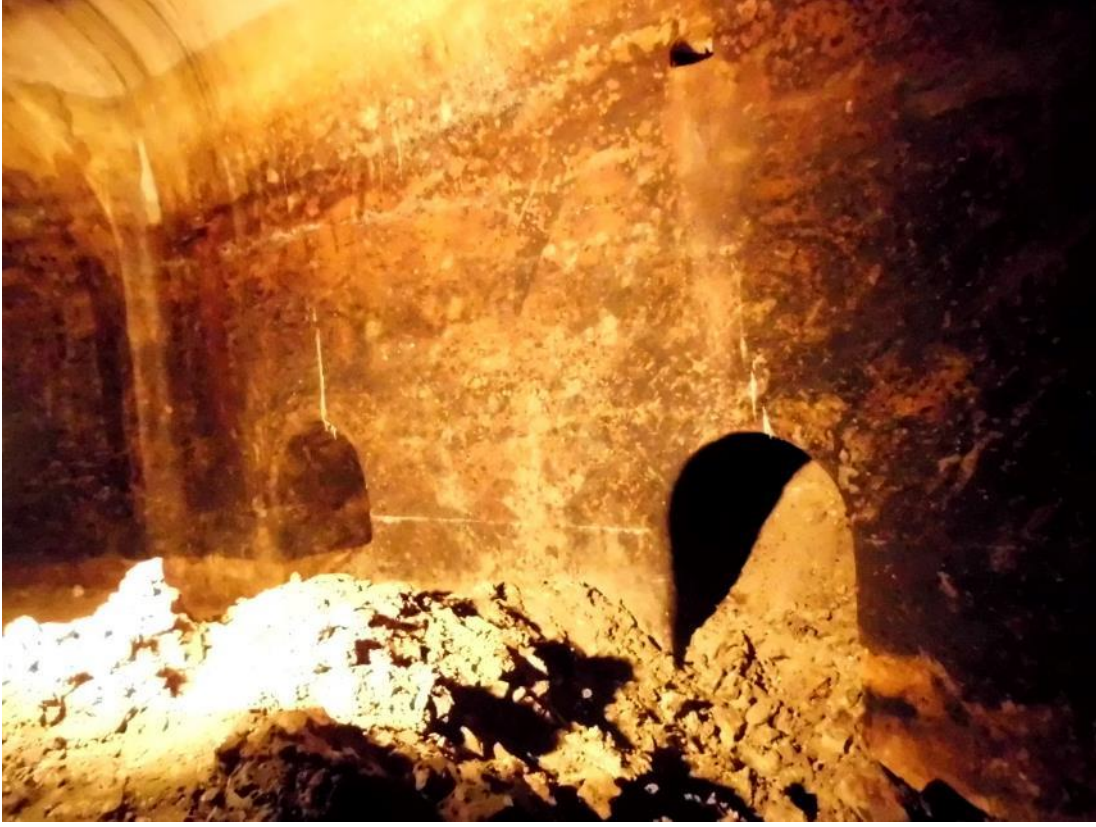
Şekil B. 62: Alt yapıda, cami mekânı altındaki odada toprakla dolmuş geçişler.
