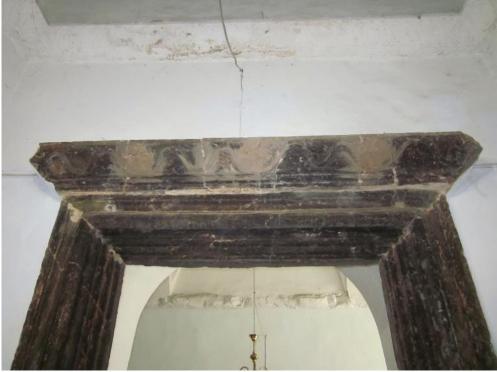
Şekil 4.4: Mevcut taş söveli kapının bugünkü durumu.
