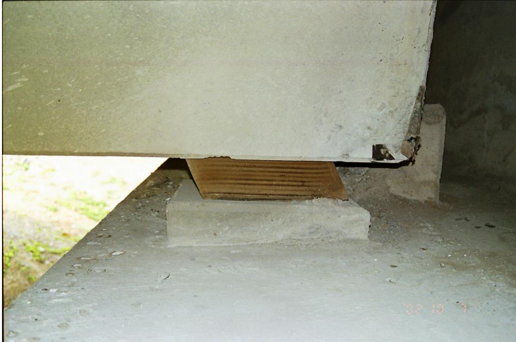
Şekil 1.3 Deforme olmuş elastomer mesnet
