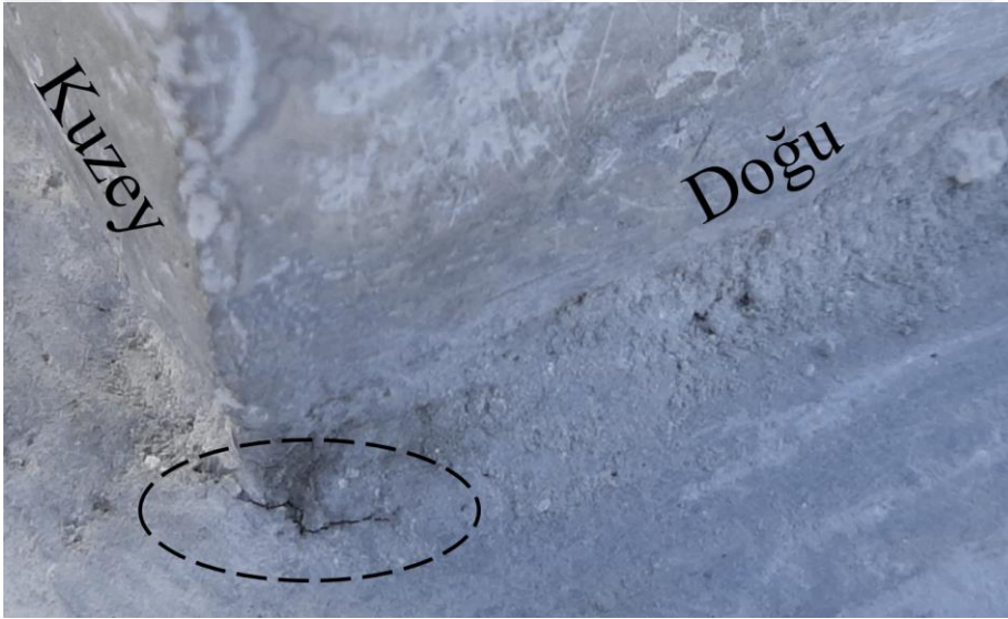
Şekil 3.2 : -0.0125 görel ötelemede kolon-temel birleşiminde mikro çatlak oluşumu.
