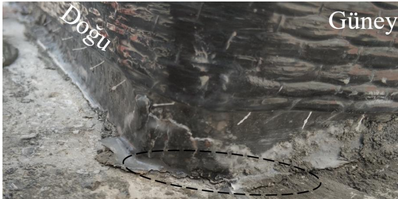
Şekil 3.11 : +0.01 görelî ötelemede kolon-temel birleşimde mikro çatlağın genişlemesi.
