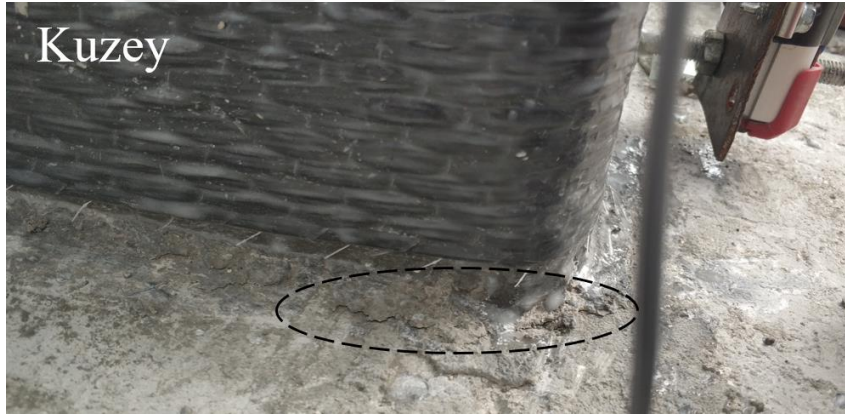
Şekil 3.10 : +0.075 görelî ötelemede kolon-temel birleşimde mikro çatlak oluşumu.
