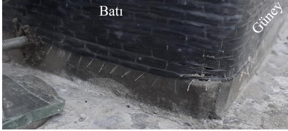
Şekil 3.29 : +0.025 görelî ötelemede kolon-temel birleşimde mikro çatlak oluşumu.
