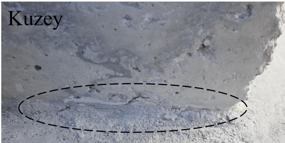
Şekil 3.3 : +0.025 görel ötelemede kolon-temel birleşiminde mikro çatlağın genişlemesi.
