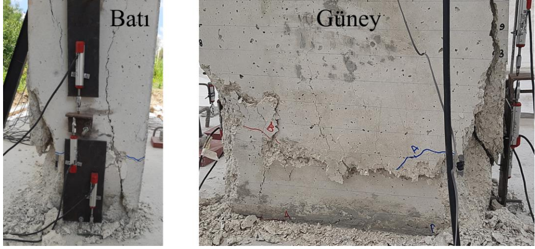
Şekil 3.26 : -0.075 görelî ötelemede kolon yüzeylerinde gelişen çatlaklar.
