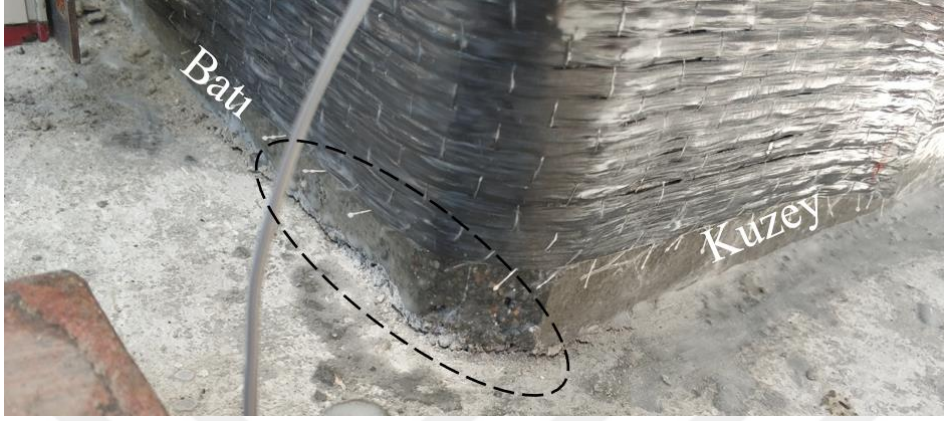
Şekil 3.17 : +0.075 görelî ötelemede kolon-temel birleşiminde mikro çatlak oluşumu.
