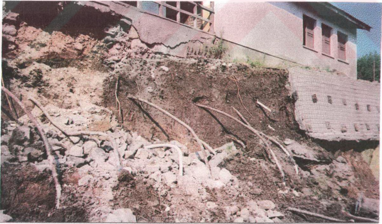
Fotoğraf 4.2 Topuk kazısı nedeniyle kaya saplamalı destek perdesi ve gerisinde Akveren Formasyonu içinde oluşan duraysızlıklar
