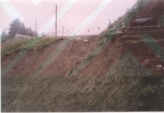
Fotoğraf 4.1 Taşaltı heyelan bölgesindeki kayma yüzeyinin genel görünüşü
