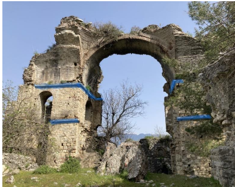
Şekil 6.3 : Dereagzı Kilisesi kornişleri (Ar, 2024'ten türetilmiştir)
