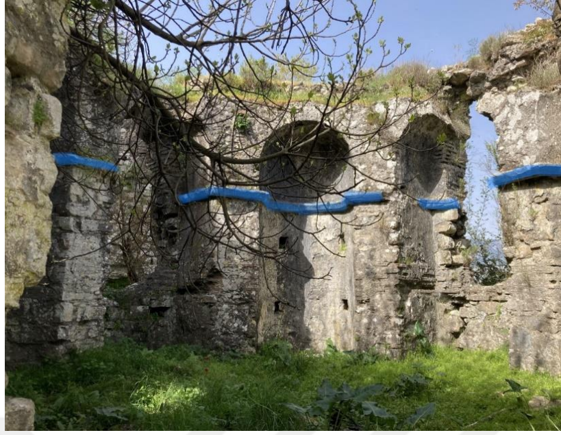
Şekil 6.5 : Dereagzı Kilisesi kornişleri (Ar, 2024'ten türetilmiştir)
