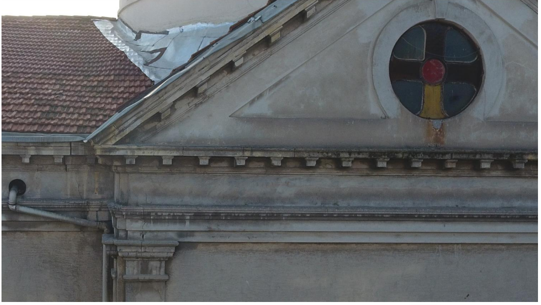
Şekil E.201 : Doğu cephe duvarında yer alan dairesel penceredeki ve pencere altındaki pas izi.
