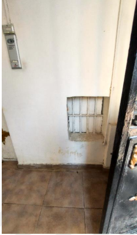
Şekil E.69 : Bodrum katta yer alan kapatılmış durumdaki pencere açıklığı.
