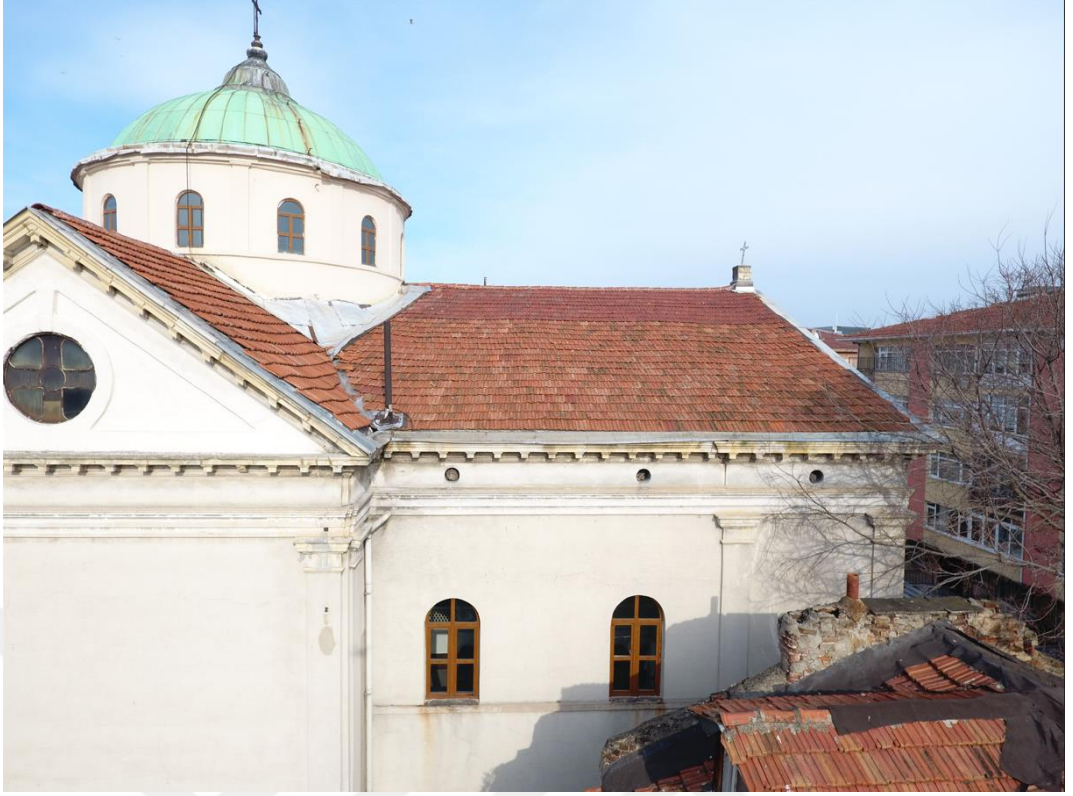
Şekil E.193 : Kubbedeki ve batı cephesindeki pvc doğramalı pencereler.
