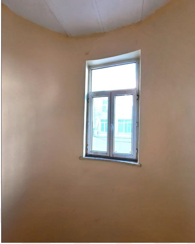
Şekil E.71 : A Z04 kodlu merdivenin kuzey duvarında yer alan pvc doğramalı pencere.
