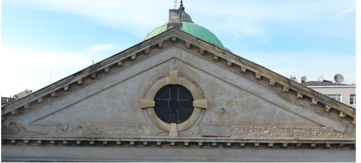
Şekil E.134 : Sıva dökülmesi sonucu açığa çıkan moloz taş örgü.
