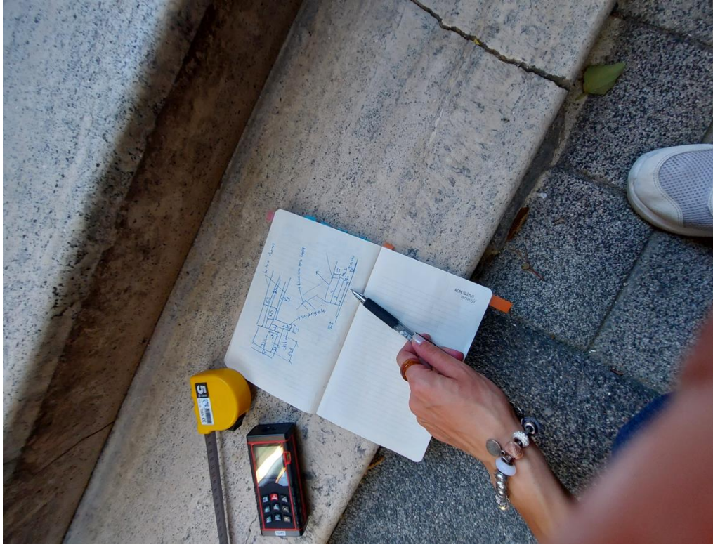
Şekil E.190 : Kilisenin ön bahçesindeki kesme taş basamaklarda yer alan çatlak.
