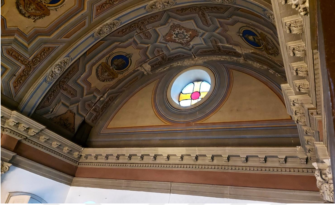
Şekil E.131 : Tavandaki dökülmeler sonucunda açığa çıkan demir putreller.
