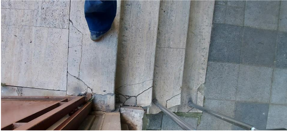
Şekil E.192 : Kilisenin ön bahçesindeki basamaklarda çimento esaslı malzeme ile yapılan tamamlamalar.
