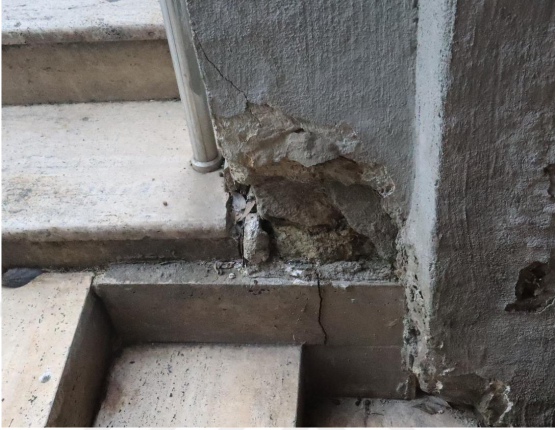
Şekil E.197 : Kilisenin bahçe duvarında meydana gelmiş olan malzeme kaybı.
