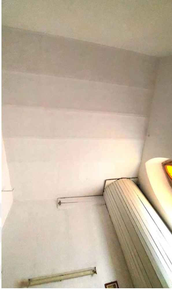
Şekil E.125 : K Z07 sakristi mekanı tavanındaki demir putrel izleri
