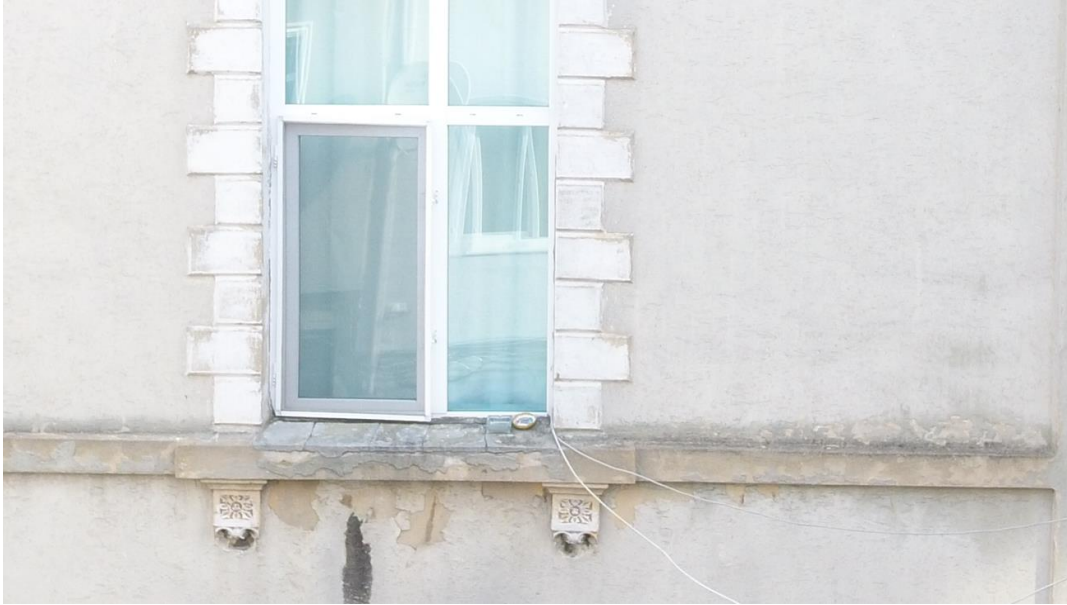
Şekil E.200 : Kuzey cephe duvarındaki sıva dökülmeleri.
