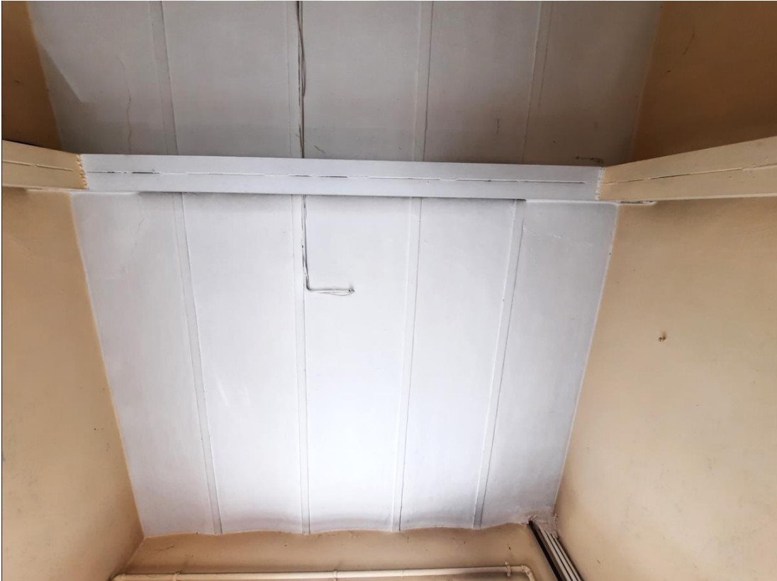
Şekil E.132 : A Z02 oda mekan tavanı ve mekanda güçlendirme amacıyla yapılmış olan çelik kolonlar ve kiriş.
