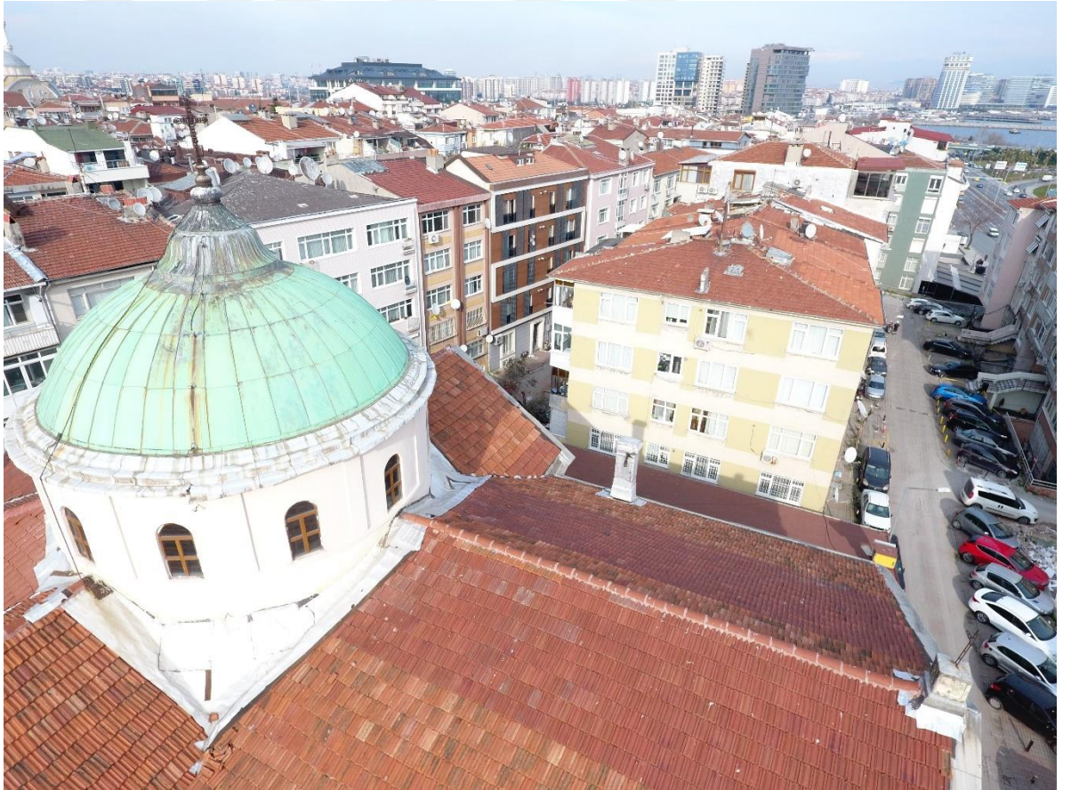
Şekil E.14 : Kubbede yer alan 11 adet ahşap görünümlü kemerli formda pvc pencere.
