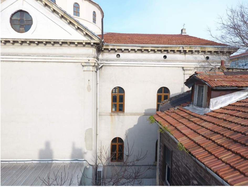
Şekil E.191 : Kilisenin batı cephesindeki çimento uygulamaları.
