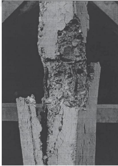
Şekil 2.20 : Köşe dökülmesi (Connolly, 1994)
