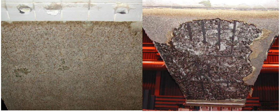
Şekil 2.22 : Sol tarafta 180 ve sağ tarafta 120 dakikalık yangına maruz kalmış polipropilen lifle imal edilmiş termal bariyerli yapı elemanları
