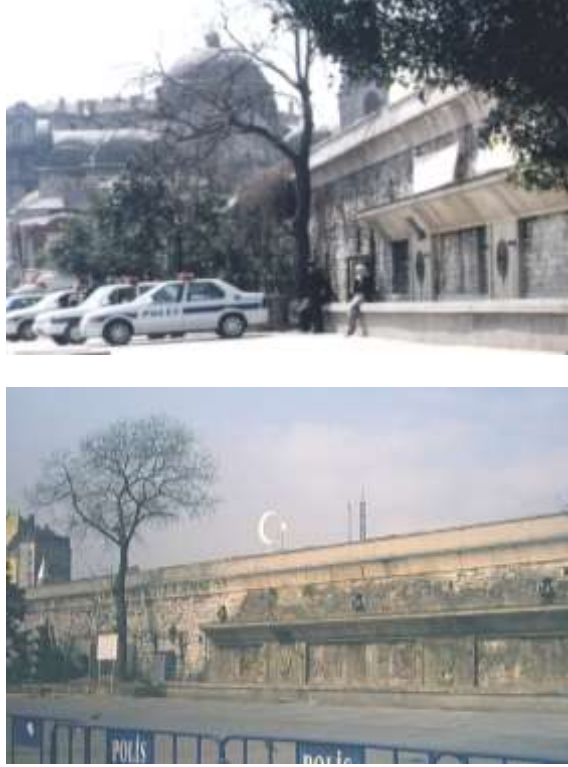
Şekil 5 14: Duvar yüzeyi'nin 1995'teki ve bugünkü durumu
