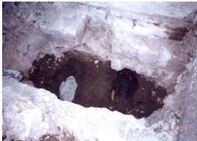
Şekil D5. Eğitimi binası ön cephe muayene çukuru, temel in sıklığı ve ayrılmış ahşap kazıklar görülüyor.
