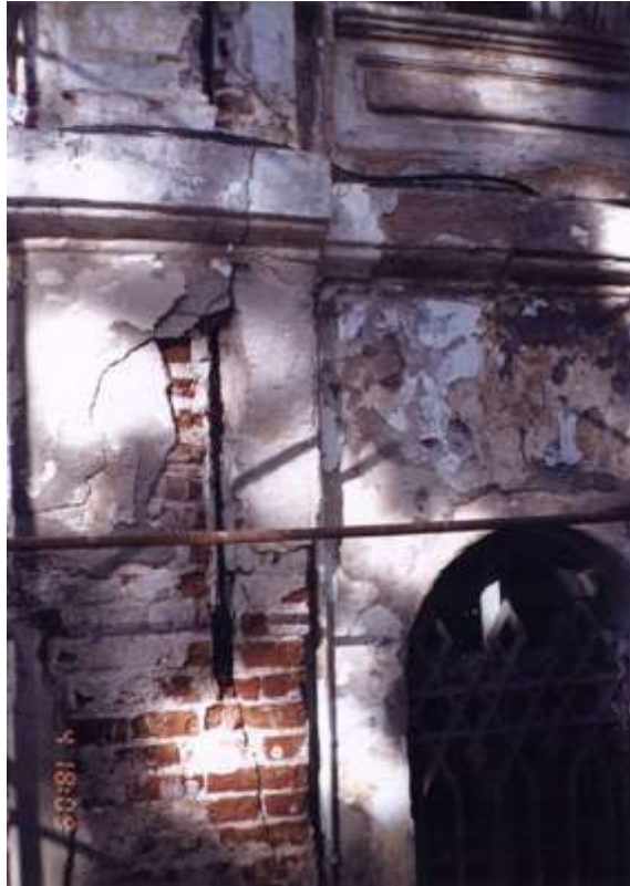
Şekil D9. Kabataş Erkek Lisesi Eğitim Binası ön cephe taşıyıcı duvarlarda çatlaklar
