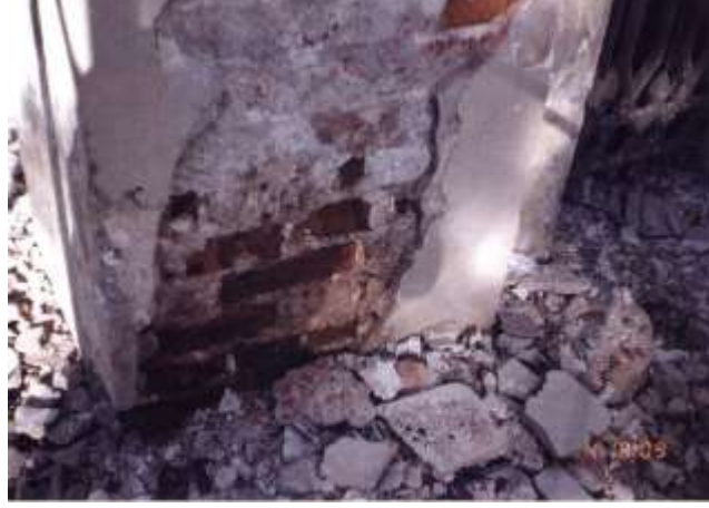
Şekil D10. Tuğlalarda aşırı ayrışma
