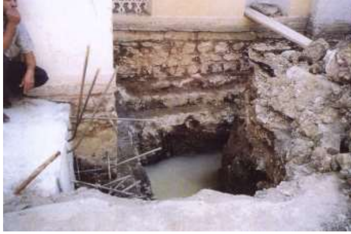
Şekil D13. Yetersiz temel derinliği, kötü temel malzemesi, olumsuz zemin yapısı ve temel altında sıkıştırma kazıkları
