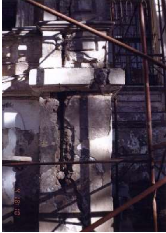
Şekil D8. Kabataş Erkek Lisesi Eğitim Binası arka cephe taşıyıcı duvarlarda çatlaklar
