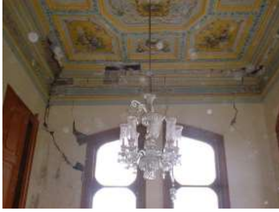
Şekil 4.4 İç duvarlarda oluşan hasarlar
