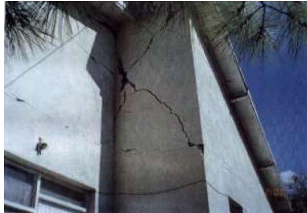
Şekil 4.10. Köşekalkan duvarlarda oluşan çatlaklar
