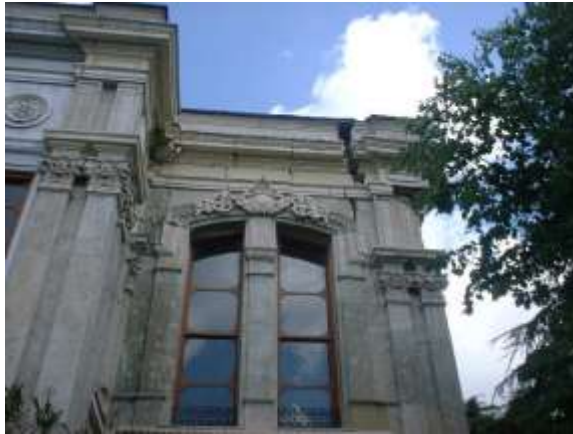
Şekil 4.1. Dış cephe duvarlarında oluşan hasarlar
