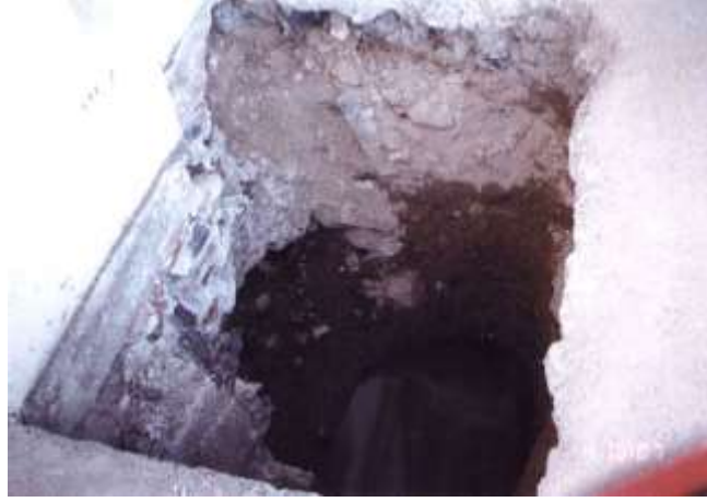
Şekil D4. Güneybatı cephesi muayene çukuru, temel in sıklığı, alttaki dolgu zeminini ve ahşap kazıklarının çürüdüğü gözleniyor.
