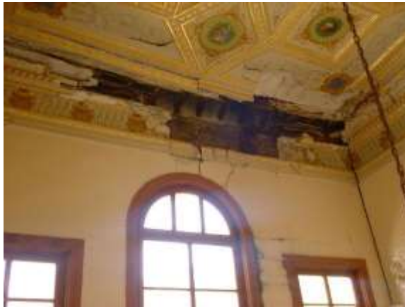
Şekil 4.5. Ahşap döşemelerde oluşan hasarlar
