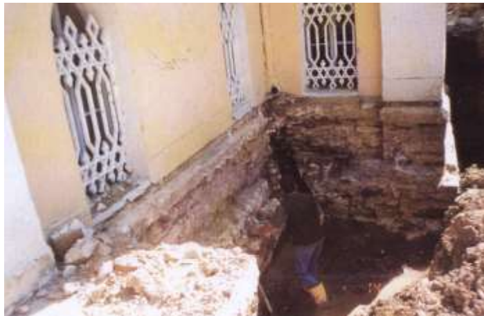
Şekil D14. Eğitimi Binası Kuşaklama Perdesi Kazısı; yetersiz temel derinliği, kötü temel malzemesi ve heterojen temel yapısı
