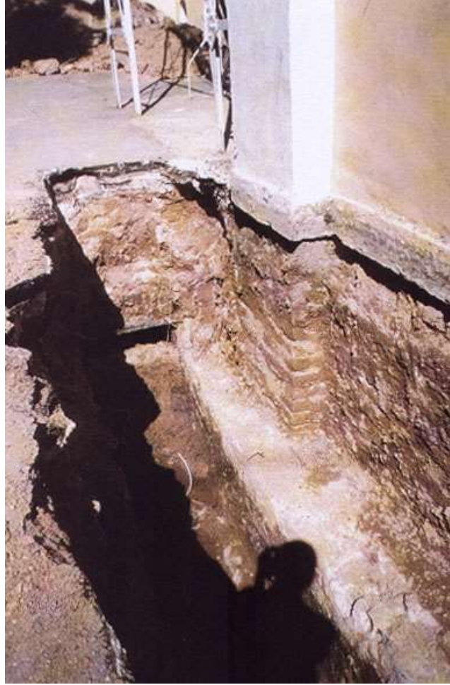
Şekil D11. Eğitimi Binası Arka Cephe Kuşaklama Perdesi kazısı; temellerin karınışık yapısı, elle ufalanabilecek derecede kötü durumdaki tuğla temel malzemesi
