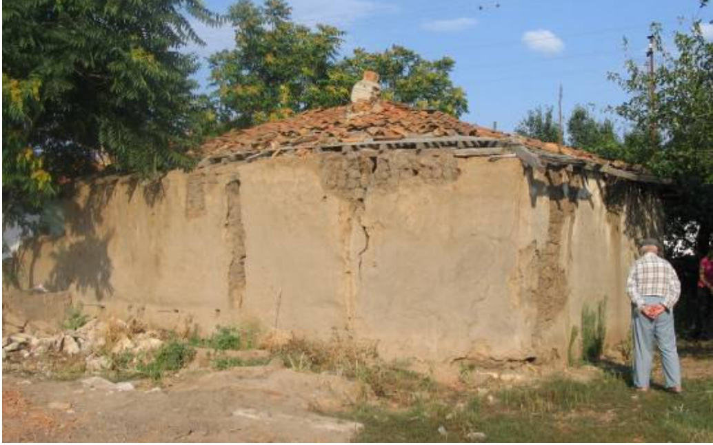
Şek.C2.5D/5. [39.1.8/1] no'lu evin kuzeybatı cephesi ve önünde ahır kısmının molozu
