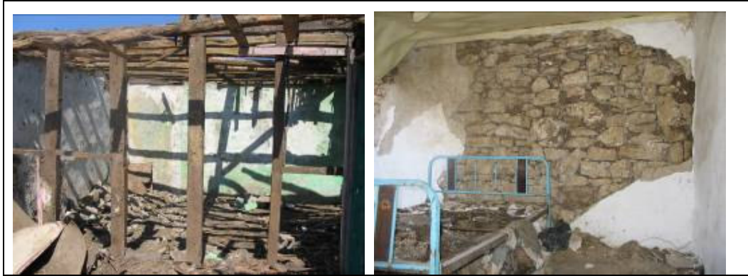
Şek.C2.3F/6. Yıkık durumdaki bir evin ahşap karkas taşıyıcı sistemi ve taş duvar örgüsü
