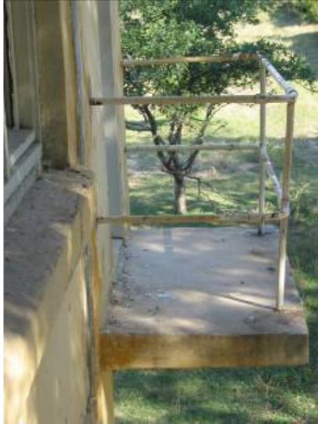
Şek.C2.3D/31. [39.7/5] no'lu numune fidanlık binasının güney cephesindeki balkon
