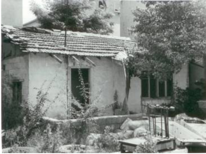
Şek. C3B/23. Doğu kanadı yıkılarak yerine apartman yapılan [59.03.064] no'lu ikiz ev
