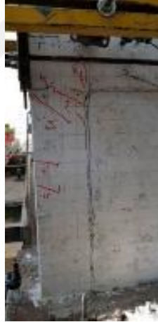
Şekil 4.147 : +13.52 mm itme çevrimi batı cephesi
