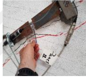
Şekil 4.88 : -9.04 mm çekme çevrimi duvarda oluşan X kesme çatlağı
