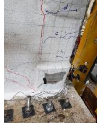
Şekil 4.86 : +9.04 mm itme çevrimi batı cephesi
