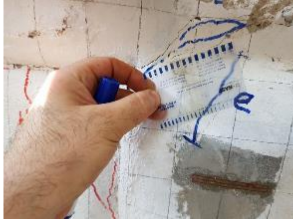
Şekil 4.132 : TRM üzerinde meydana gelen kesme çatlağı w=0.3 mm
