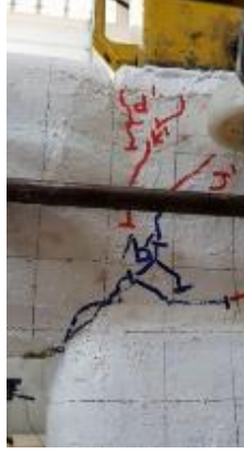
Şekil 4.107 : +13.52 mm itme çevrimi doğu cephesi
