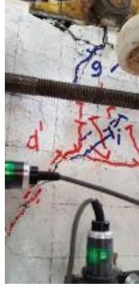
Şekil 4.108 : +22.54 mm itme çevrimi doğu cephesi
