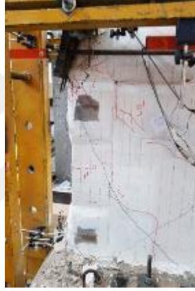
Şekil 4.130 : Numune 7 ileri hasar batı cephesi, TRM sargı üzerinde meydana gelen kesme hasarları
