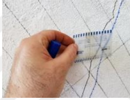
Şekil 4.127 : + 3.58 mm itme çevrimi duvarda meydana gelen b diyagonal kesme çatlağı w=1.1 mm olmuştur.
