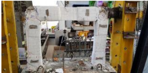
Şekil 4.176 : Numune 9 ileri hasar batı cephesi
