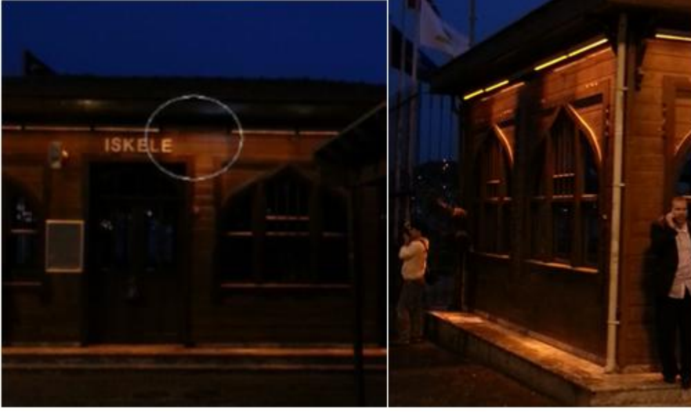
Şekil 4.25 : Armatürün yanlış yönlendirilmesi (sol) ve arıza durumu (sağ) (Fotoğraf: B. Alişan, 2013).
