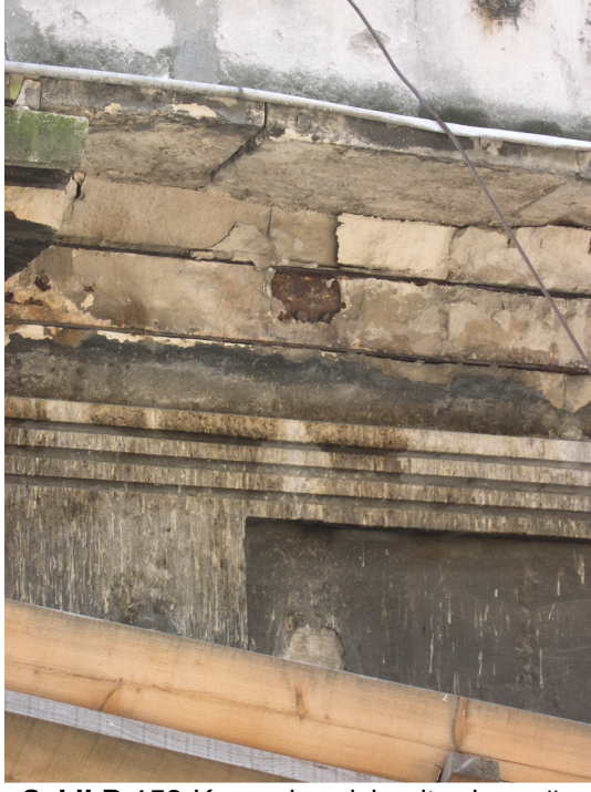
Şekil D.158: Kopan kornişin altında açığa çıkmış I profil (Kurt,2008).
