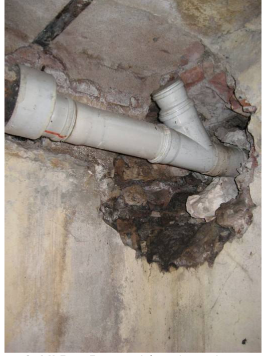
Şekil D.6: B.02 mekânında, tesisat yenilenirken kırılan duvar(Kurt,2008).
