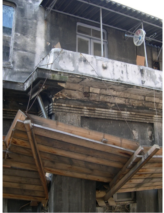
Şekil D.153: Kornişte meydana gelen hasar-payandalar ve I profil (Kurt,2008).
