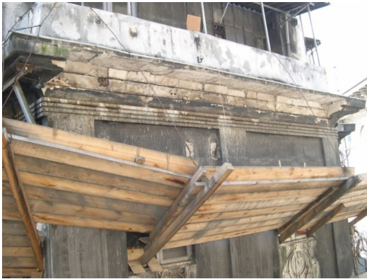
Şekil D.152: Kornişte meydana gelen hasar- askı sistemi (Kurt,2008).
