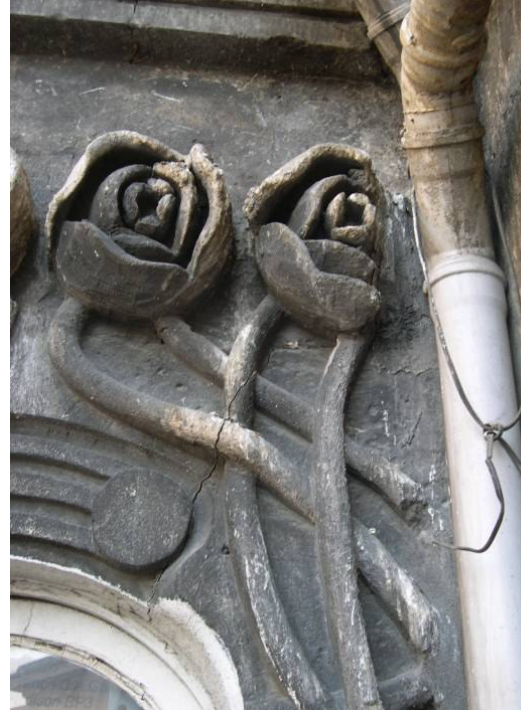
Şekil D.157: 3.05.02 mekânı- Bezemelerdeki hasar (Kurt,2008).
