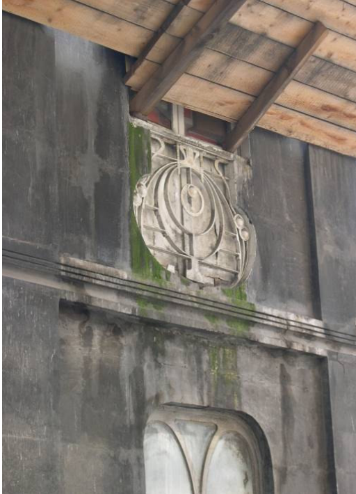
Şekil D.156: Muhzırbaşı Sokak cephesi- yosunlanma (Kurt,2008).
