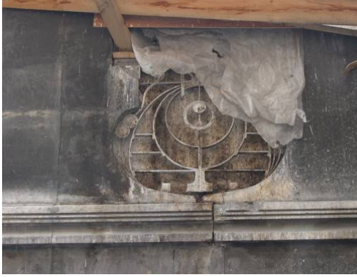
Şekil D.154: Muhzırbaşı Sokak cephesi- cephe askısının doğramalarda oluşturduğu hasar (Kurt,2008).
