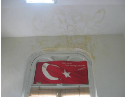
Şekil D.43: 2.07 mekânı- su almış duvar ve tavan(Kurt,2008).
