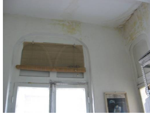
Şekil D.155: 2.07 mekânı- rutubet problemi (Kurt,2008).
