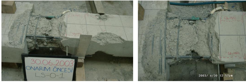
Şekil 3.13. LS-O-1 Numunesinin Onarım Öncesi Durumu
