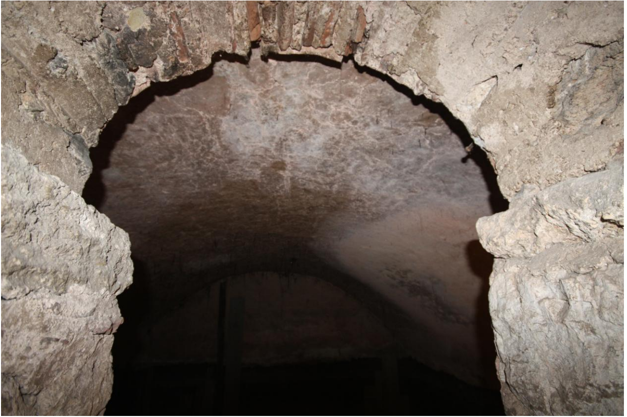
Şekil B.80: Z-04 mekânının doğu duvarında bulunan delik.
