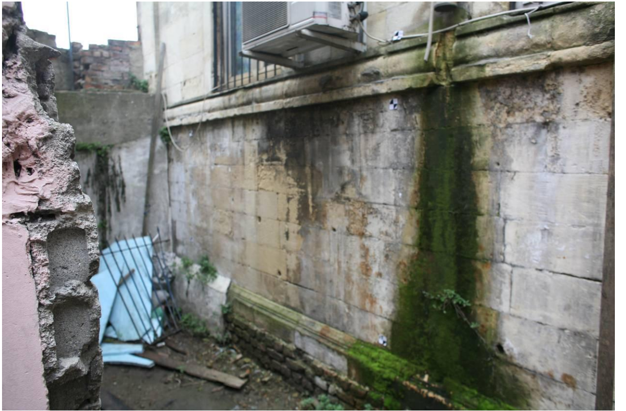
Şekil B.234: Caminin güneydoğu cephesinde görülen kirlenme ve bitkilenme.
