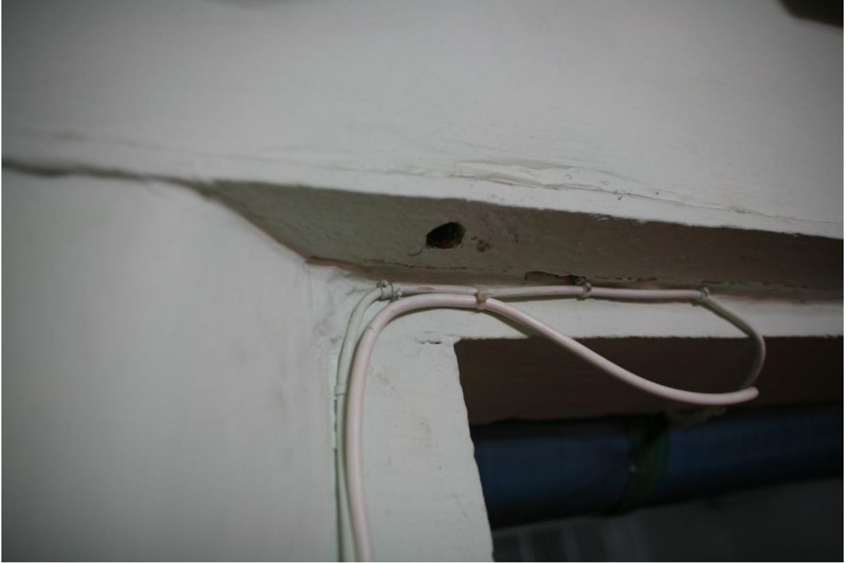
Şekil B.68: Z-03 mekânı kuzeybatı duvarındaki açıklıkta bulunan ahşap lento.
