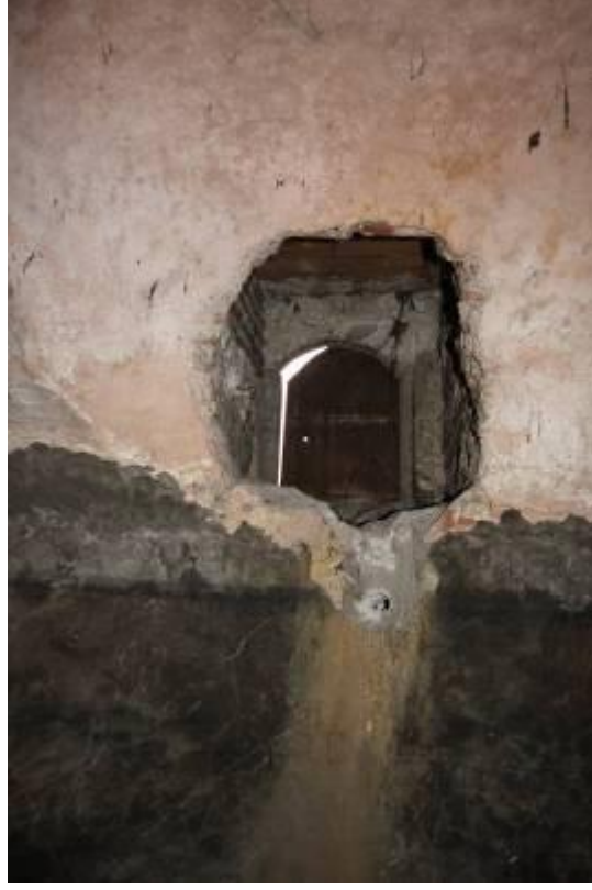
Şekil B.87: Z-06 mekânının kuzey duvarında bulunan delik.
