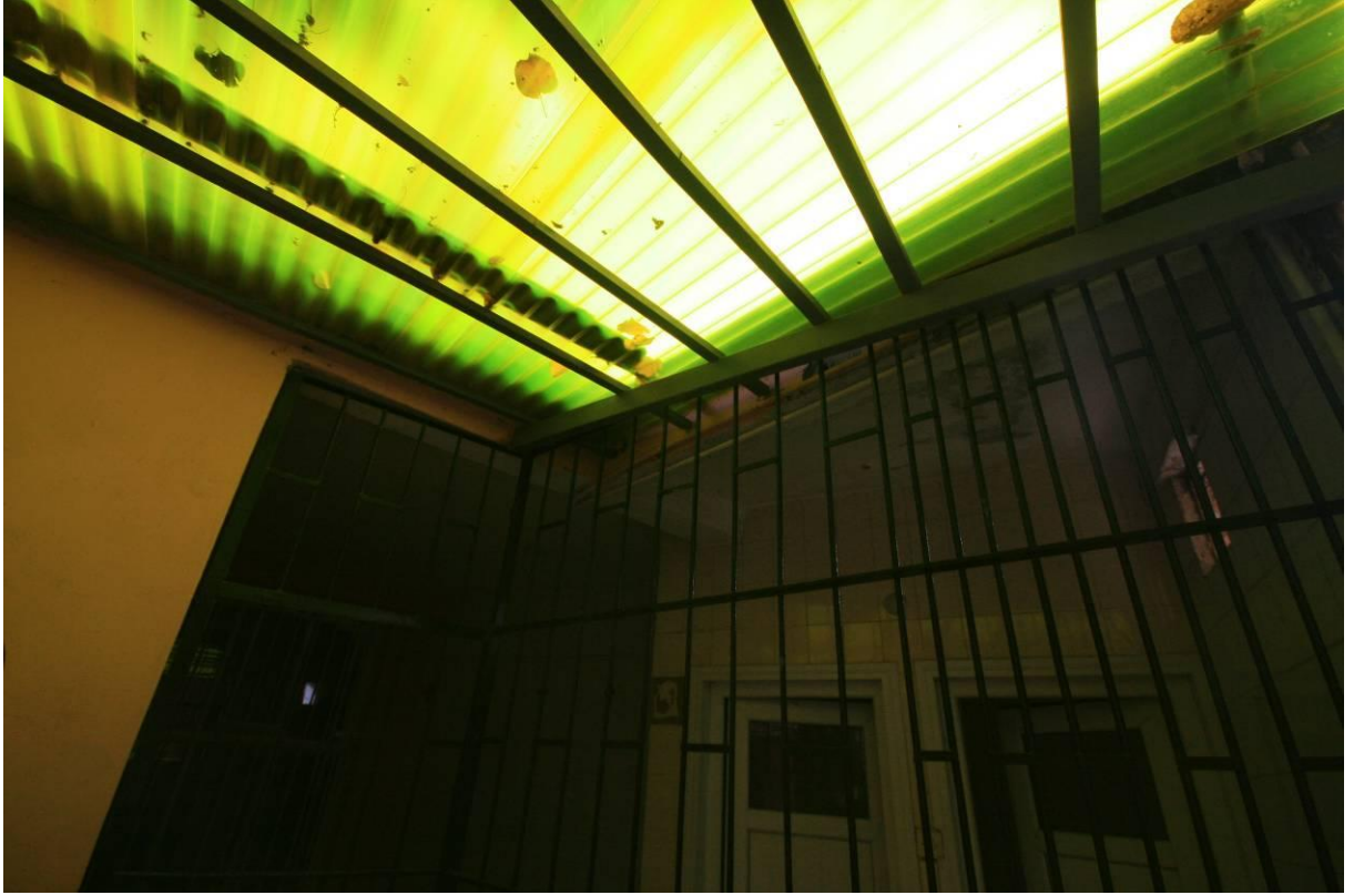
Şekil B.229: Avluyu kapatan plastik örtü.
