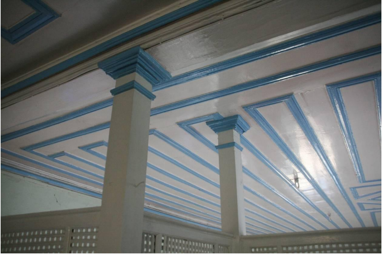
Şekil B.128: 1-01 mekânındaki ahşap direklerin, ahşap tavan ve kirişle birleşimi.
