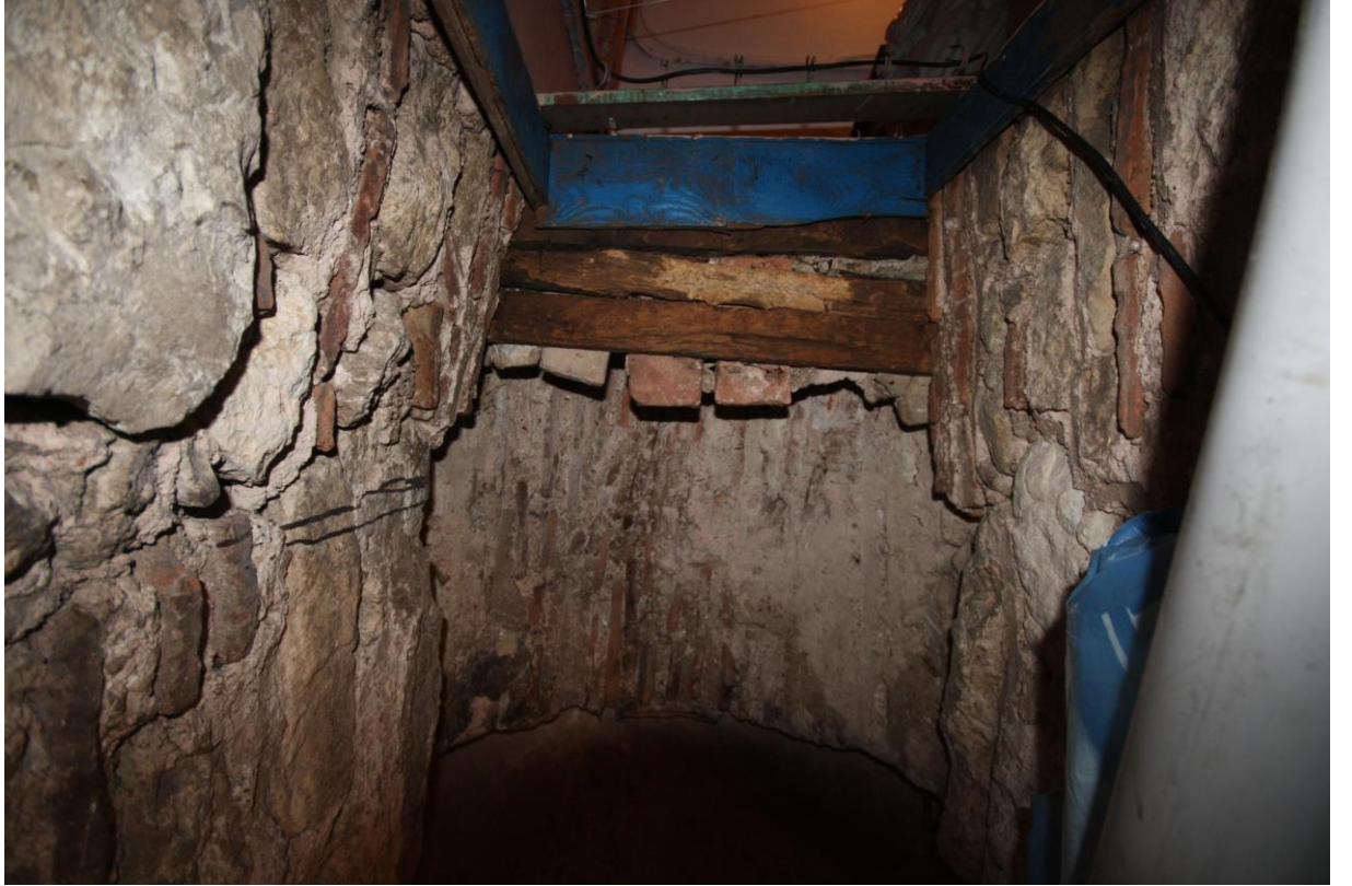
Şekil B.82: Z-06 mekânının batı duvarında bulunan delik.
