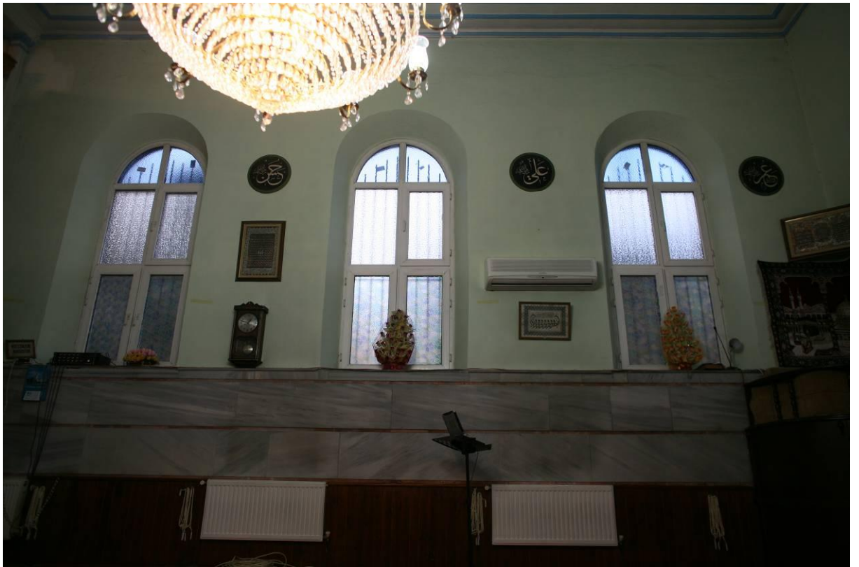
Şekil B.226: Duvarlardaki tesisat ve klima üniteleri.
