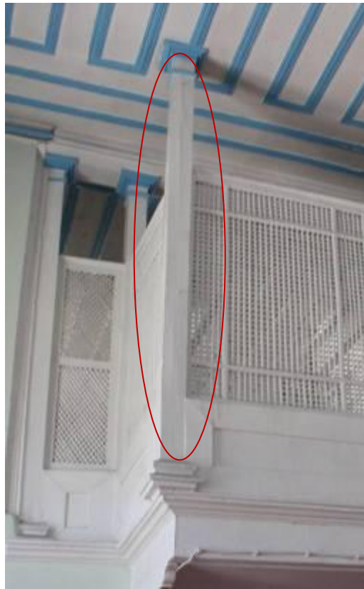
Şekil B.230: Kadınlar mahfilindeki ahşap direklerde oluşmuş strüktürel çatlaklar.
