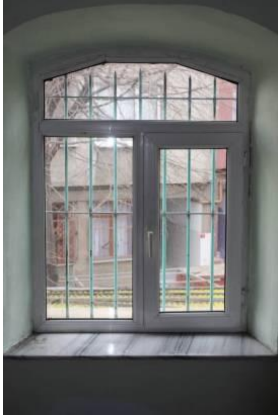
Şekil B.227: 1-01 mekanında bulunan niteliksiz pvc doğrama.
