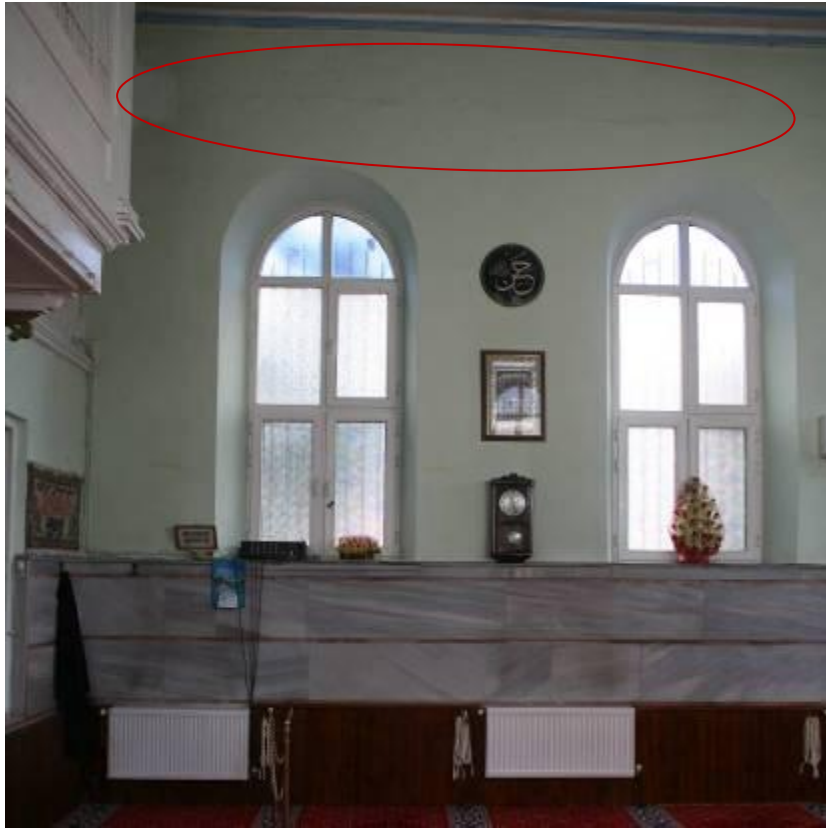
Şekil B.232: Z-03 mekanının kuzeydoğu duvarında görülen rutubet.
