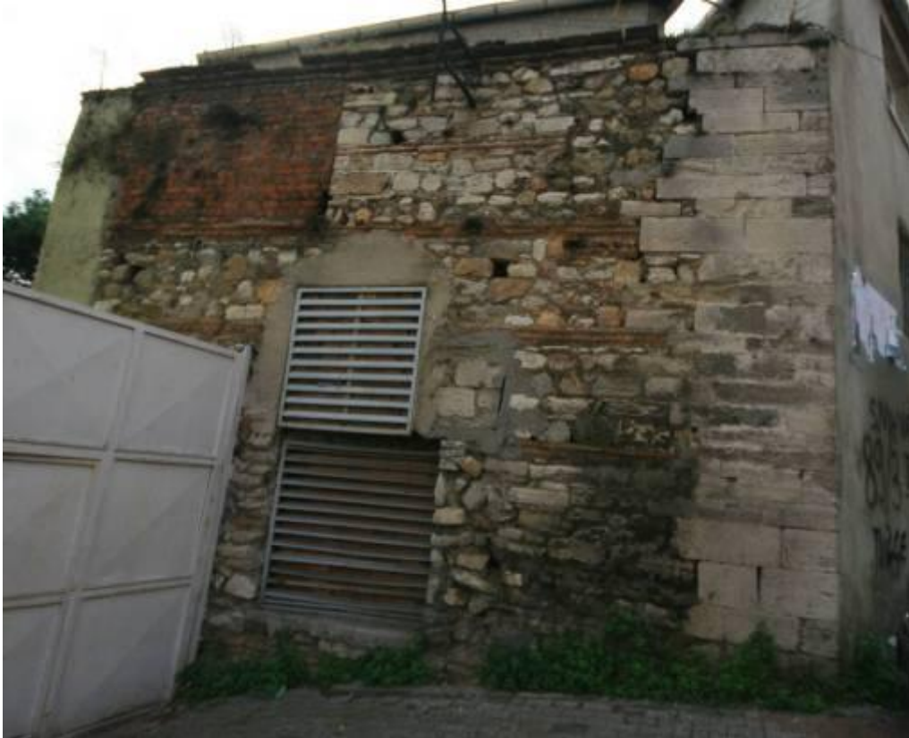
Şekil B.236: Lojmanın doğu cephesinde görülen kirlenme ve bitkilenme.
