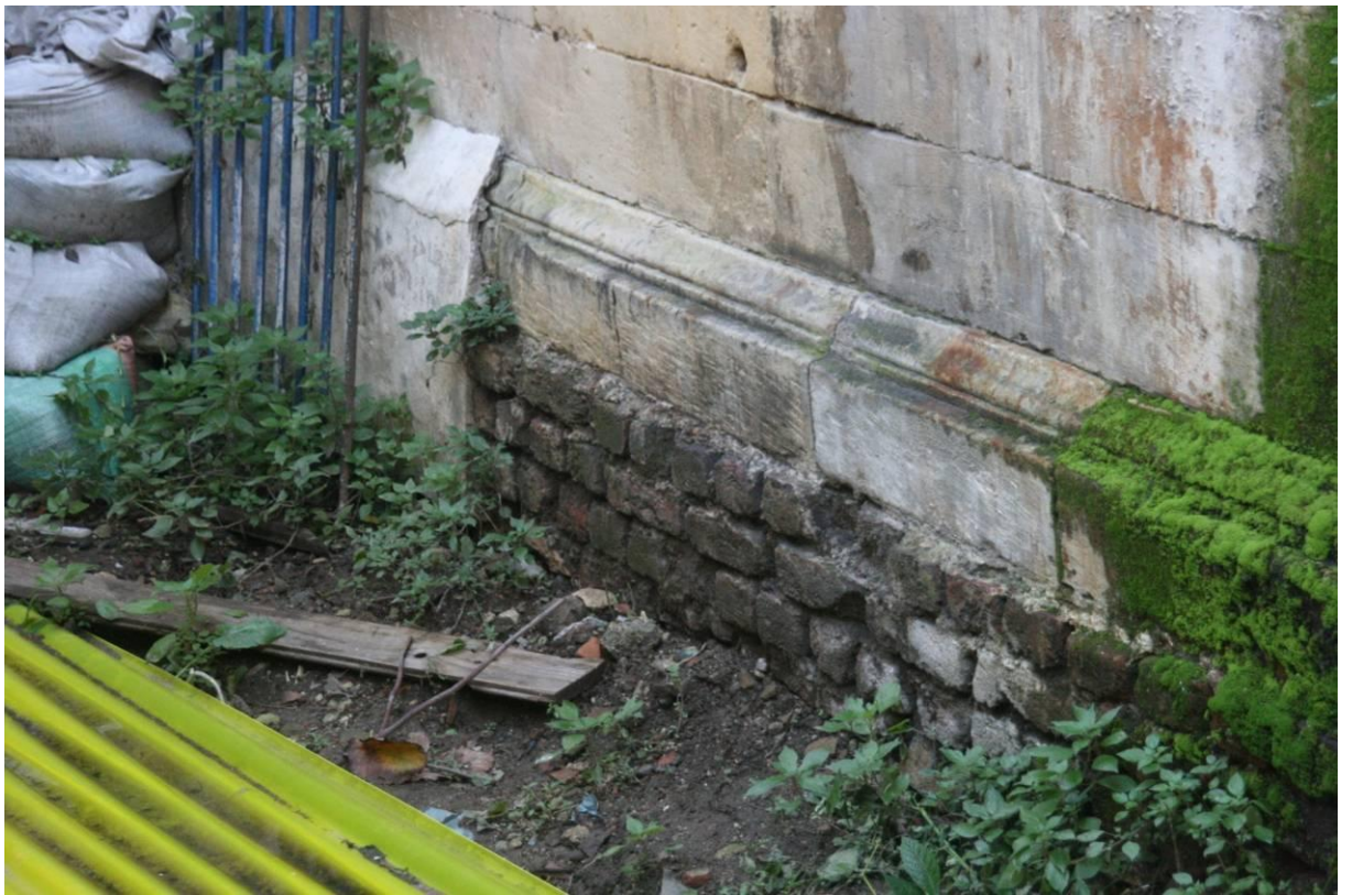
Şekil B.166: Caminin kuzeydoğu cephesinde açıkta kalmış tuğla kısım.
