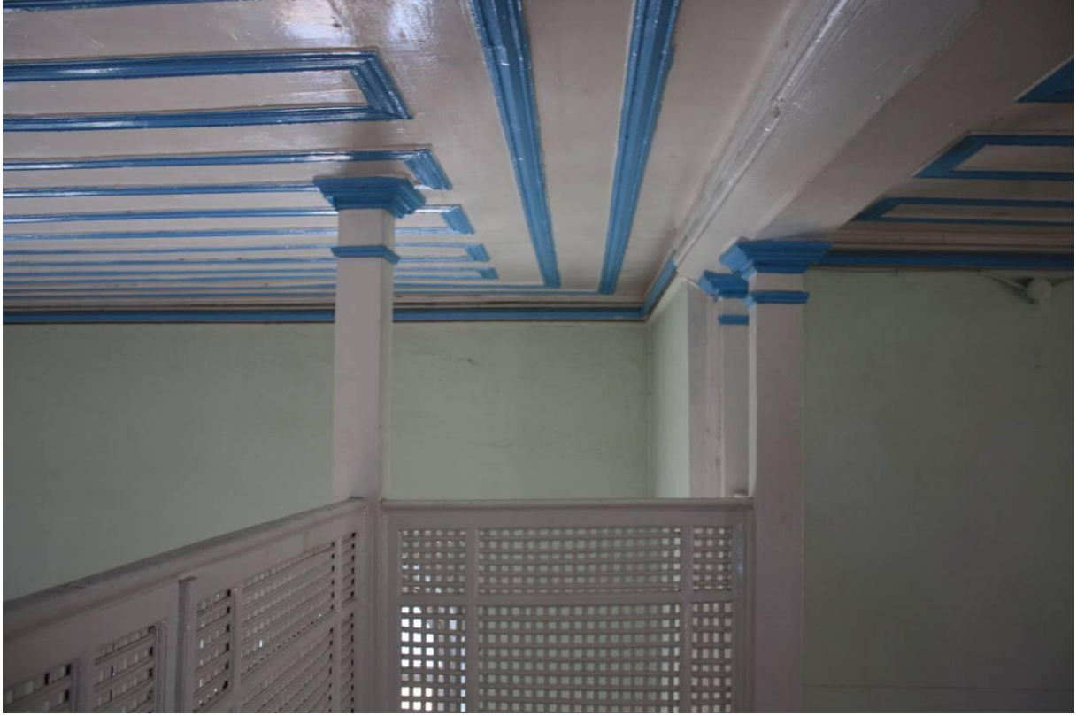
Şekil B.129: 1-01 mekânındaki ahşap direklerin, ahşap tavan ve kirişle birleşimi.
