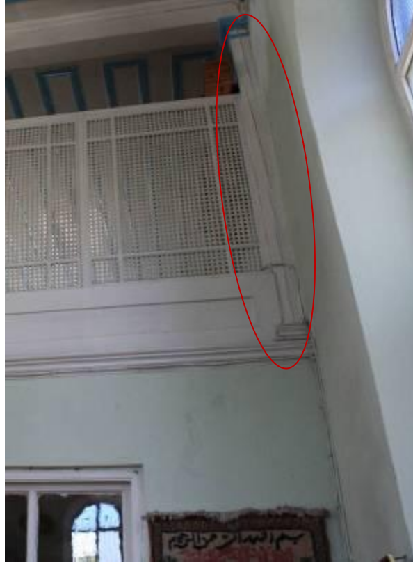
Şekil B.231: Kadınlar mahfilindeki ahşap direklerde oluşmuş strüktürel çatlaklar.
