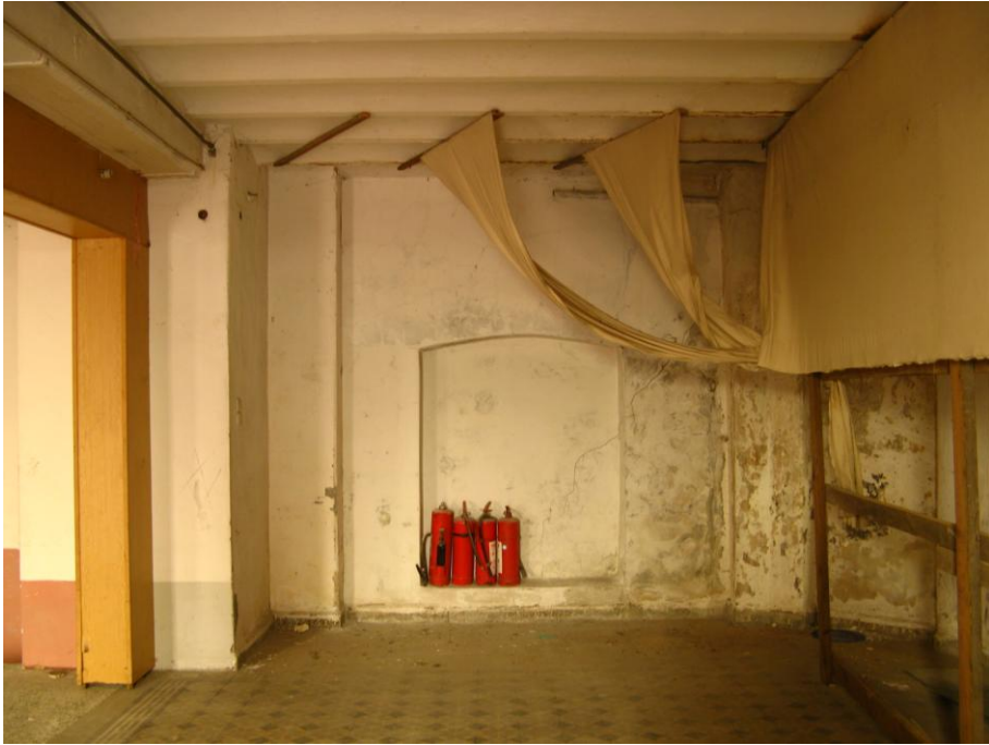
Şekil 3.128: B-01 Mekânı sahne bölümünde görülen strüktürel çatlak.
