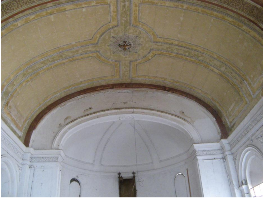
Şekil 3.132: Apsis kemerinde üzeri boyanmış kalem işleri ve strüktürel çatlaklar.
