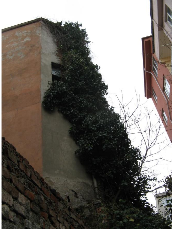
Şekil 3.129: Şapelin batı cephesinde görülen bitkilenme.
