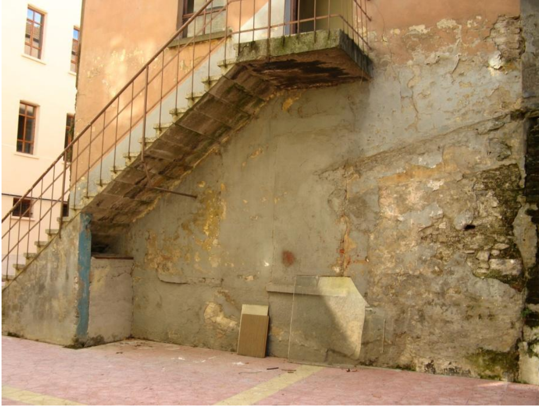
Şekil 3.136: Şapel binası kuzey duvarı üzerindeki sıvada rutubete bağlı bozulma.
