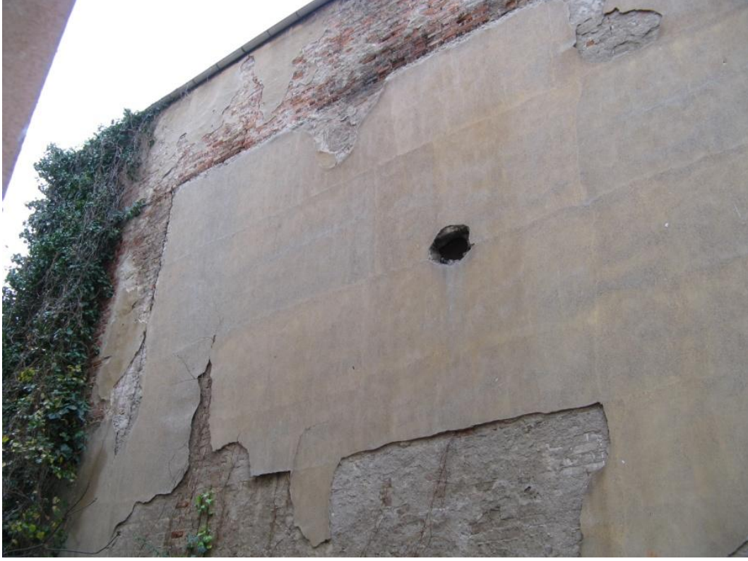
Şekil 3.127: Şapel batı duvarı üzerinde görülen delik.
