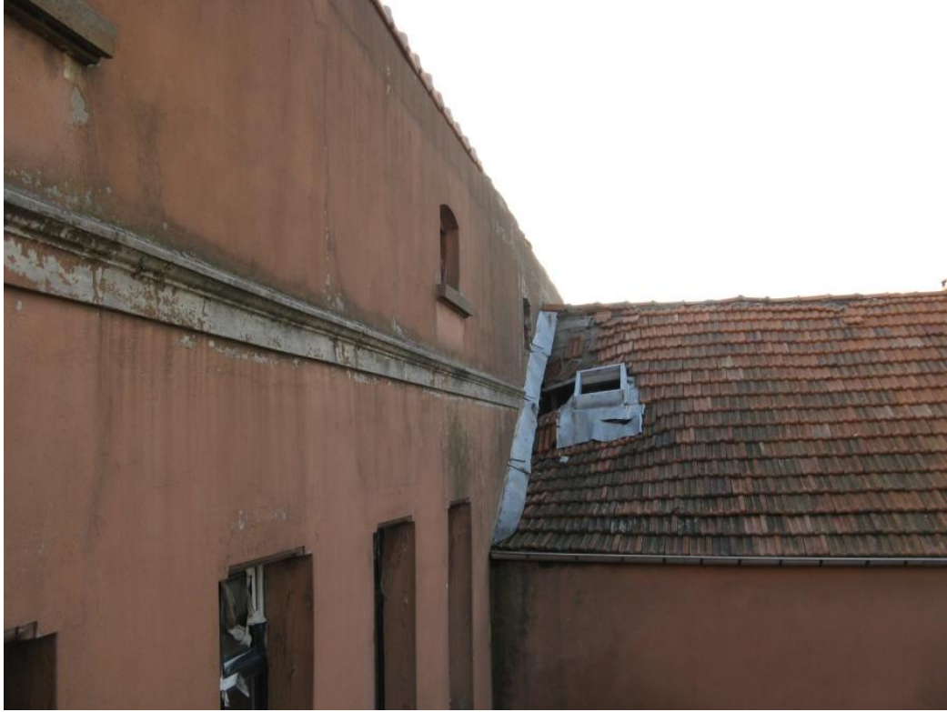
Şekil 3.134: Şapel çatısı üzerinde görülen çökme.
