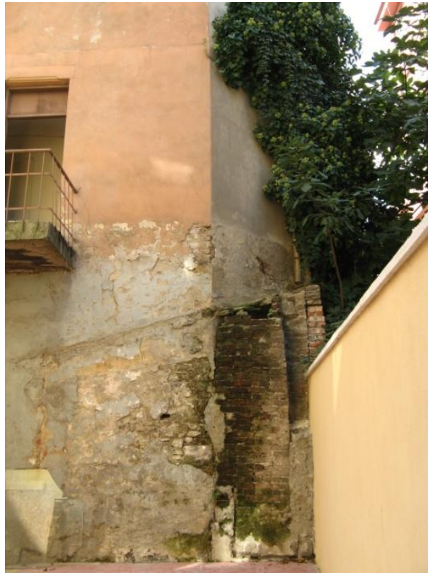
Şekil 3.104: Kuzey Cepheye sonradan eklenmiş niteliksiz duvar.
