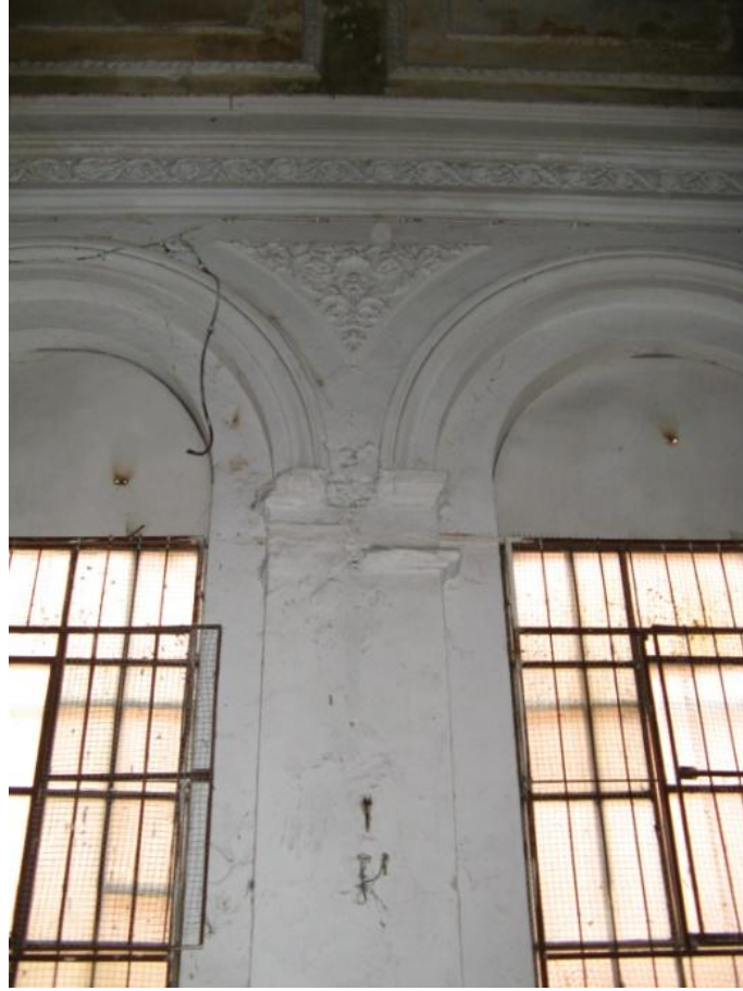
Şekil 3.126: Sahın Mekânındaki pilastr başlıklarında görülen kırıklar.
