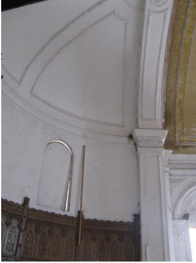
Şekil 3.131: Apsis yarım kubbesi bitiminde ve pencere kemerlerinde görülen strüktürel çatlaklar.
