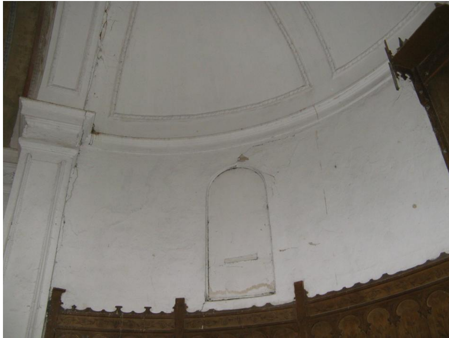
Şekil 3.130: Apsis yarım kubbesi bitiminde ve pencere kemerlerinde görülen strüktürel çatlaklar.
