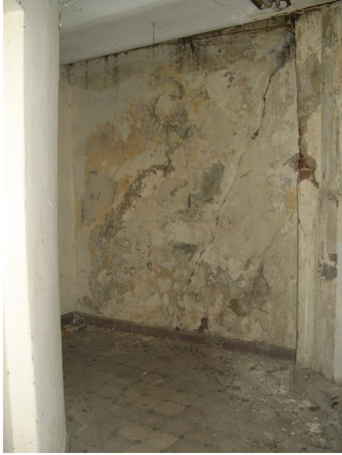
Şekil 3.133: Z-05 Mekânı batı duvarında görülen strüktürel çatlak.
