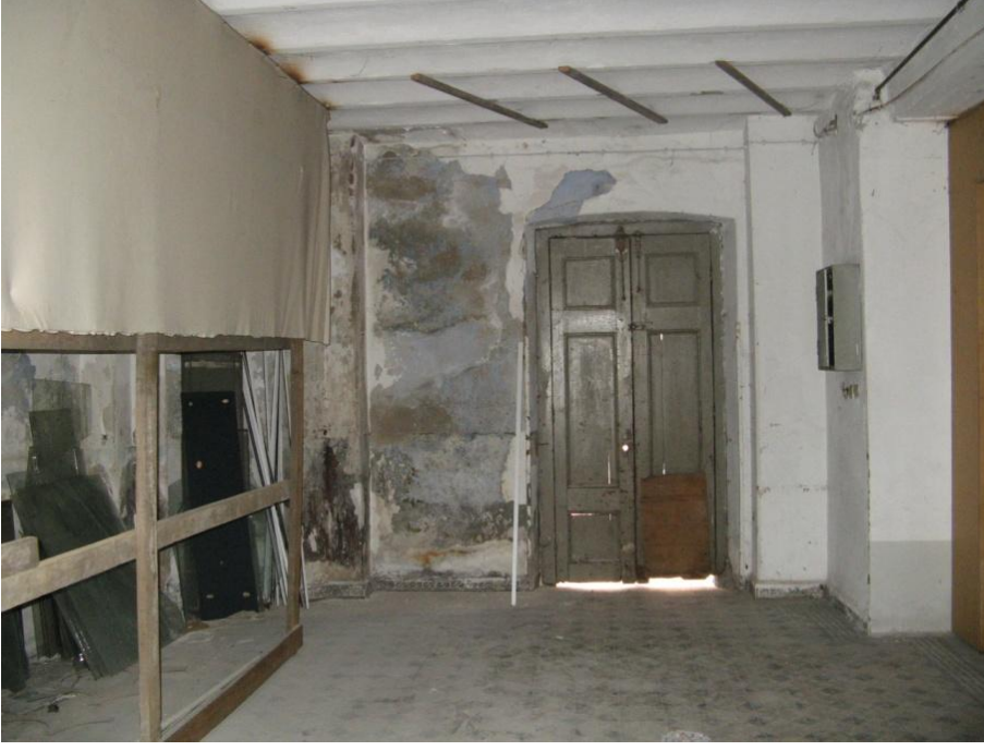
Şekil 3.135: B-01 Mekânı sahne bölümünde görülen rutubete bağlı bozulmalar.
