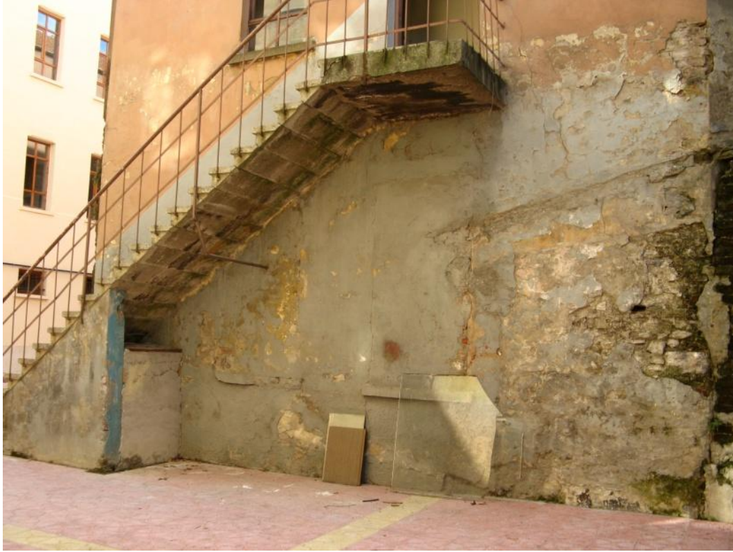
Şekil 3.103: Kuzey cephede yıkılan müştemilat ve kapatılan pencere izleri.
