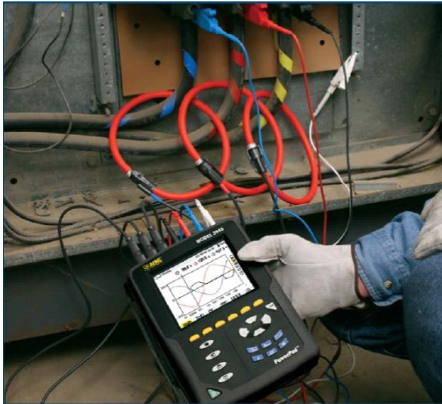
Şekil 4.2 : AEMC 3945 enerji analizörü akım ve gerilim problemlerinin bağlantısı.
