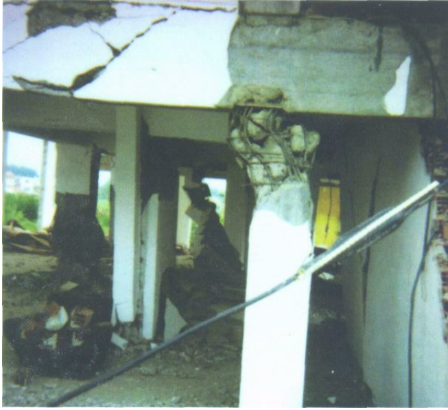
Şekil 19.7 Kolon kiriş birleşim bölgesinde donatı düzenleme hatası
