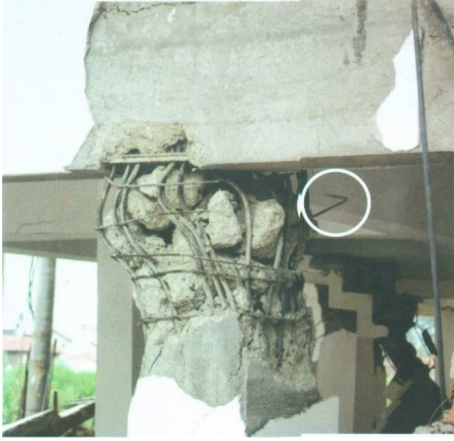
Şekil 19.5 Kolon sarmal bölgesinde deprem etriyelerinin uygun düzenlenmeyiş
