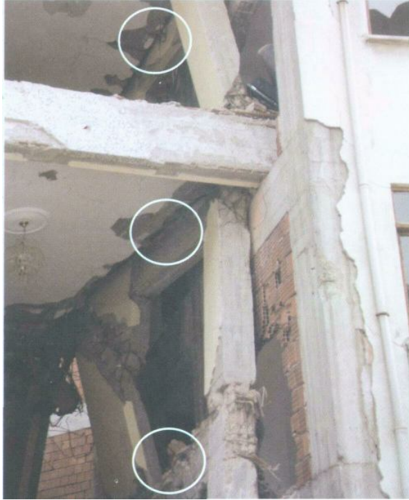
Şekil 19.19 Döşeme donatılarının kiriş içine yeteri kadar sokulmayışının doğurduğu sonuç
