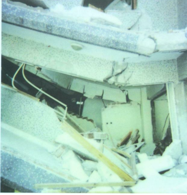
Şekil 19.2 Betonarme kirişte görülen kesme hasarı
