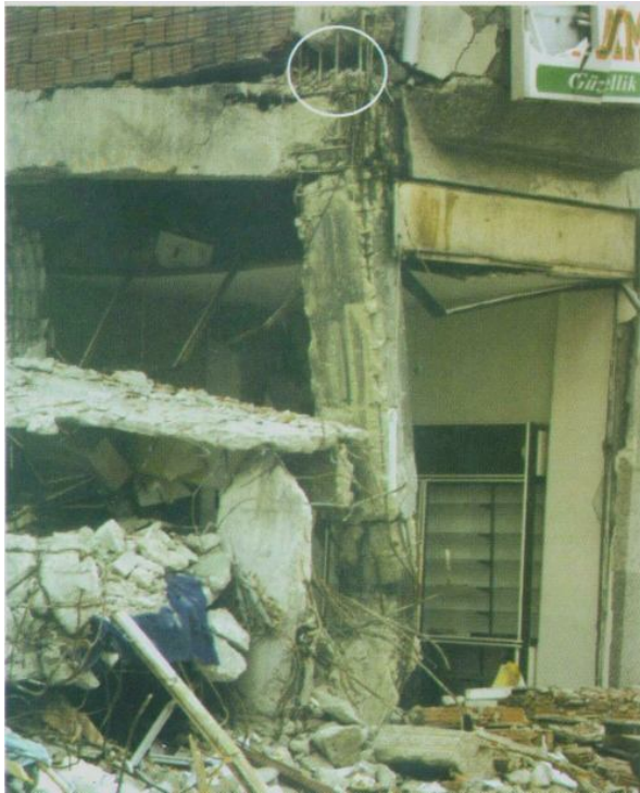
Şekil 19.1 Kolon kiriş birleşim bölgesine ait hasar çeşidi
