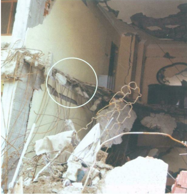
Şekil 19.18 Döşemelerdeki boyuna donatıların kiriş içine uzatılmamasından kaynaklanan hasar
