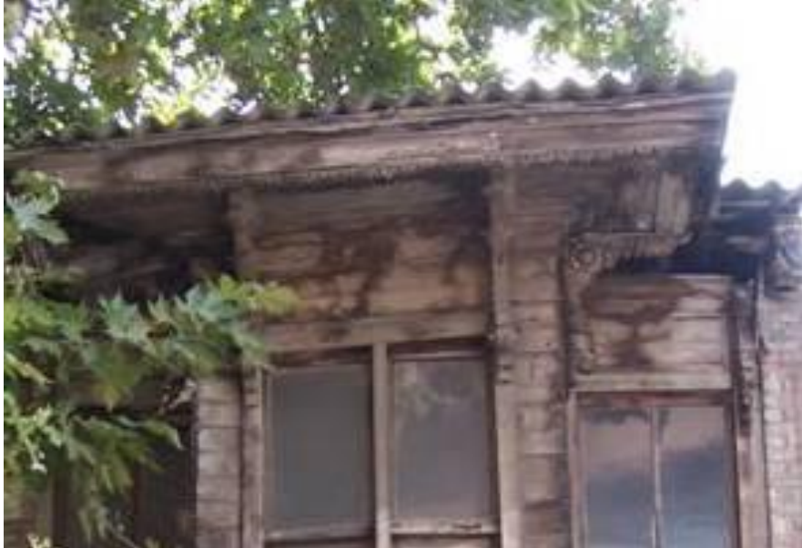
Şekil 4.49 : Kurbağalıdere Caddesi, 34.parselde kullanılmayan yapının furuşları.
