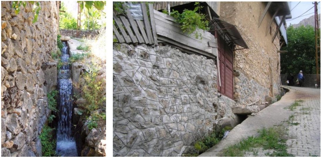
Şekil 5.17: Niteliksiz onarıma maruz kalmış arklar (KAG 2002, Kolektif 2009).
