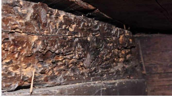
Şekil 6.12 : Ahşapta böcek zararı.
