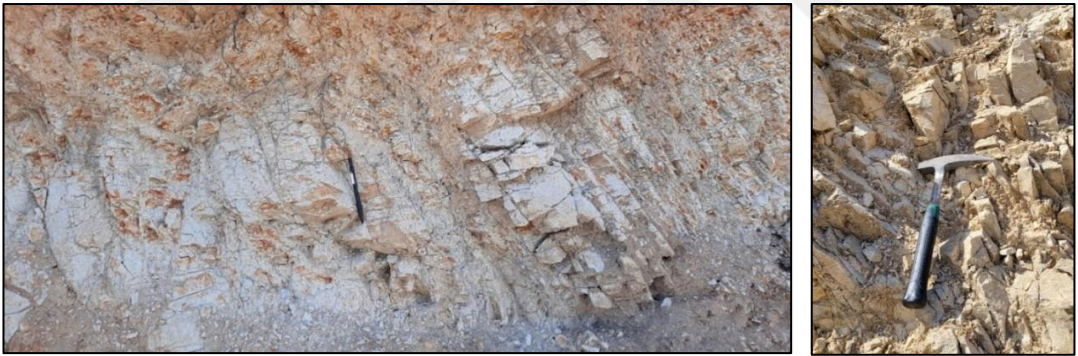
Şekil 2.7 : Metagranitlerin sık çatlaklı mostra görünümü.
