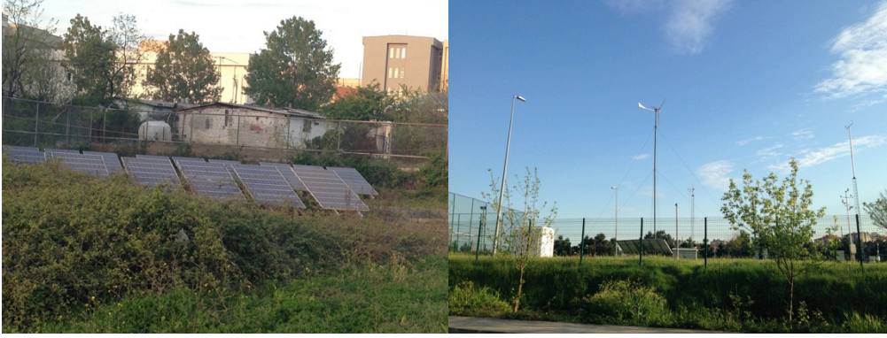
Şekil 5.16: İTÜ Ayazağa Yerleşkesi fotovoltaiik paneller ve rüzgar türbinleri.
