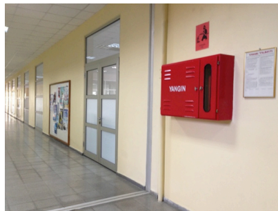
Şekil 5.24: Uçak ve Uzay Bilimleri Fakültesi Yangın söndürme ekipmanları.
